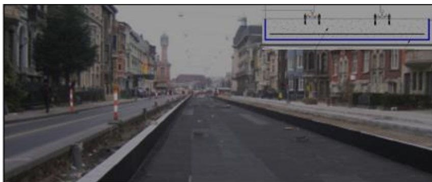
Figura 6.12 – Colocação de uma manta de borracha contínua em via assente em laje [6]
