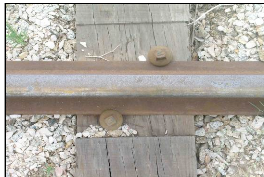
Figura 3.3 - Carril 45 com fixação rígida
