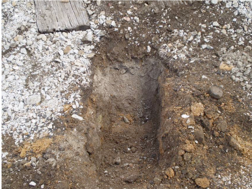
Figura 3.24 - Aspecto do balastro contaminado até à superfície
