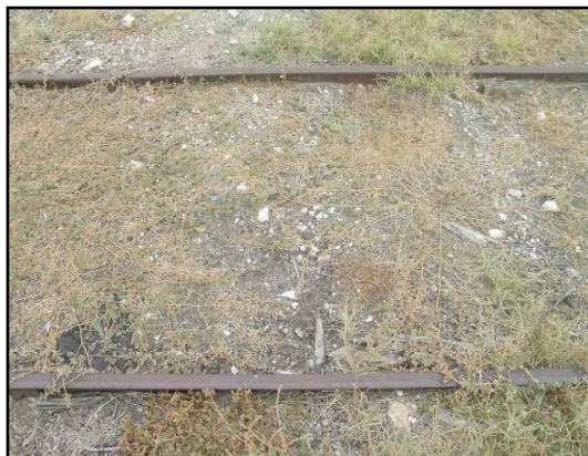
Figura 3.8 - Linha Secundária (Ausência de balastro)
