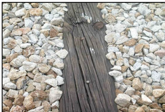
Figura 3.2 - Travessa de madeira fissurada
