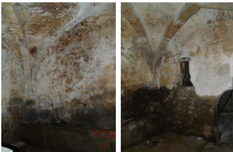
Figura 4.4 - Anomalias provocadas pela humidade proveniente do terreno
