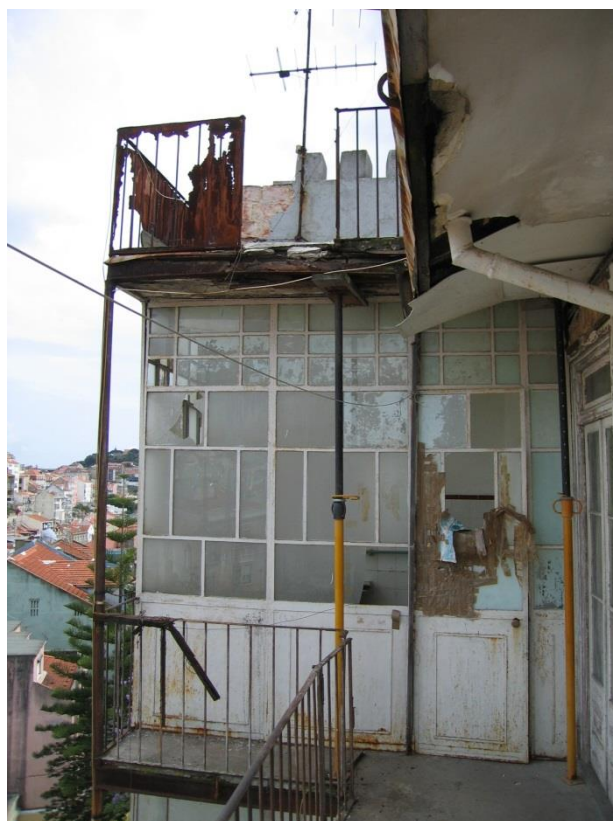
Figura 5.14 - Instalações sanitárias localizadas nas varandas do edifício (Fonte: Atelier Appleton & Domingos)
