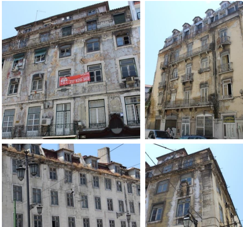
Figura 2.1 - Exemplos de edifícios em mau estado de conservação localizados em zonas antigas de Lisboa
