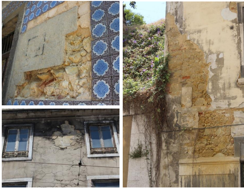
Figura 4.3 - Patologias em fachadas causadas pela humidade de precipitação
