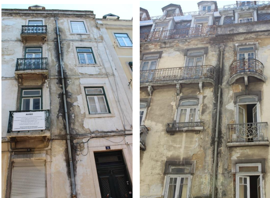
Figura 4.2 - Anomalias causadas pela rotura do tudo de queda
