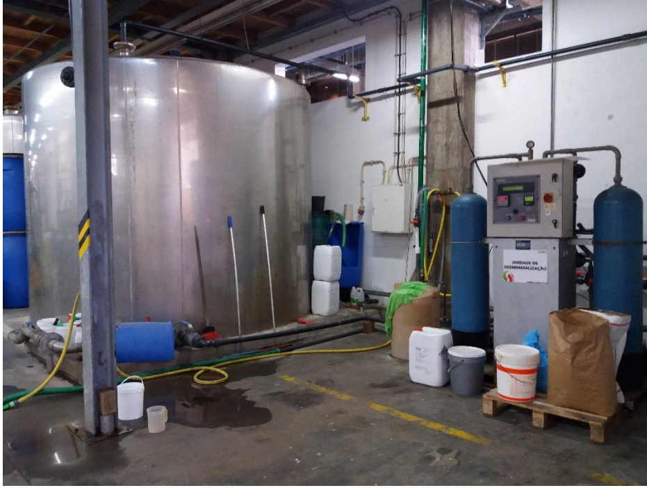
Figura 2.4 - Depósito de água desmineralizada
