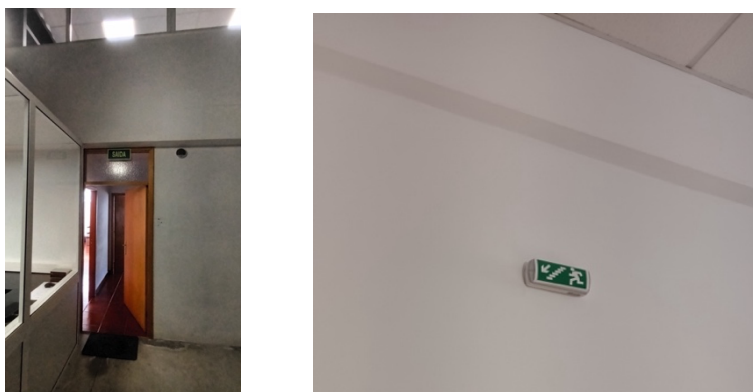
Figura 11 - Inexistência de medidas de autoproteção no âmbito da segurança contra incêndios.
