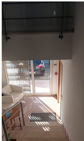
Figura 15 - Inexistência de sinalização que alerte para a existência de um local perigoso: presença de desnível da laje que não se encontram sinalizados.
