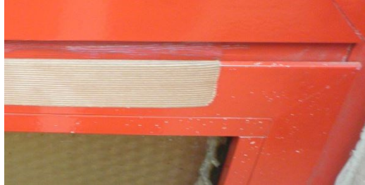
Figura 43 - Folga na junta entre folhas móveis e aro da caixilharia [4].
