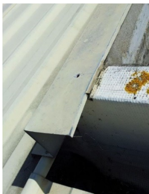
Figura 35 - Corrosão dos elementos de fixação dos rufos [4].
