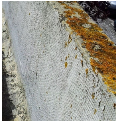
Figura 34 - Fissuração das membranas [4].
