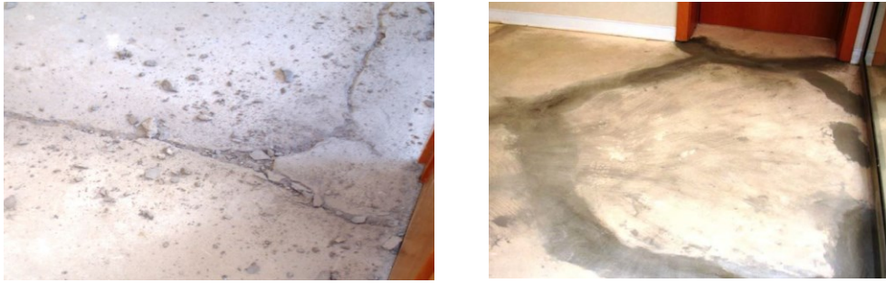
Figura 71 - a) Alargamento das fissuras [31] ; b) Reparação da fissuras com uma argamassa não retrátil [31].
