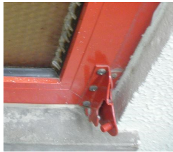
Figura 44 - Dobradiça de abertura danificada [4].
