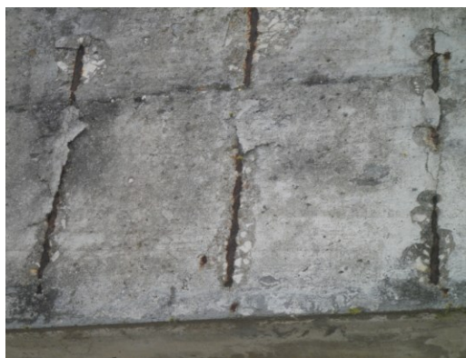
Figura 31 - Patologia de Betão Armado, apresentando a delaminação do betão e corrosão das armaduras [4]
