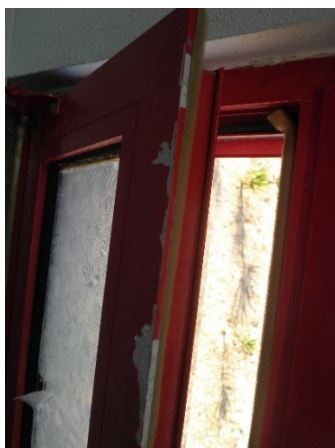
Figura 42 – Descolamento dos materiais vedantes das caixilharias [4].
