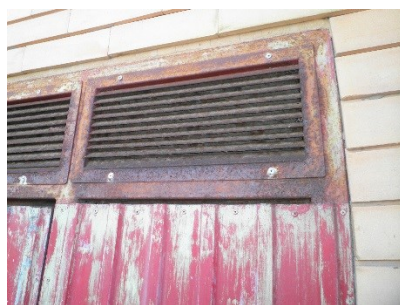
Figura 40 - Pormenor corrosão e descaste da pintura dos portões exteriores [4]
