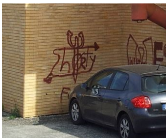
Figura 41 - Grafitti na fachada norte edifício [4].
