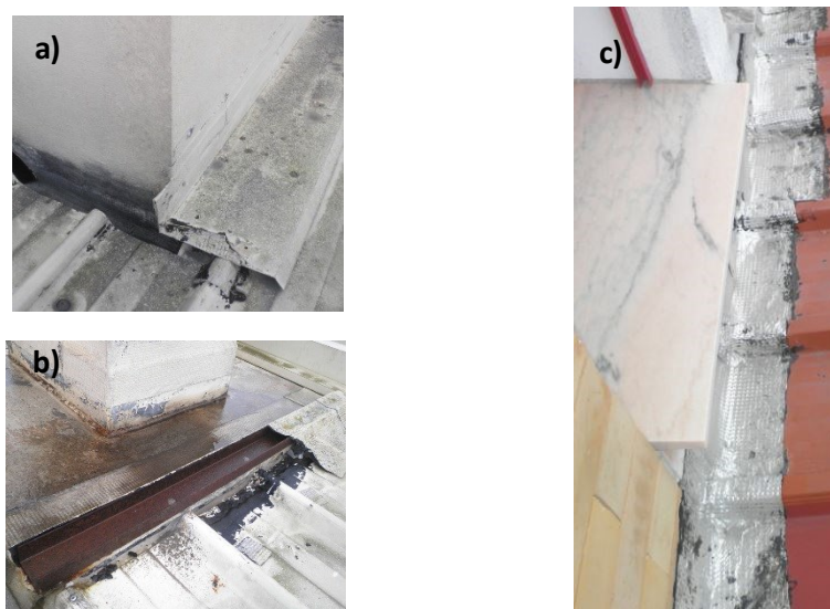
Figura 37 - a) Pormenor dos remates junto aos corpos salientes de ventilação [4] ; b) Remate numa chaminé [4] ; c) Remate das chapas metálicas na parede exterior do 1º piso [4].
