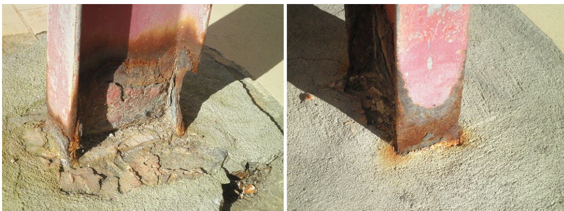
Figura 38 - Pormenor da corrosão na base dos perfis metálicos [4].
