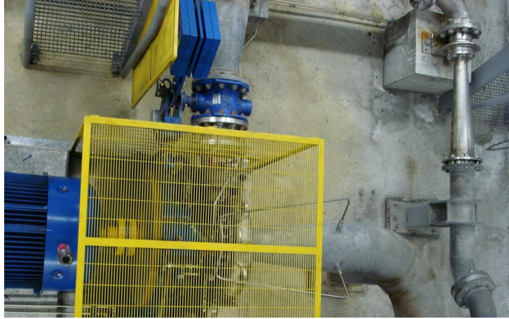
Fig. 8-3 – Turbina Francis e válvula reguladora de pressão em by-pass.
