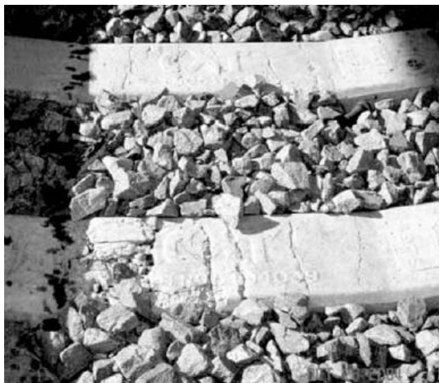
Figura 19 - Rotura das travessas pela existência de elevado momento fletor a meio vão [17]
