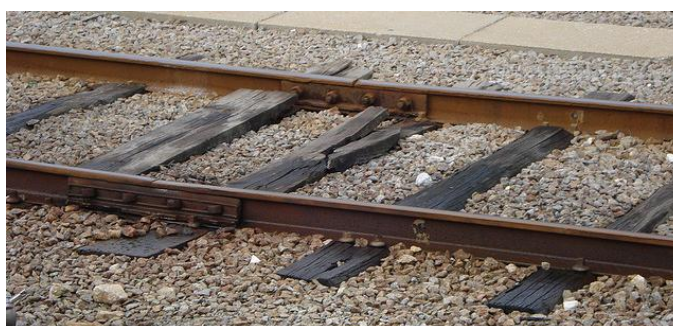
Figura 15 - Degradação das travessas de Madeira [13]
