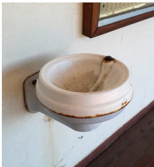
Figura 30- Exemplo de bebedouro existente no ISEL em 2020/2021
