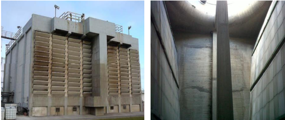
Figura 11 – Vista exterior e interior (durante a construção) de uma torre de fluxo cruzado (Fonte – Material fornecido por ESINDUS S.A.) [5]
