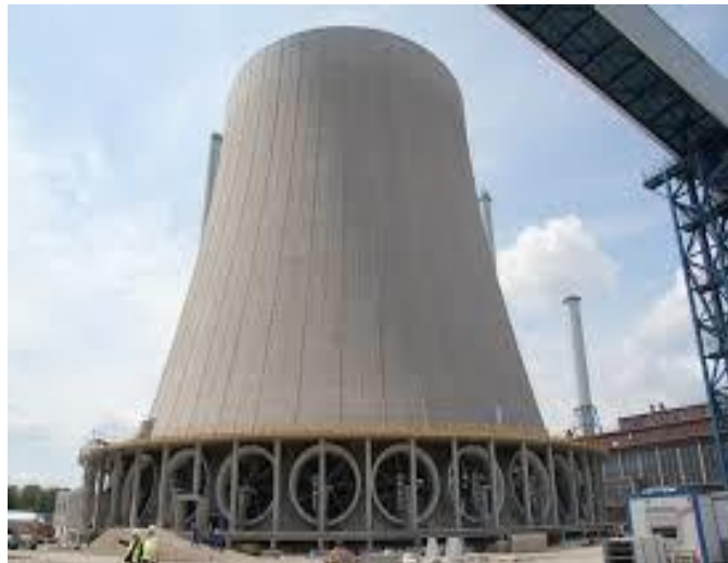
Figura 9 - Torre de arrefecimento de tiragem natural com aspiração assistida
