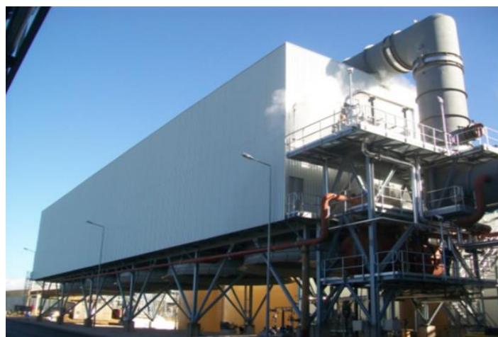
Figura 3 – Torre de arrefecimento evaporativa de contacto directo
