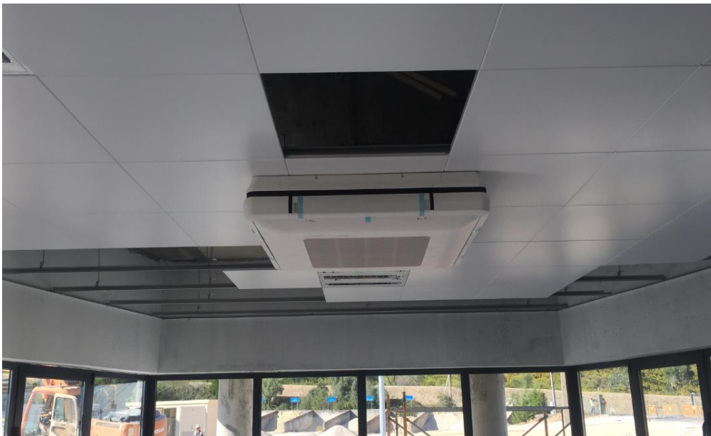
FIGURA 4.21 – AVAC NA PORTARIA
