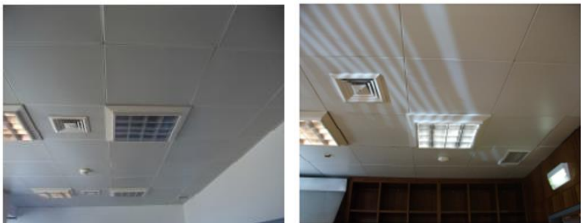
Figura 6 - Difusores de insuflação e grelhas de extração no teto falso
