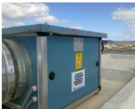
Figura 8 - Ventilador de extração dos WC's (Fonte: Autor).
