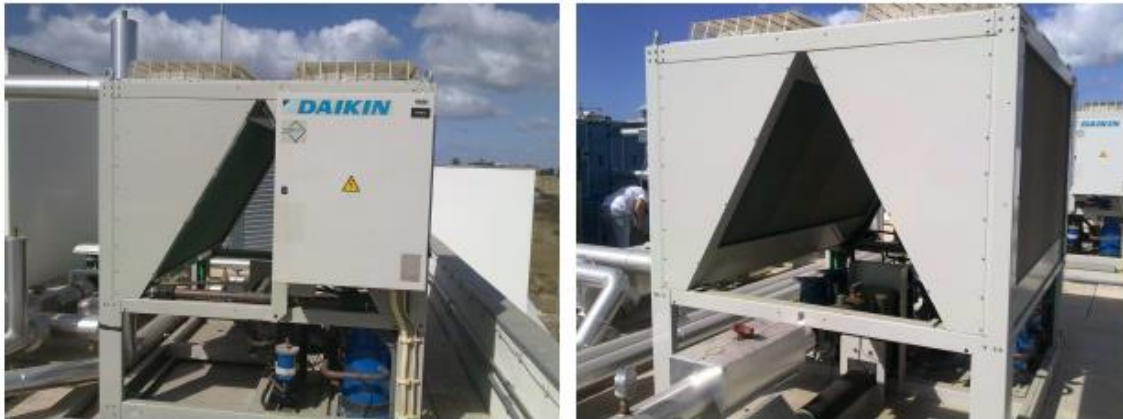
Figura 3 - Localização das Chillers/Bomba (Fonte: Autor).
