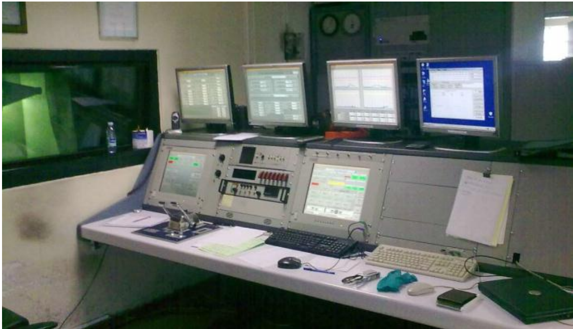
Figura 5.4 – Sala de controlo do banco de ensaio da TAP
