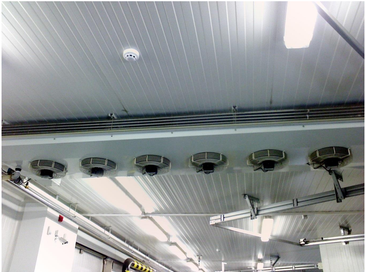
Figura 10 - Evaporador do Cais
