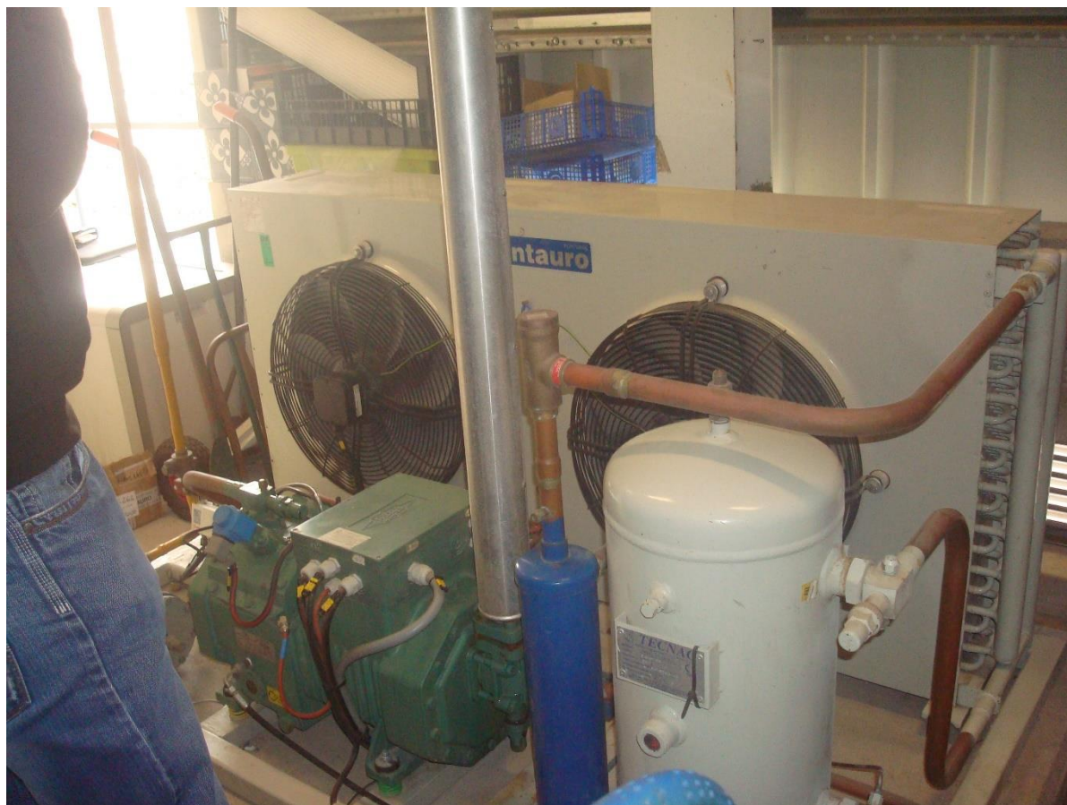
Figura 8 - Circuito frigorífico nº 2
