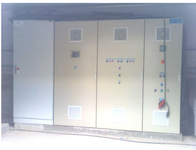
Figura 11 - Quadro elétrico da instalação
