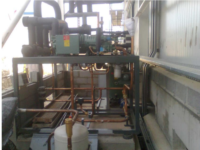
Figura 5 - Central de compressores – Circuito frigorífico nº 1
