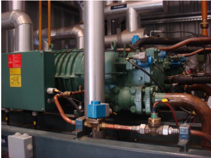
Figura 6 - Compressor refrigerante do circuito nº 1
