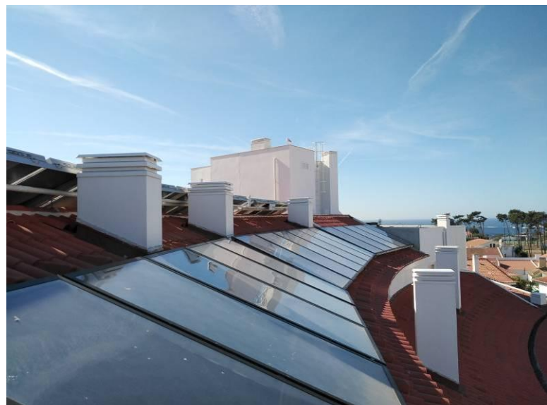
Figura 4.119 - Painéis solares instalados
