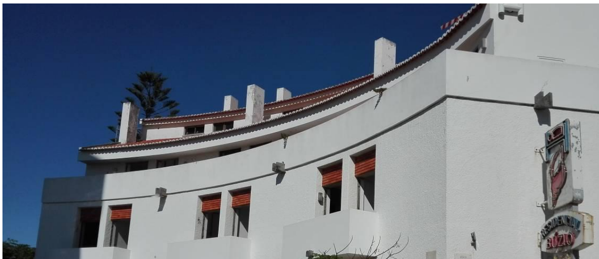
Figura 4.466- Aspecto de gárgulas antes da intervenção
