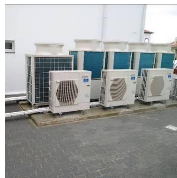
Figura 4.131 - Unidades exteriores na zona técnica exterior
