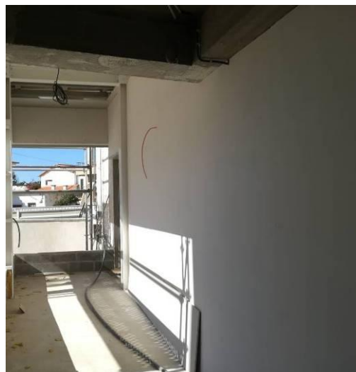
Figura 3.161 - Execução das paredes entre a torre de elevador e o edifício existente – barramento de placa de gesso cartonado
