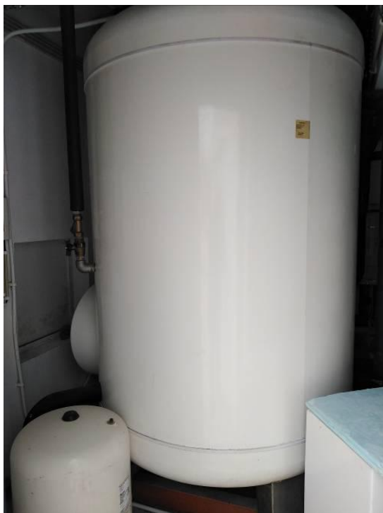
Figura 4.120- Depósitos de apoio ao sistema AQS
