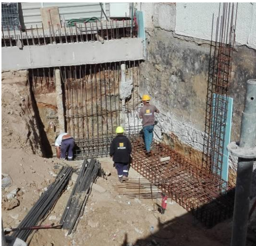
Figura 3.40 - Execução do muro de suporte de forma faseada e das fundações do piso -1
