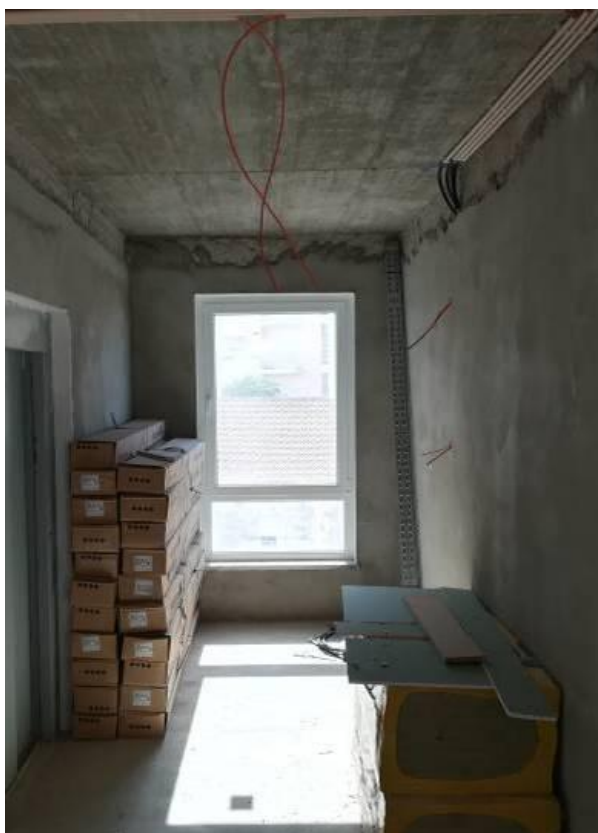
Figura 3.124 - Detectores de incêndio no tecto e iluminação de emergência – passagem de cabos
