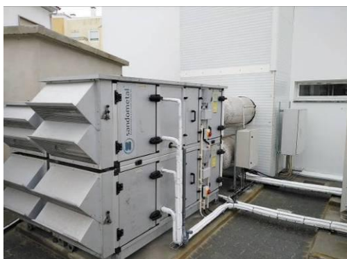
Figura 4.130 - Unidades exteriores na zona técnica exterior
