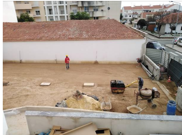
Figura 5.44 - Aterro e compactação do terreno para atingir cotas de trabalho no parque de estacionamento
