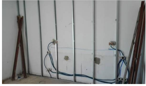
Figura 4.99 - Passagem de tubagem para instalações eléctricas e ITED
