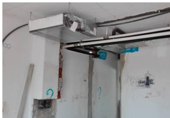
Figura 4.114 - Tubagem em sistema em multicamada (tipo de instalação para distribuição entre pisos até aos quartos)
