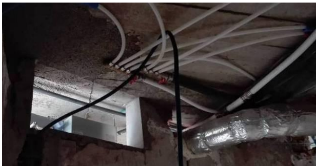
Figura 4.115 - Colectores de sistema Pex (tipo de instalação dentro dos quartos) – execução da rede de águas
