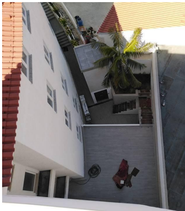
Figura 4.440 - Aspecto final de escadas de acesso e cobertura da zona de ampliação
