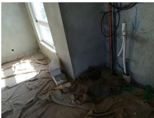
Figura 3.118 - Sistema de AVAC – equipamento de pavimento no piso 0
