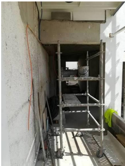
Figura 3.158 - Execução das paredes entre a torre de elevador e o edifício existente – preparação e passagem de especialidades
