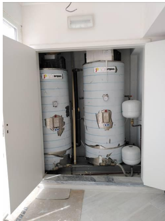
Figura 4.121 - Depósitos de apoio ao sistema AQS
