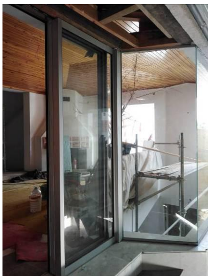
Figura 4.55 - Aspecto final do painel envidraçado e da porta de vidro visto pelo exterior
