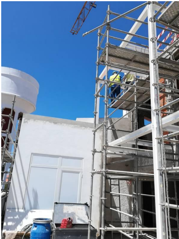
Figura 4.222 - Ampliação do piso 2 e 3 no alçado sudoeste - montagem de pilares e vigas
