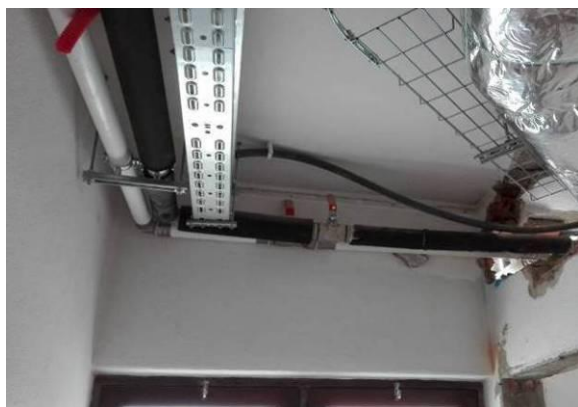
Figura 4.113 - Tubagem em sistema em multicamada (tipo de instalação para distribuição entre pisos até aos quartos)
