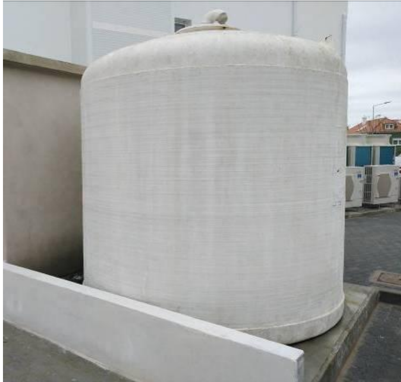
Figura 4.117 - Depósito instalado no exterior
