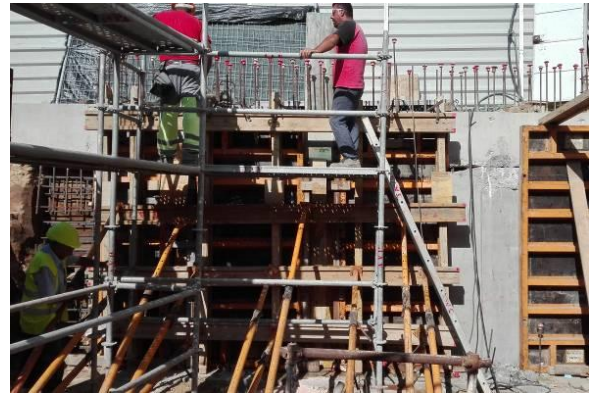
Figura 3.46 - Execução do muro de suporte de forma faseada e fundações do piso -1
