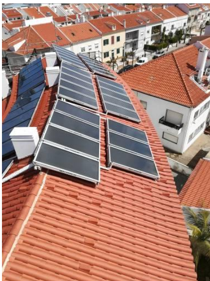
Figura 4.118 - Painéis solares instalados
