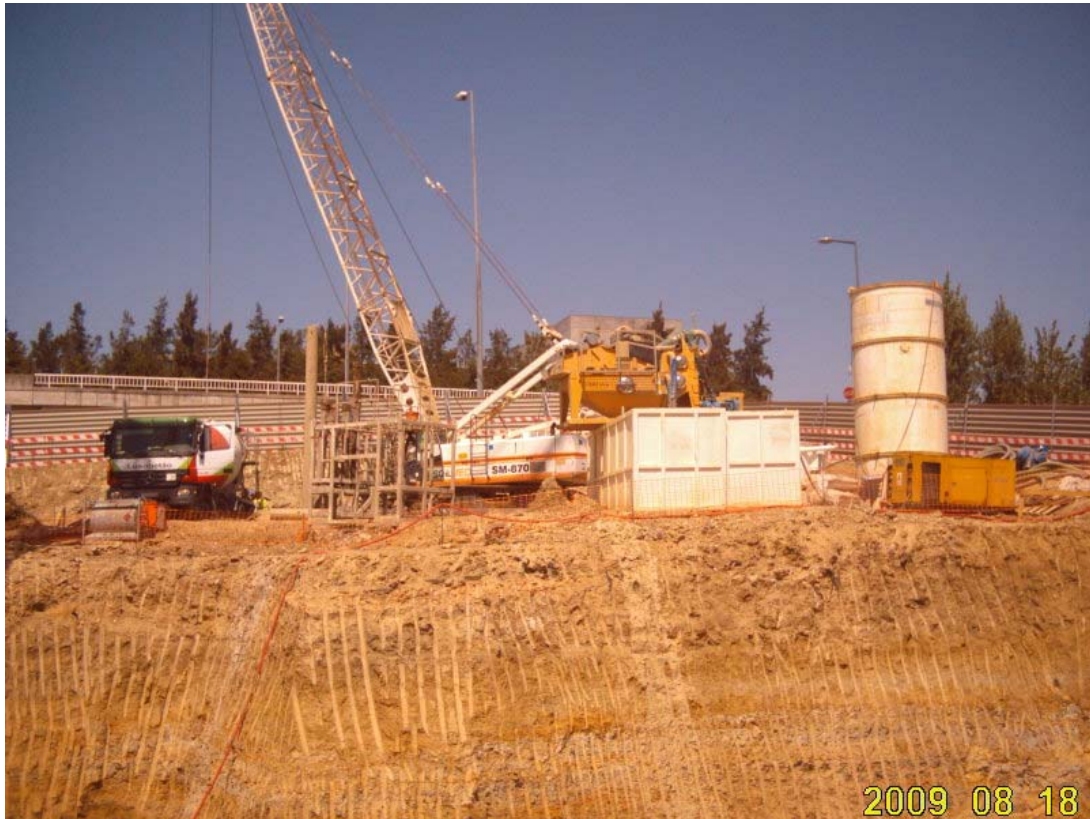
Fotografia 12 – Central de produção de bentonite
