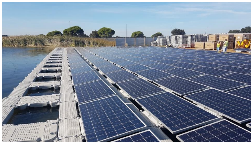
Figura 2 – Estrutura flutuante da instalação fotovoltaica flutuante do Alqueva
