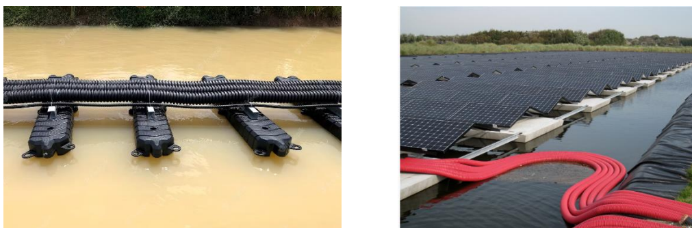
Figura 3 – Exemplos de cabos elétricos de sistemas fotovoltaicos flutuantes
