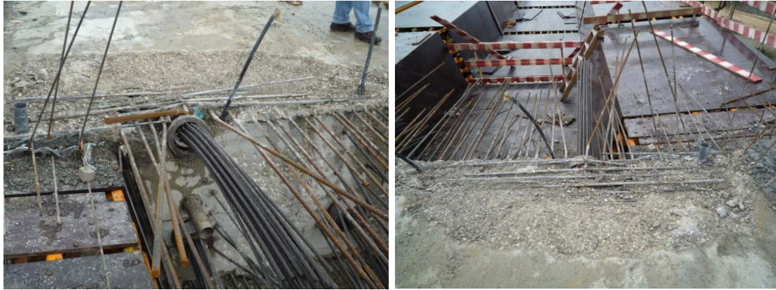
Figura 124 e 125: Rebentamento do betão durante a aplicação do pré-esforço
