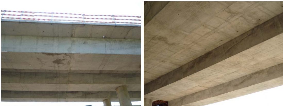
Figura 120 e 121: Juntas de betonagem entre tramos (à esquerda) e juntas criadas pela betonagem faseada (à direita)
