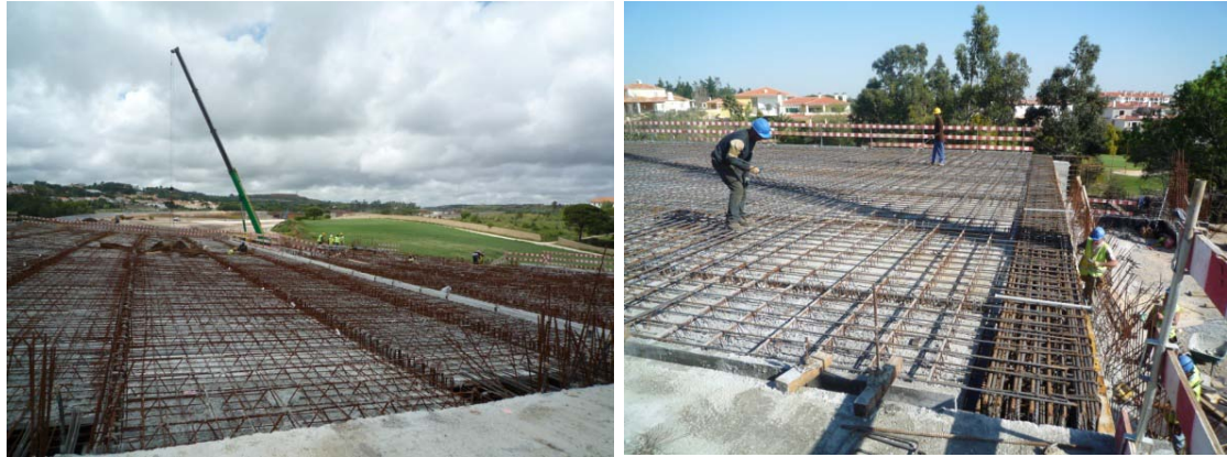
Figura 54 e 55: Pré-lajes com treliças do Viaduto do Telhal e da Passagem Inferior Pontão
