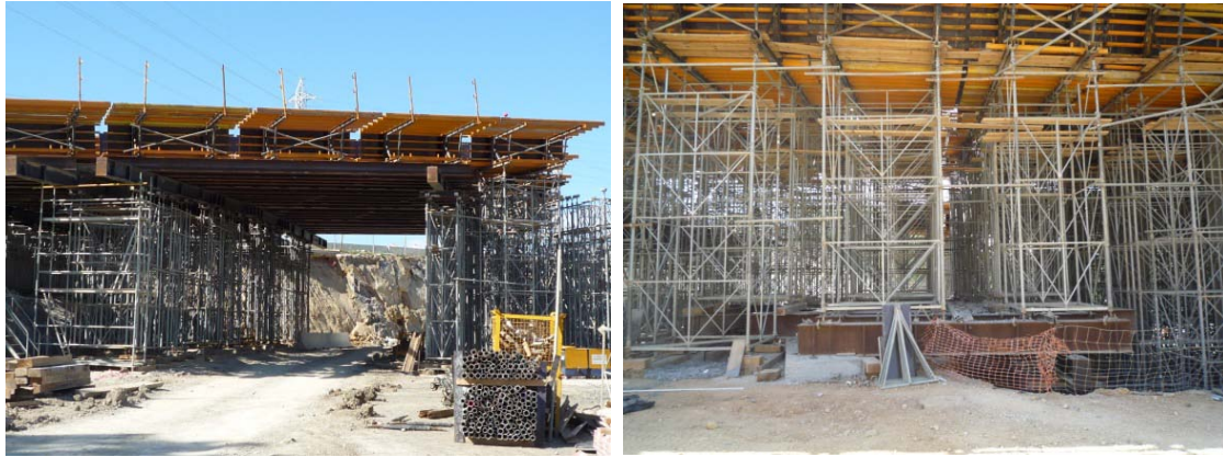
Figura 67 e 68: Estrutura porticada para passagem de obra na PS7 e para vencer taludes no Viaduto do Molhapão
