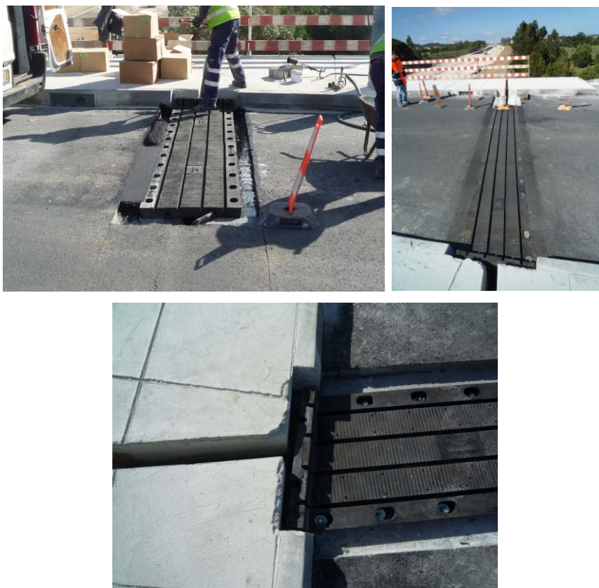
Figura 109, 110 e 111: Juntas de dilatação de neoprene armado
