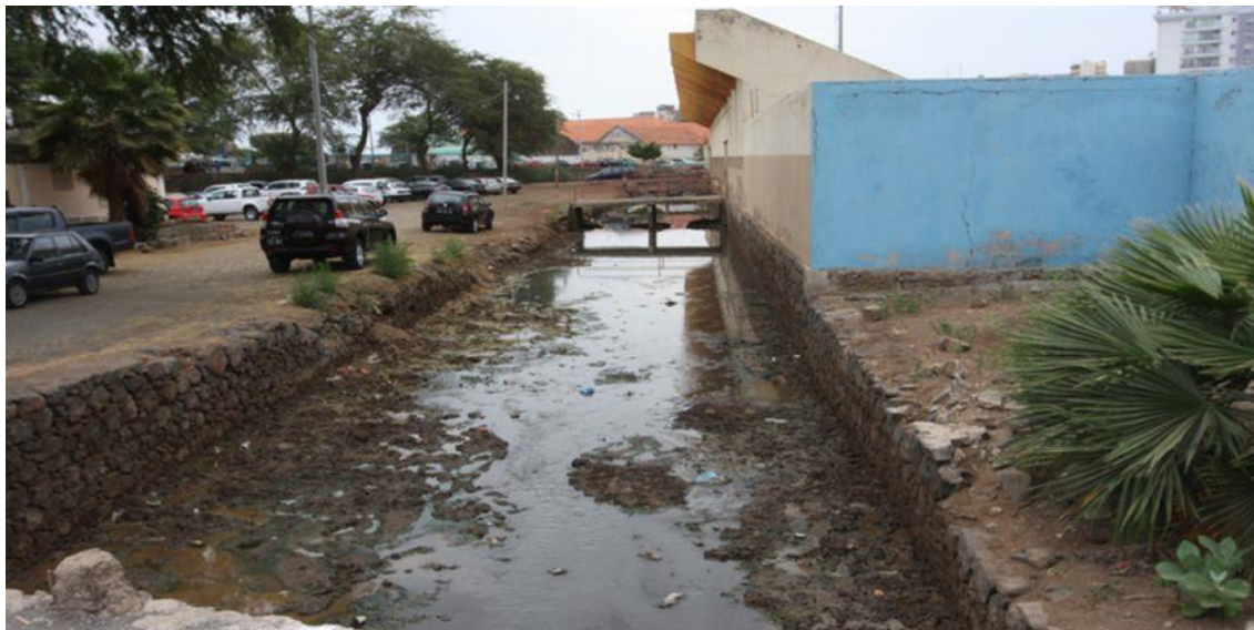
Figura nº 3 – Imagem ilustrativa da água que se verifica nas imediações do Estádio Municipal (Cidade da Praia).
