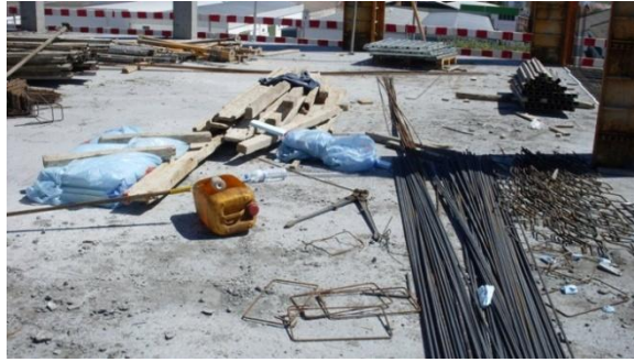
Fig. 264 - Deficiente arrumação do local de trabalho.
