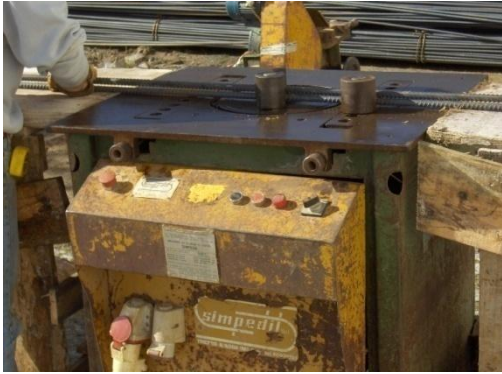
Fig.76 Máquina de dobrar varões de aço e adiante está a de cortar
