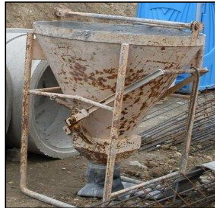
Fig.56 : Balde de 500 L da grua torre
