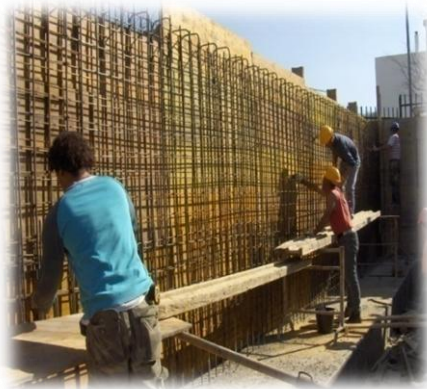
Fig. 255 - Um dos trabalhadores não usa o capacete de protecção Individual
