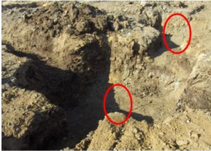
Fig.268 - Varões de aço pontiagudos de marcação do eixo dos pilares e sem carapuça sinalizadora, também designado por “cogumelo”. Risco de Morte provocada por queda em altura.
