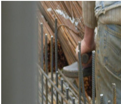
Fig. 258 – O trabalhador não usa luvas de protecção
