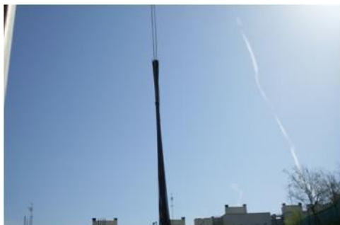
Fig. 267 - Má execução na elevação de cargas. Risco de queda de material, neste caso varões de aço. Os atados dos varões devem ser elevados em posição horizontal com dois pontos de suspensão e não na vertical com apenas um
