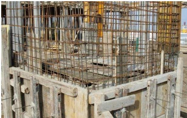
Fig. 199 - Cofragens da parede maciça. Pormenor do uso de esticadores como elementos de fixação
