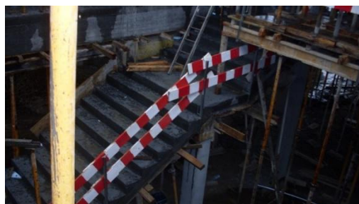
Fig. 239 – Guardas de Protecção em Escadas
