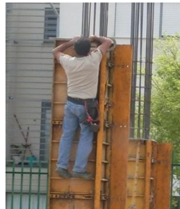
Fig. 259 – Acto incorrecto: Trabalhador em cima da cofragem de um pilar sem qualquer tipo de protecção individual nem amparo.
