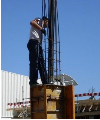
Fig. 254 – Acto incorrecto: O trabalhador está em cima da cofragem do pilar e amparado às armaduras
