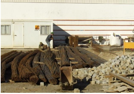
Fig.95 - Zona de depósito de varões de aço e de Corte e dobragem
