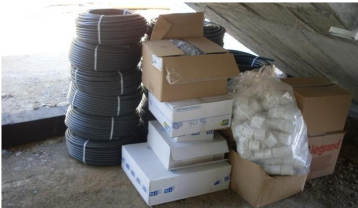
Figura 33 – tubagens de PVC, caixas de aparelhagem e derivação, tomadas e acessórios de instalações eléctricas
