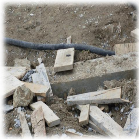
Fig. 261 – Deficiente limpeza do local de trabalho. Nesta situação existe perigo de electrocussão, pois pode haver esmagamento e corte do cabo eléctrico por movimentação de máquinas.
