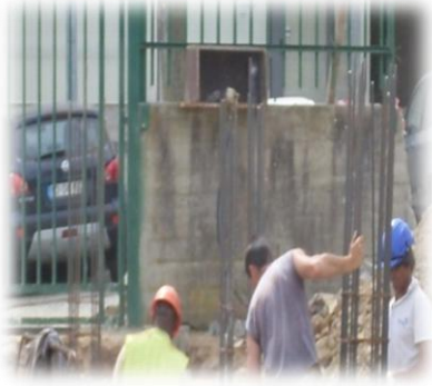
Fig. 256 - Um dos trabalhadores não usa o capacete de protecção Individual
