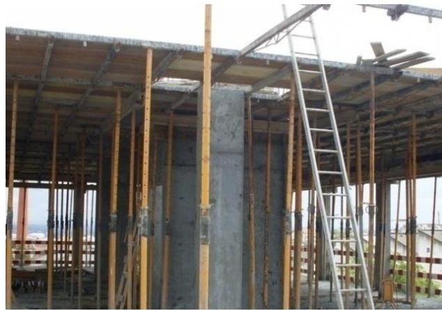
Fig.83 Tábuas de madeira, prumos extensíveis e vigas de aço para cofragem de uma laje
