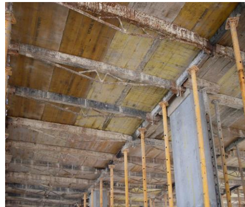
Figura 28 - Prumos metálicos ajustáveis em altura (extensores) e vigas metálicas extensíveis, tábuas de solho
