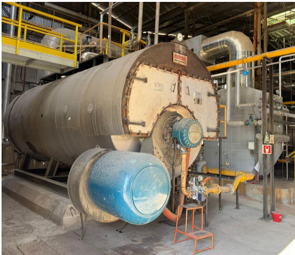
Figura 13 - Caldeira flamotubular presente na central de vapor da ADP fertilizantes.
