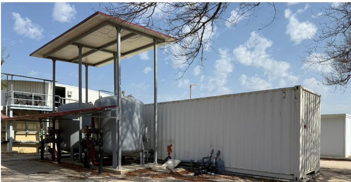
Figura 5 - Primeira unidade de osmose inversa da UFAA.
