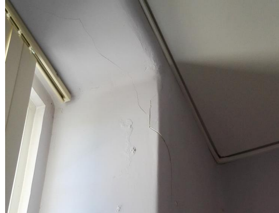
Figura 5-10 - Fissura à janela do quarto 47 do piso 0 [FONTE: Autor]
