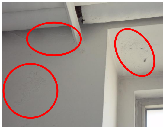
Figura 5-21 – Criptoflorescências na casa de banho 35 do piso 1 [FONTE: Autor]
