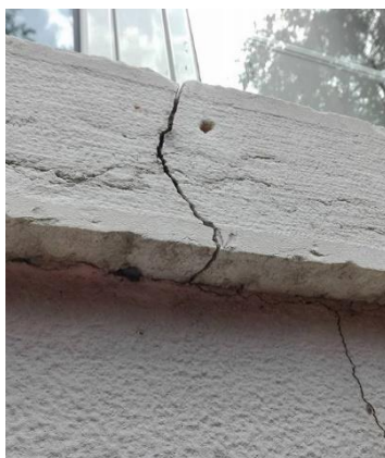
Figura 5-47 – Fissura no peitoril do quarto 47 vista pelo exterior. [FONTE: Autor]
