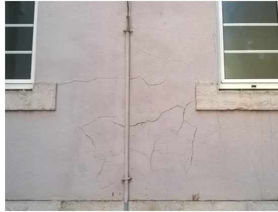
Figura 5-5 – Fissuras no paramento exterior das paredes do WC 15 e Quarto 16 [FONTE: Autor]
