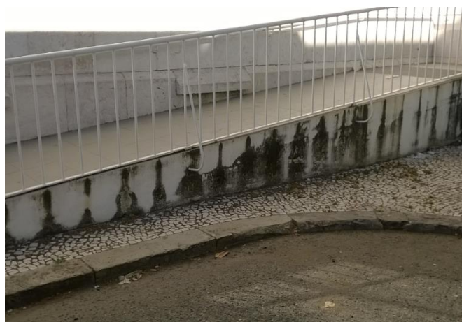
Figura 5-30 - Escorrências e manchas na rampa de acesso. [FONTE: Autor]
