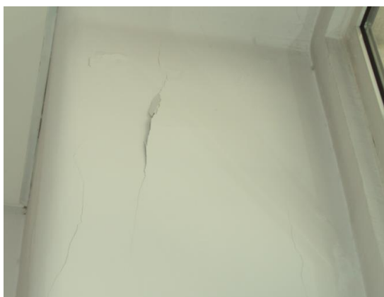
Figura 5-27 – Empolamento no vão da janela do corredor 33 do Piso 0. [FONTE: Autor]
