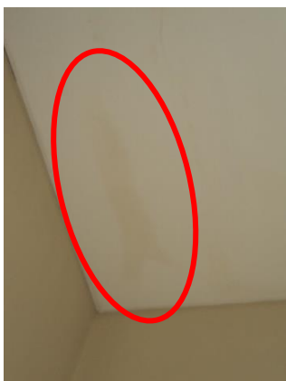
Figura 5-18 - Manchas de Humidade no quarto 16, piso 0 [FONTE: Autor]
