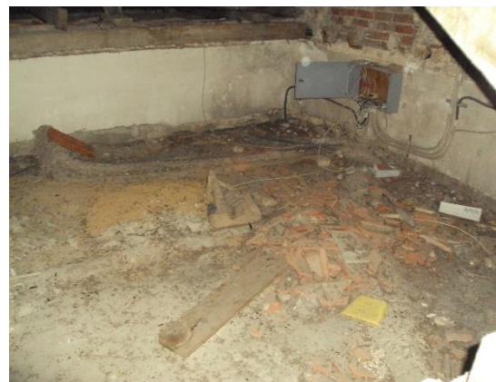
Figura 5-66 – Existência de entulhos na cobertura. [FONTE: Autor]
