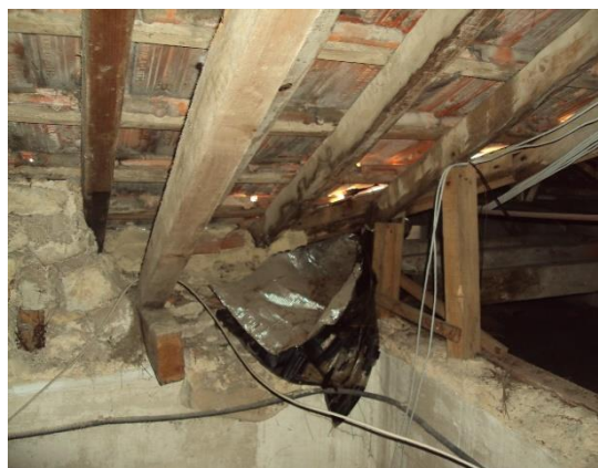
Figura 5-68 – Possível problema de infiltração de água das chuvas. [FONTE: Autor].
