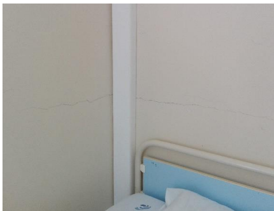
Figura 5-6 – Fissura no quarto 17 do piso 0 [FONTE: Autor]
