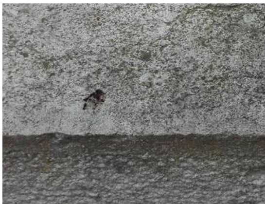
Figura 5-42 - Manchas na cantaria exterior [FONTE: Autor]
