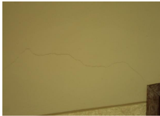
Figura 5-16 - Fissura no reboco na junta da porta da sala 34, piso 1 [FONTE: Autor]
