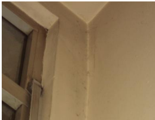
Figura 5-17 – Manchas de humidade na sala 1, piso 1 [FONTE: Autor]
