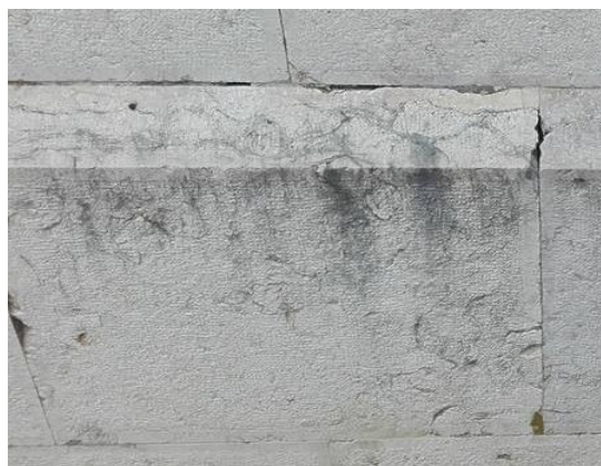
Figura 5-43 – Manchas, desgaste e fissuras na cantaria exterior. [FONTE: Autor]
