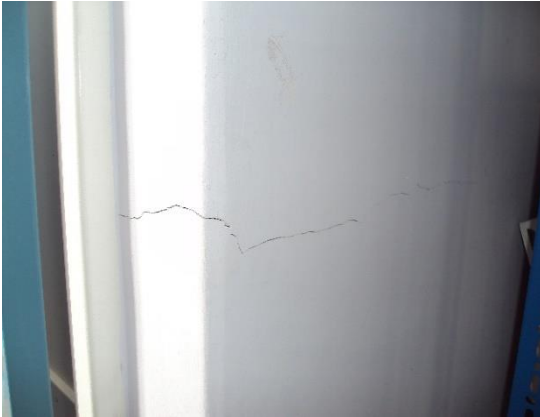
Figura 5-9 – Fissuração junto à entrada do quarto 47 piso 0 [FONTE: Autor]
