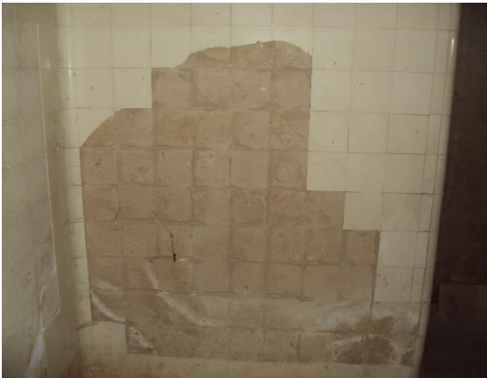
Figura 5-71 – Destacamento de elementos cerâmicos. [FONTE: Autor]
