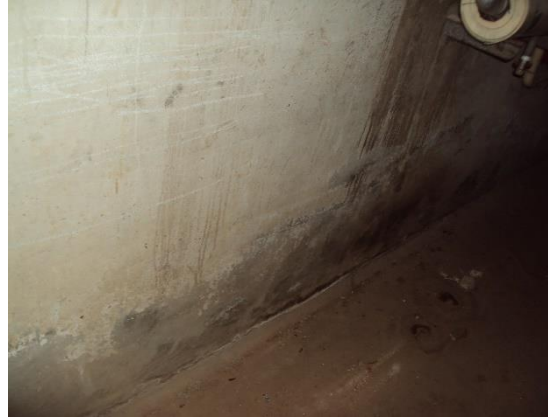
Figura 5-70 – Humidades ascendentes por capilaridade na cave. [FONTE: Autor]
