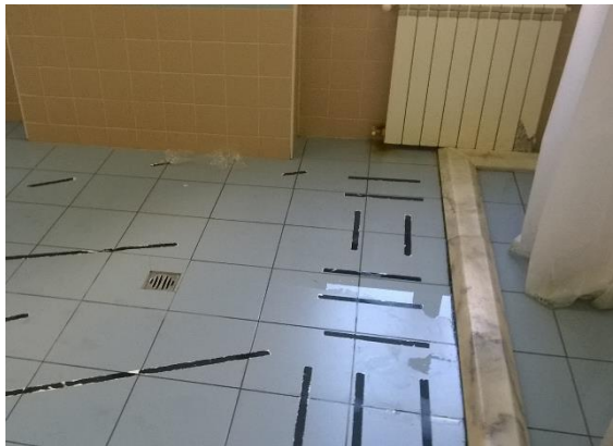
Figura 5-41 – Problemas de escoamento na casa de banho 15 do piso 0 [FONTE: Autor]
