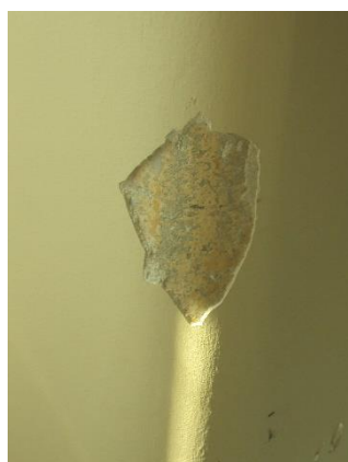
Figura 5-33 – Destacamento no quarto 19 piso 0 [FONTE: Autor]
