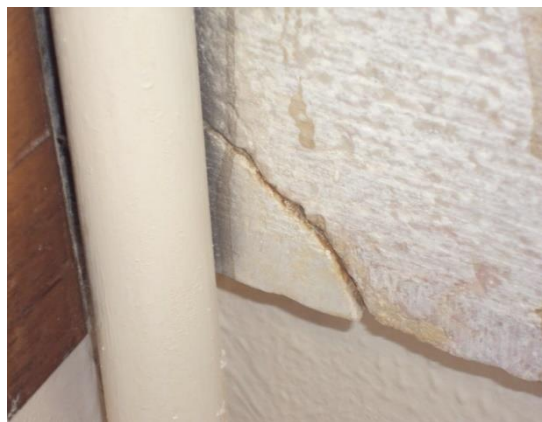
Figura 5-46 – Fratura na cantaria do quarto 2 do piso 1 [FONTE: Autor]
