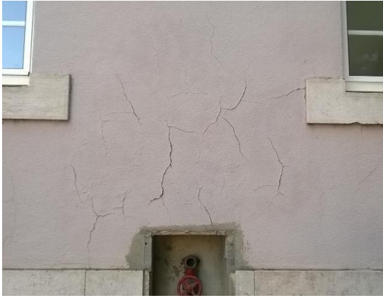
Figura 5-4 -Fissuras no paramento exterior das paredes do WC 15 [FONTE: Autor]
