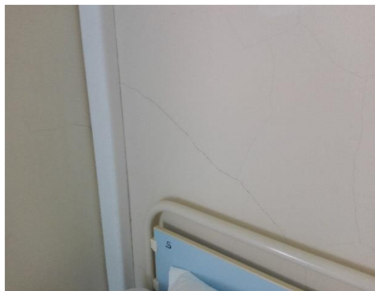
Figura 5-8 – Fissura no quarto 18 do piso 0 [FONTE: Autor]
