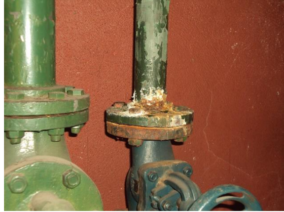
Figura 5-74 – Degradação das canalizações da caldeira. [Fonte: Autor]
