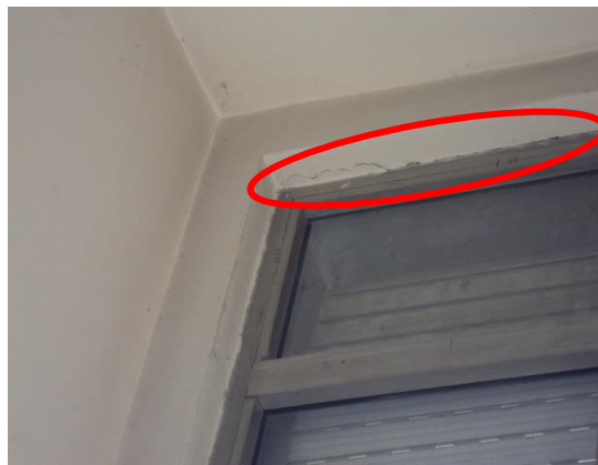
Figura 5-11 – Fissuração em redor da caixilharia do quarto 31 do piso 1 [FONTE: Autor]
