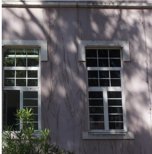
Figura 5-35 - Vestígios de trepadeiras nas fachadas [FONTE: Autor]
