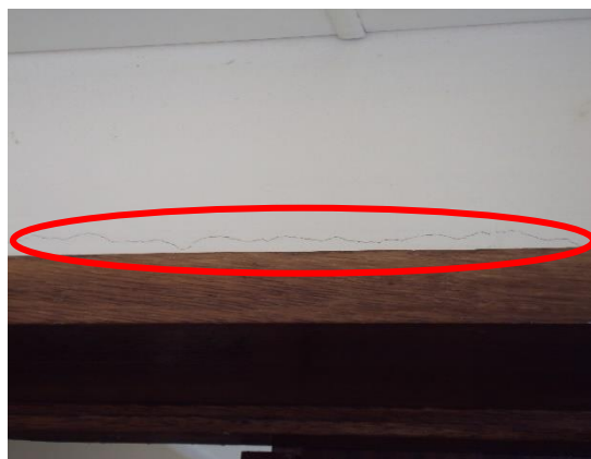
Figura 5-13 - Fissura porta da sala de estar 2 do piso 1 [FONTE: Autor]
