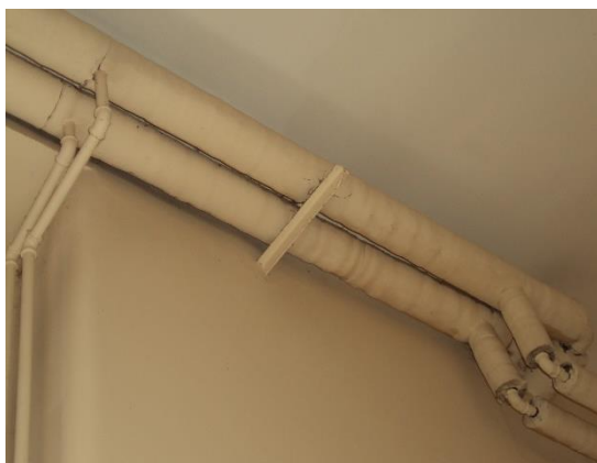
Figura 4-16 - Canalizações de água quente no piso 1. [FONTE: Autor]
