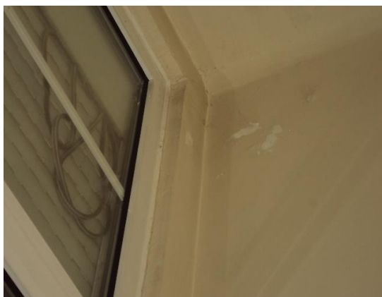
Figura 5-28 - Empolamento no quarto 19 do Piso 0 [FONTE: Autor]
