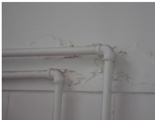
Figura 5-26 – Destacamento de tinta na casa de banho 35, piso 1 [FONTE: Autor]
