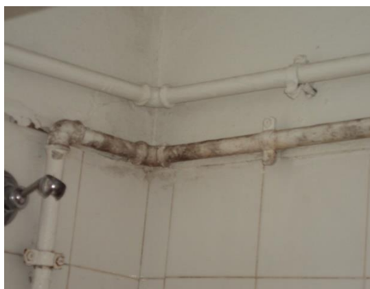
Figura 5-58 – Sujidade da tinta nas canalizações das casas de banho. [FONTE: Autor]
