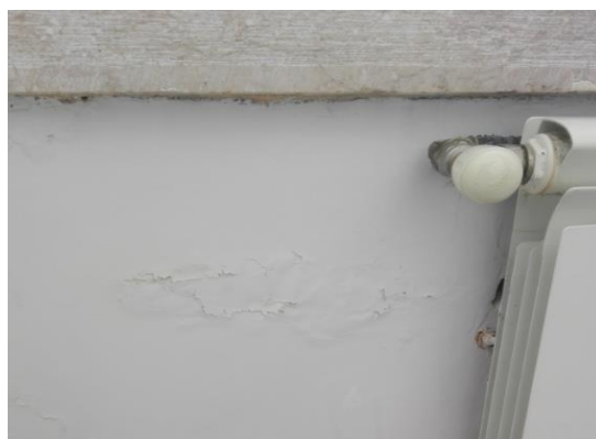
Figura 5-23 - Criptoflorescências na zona inferior da janela do corredor 33, piso 0. [FONTE: Autor]
