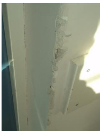
Figura 5-32 – Destacamento no corredor 4 piso 0 [FONTE: Autor]
