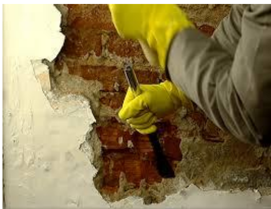
Figura 6-45 - Picagem do reboco degradado na cave. [53]
