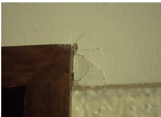
Figura 5-15 – Fissura no reboco na junta da porta do refeitório 1, piso 1 [FONTE: Autor]
