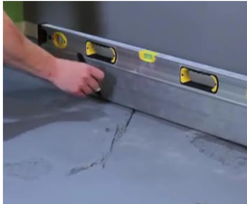
Figura 6-30 - Verificação de irregularidades do pavimento. [40]
