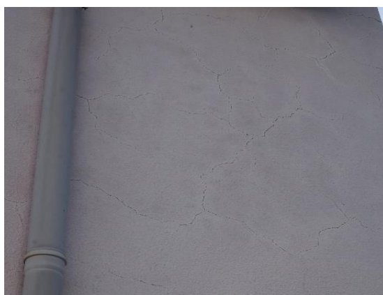
Figura 5-3 – Fendilhação do revestimento nas fachadas. [FONTE: Autor]
