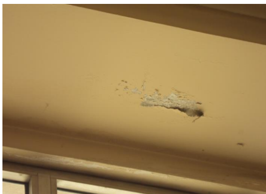
Figura 5-22 - Criptoflorescências na face superior do vão das janelas do corredor 4, piso 1. [FONTE: Autor]
