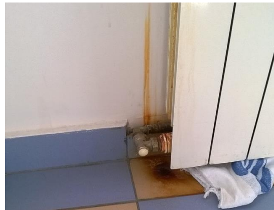
Figura 5-57 – Manchas de oxidação nas paredes do corredor 4 do piso 0. [FONTE: Autor]
