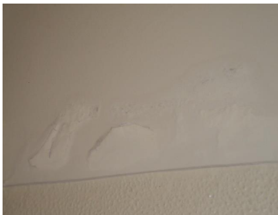
Figura 5-25 – Empolamento no Quarto 31 do piso 1 [FONTE: Autor]
