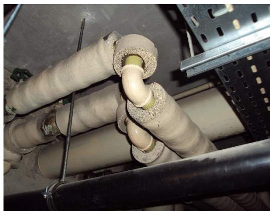
Figura 4-17 - Canalizações de água quente na cave. [FONTE: Autor]
