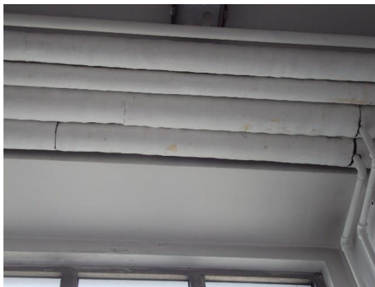
Figura 5-59 - Envelhecimento do material do revestimento das canalizações na casa de banho 15 do piso 1 [FONTE: Autor]
