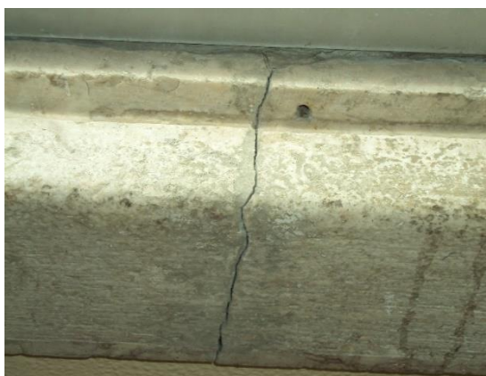
Figura 5-45 – Fissura no peitoril do quarto 31 do piso 1 [FONTE: Autor]
