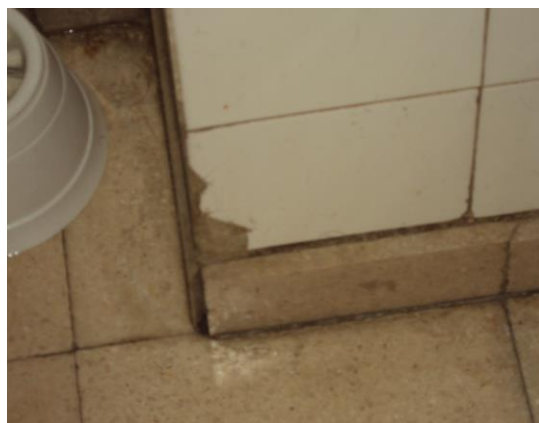
Figura 5-37 - Rotura do elemento na casa de banho 3 do piso 1 [FONTE: Autor]
