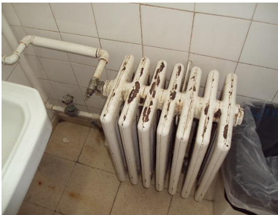
Figura 5-56 – Oxidação dos radiadores das casas de banho. [FONTE: Autor]
