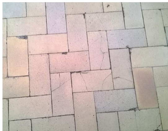
Figura 5-39 - Fraturas e desgaste do pavimento do piso 1 [FONTE: Autor]
