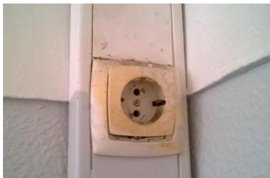
Figura 5-62 - Tomada danificada na sala de espera 7 do piso 1. [FONTE: Autor]
