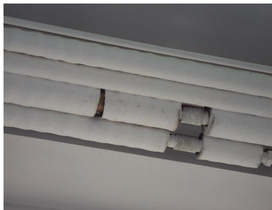
Figura 5-60 - Envelhecimento do material do revestimento das canalizações na casa de banho 3 do piso 1 [FONTE: Autor]
