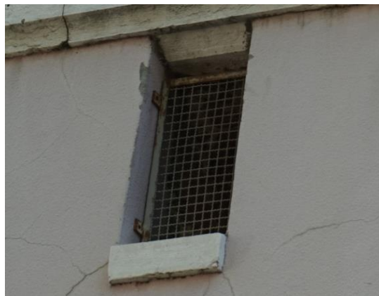
Figura 5-55 – Oxidação das grades exteriores do edifício. [FONTE: Autor]
