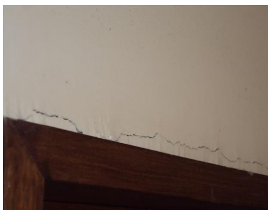
Figura 5-14 - Fissura na porta da casa de banho 5 piso 1 [FONTE: Autor]
