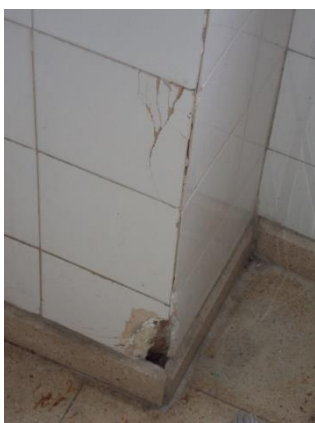
Figura 5-36 - Patologias dos elementos cerâmicos na casa de banho 36 Piso 1 [FONTE: Autor]
