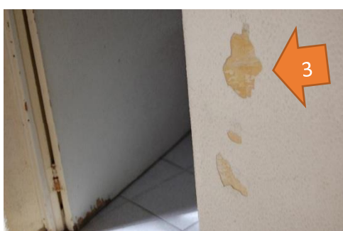
Figura 60. Destacamento do revestimento em no corredor 34, 1ºAndar [Fonte: Autora, Data: 30-05-2016]
