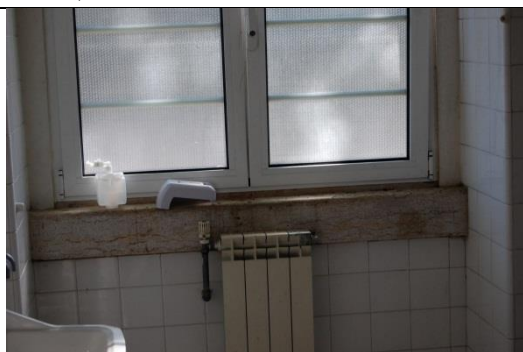
Figura 183. Eflorescências nas zonas fissuradas no peitoril [Fonte: Autora, Data: 19-05-2016]
