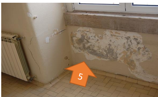
Figura 62. Destacamento do revestimento em no corredor 34, 1ºAndar [Fonte: Autora, Data: 25-05-2016]
