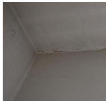
Figura 105. Fissuras no teto, no Quarto nº5, 1ª [Fonte: Autora, Data: 25-05-2016]
