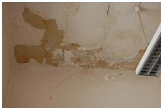
Figura 119. Destacamento do reboco, por perda de aderência, localizado no refeitório do Piso 0, no núcleo central [Fonte: Autora, Data: 19-05-2016]
