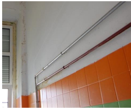
Figura 199. Rutura na tubagem, originando manchas de humidade no revestimento sob a tubagem [Fonte: Autora, Data: 19-05-2016]
