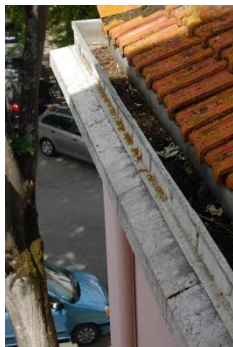
Figura 203. Entupimento do algeroz [Fonte: Autora, Data: 25-05-2016]
