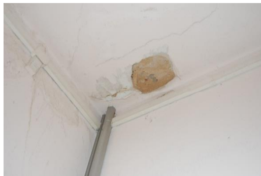
Figura 121. Evolução da patologia (Figura 2) Destacamento de reboco, ficando à vista [Fonte: Autora, Data: 07-07-2016]
