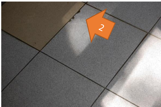
Figura 83. Esmagamento do bordo do ladrilho e consequente destacamento de lascas no quarto 47, RC [Fonte: Autora, Data: 19-05-2016]
