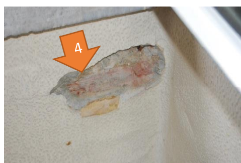
Figura 61. Destacamento do reboco, sob o peitoril, com alvenaria mista de tijolo, à vista [Fonte: Autora, Data: 25-05-2016]
