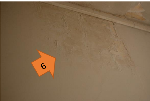
Figura 51. Eflorescências na parede do corredor, no Piso 1 [Fonte: Autora, Data: 25-05-2016]
