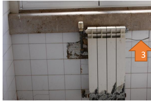
Figura 74. Fissuração do revestimento cerâmico da parede interior sob o peitoril, no I.S. nº 43, Piso 1 [Fonte: Autora, Data: 30-05-2016]
