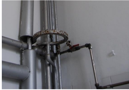
Figura 198. Corrosão dos elementos metálicos que compõem o sistema de drenagem de águas de abastecimento [Fonte: Autora, Data: 25-05-2016]
