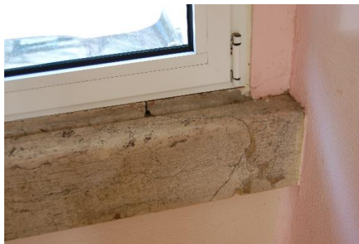
Figura 26. Fissuras no peitoril, pelo interior [Fonte: Autora]
