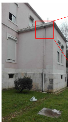
Figura 205. Inexistência do funil que liga o bocal ao tubo de queda [Fonte: Autora, Data: 03-02-2017]
