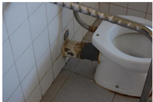
Figura 23. Incrustações e Corrosão dos elementos metálicos na rede de águas residuais [Fonte: Autora]
