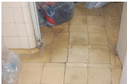
Figura 19. Empolamento do revestimento do pavimento [Fonte: Autora]
