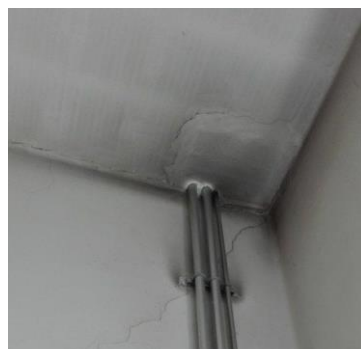
Figura 107. Fissuração junto da tubagem, Instalação Sanitária nº18, RC [Fonte: Autora, Data: 19-05-2016]
