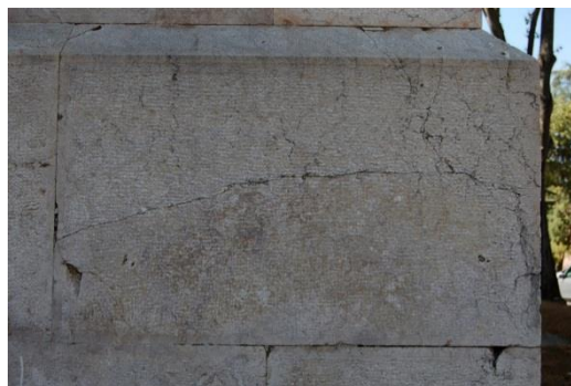
Figura 135. Localização da Patologia no cunhal [Fonte: Autora, Data: 01-09-2016]
