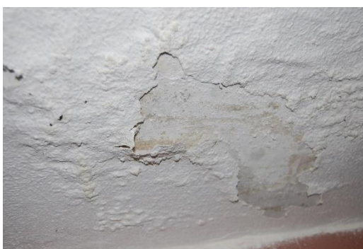
Figura 30. Destacamento do revestimento nas paredes enterradas [Fonte: Autora]
