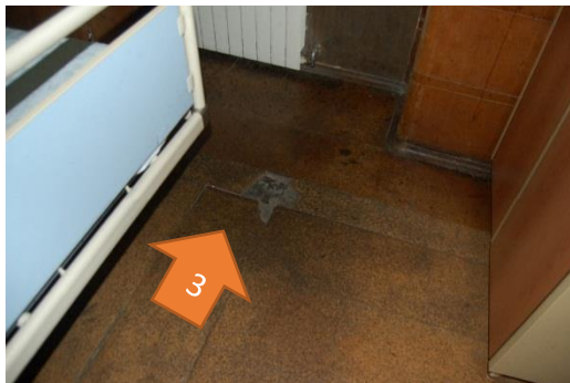
Figura 84. Destacamento de elementos do revestimento do pavimento, no quarto nº30, 1ºAndar [Fonte Autora, Data:25-05-2016]
