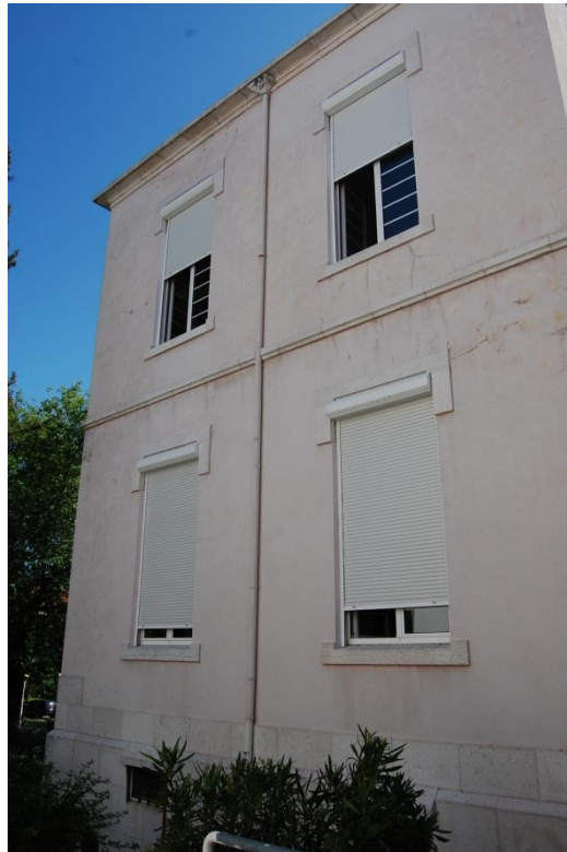
Figura 3. Fissuras de reduzida espessura, sob os peitoris de pedra, e diagonais sobre a padieira [Fonte: Autora, Data: 31-05-2016]
