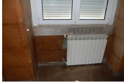
Figura 175. Manchas de humidade no peitoril sobre o radiador [Fonte: Autora, Data: 25-05-2016]
