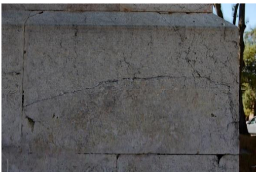
Figura 6. Fissuração dos elementos de cantaria [Fonte: Autora]
