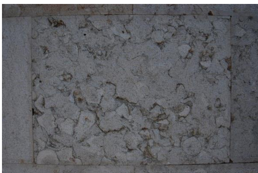
Figura 158. Pormenorização da alveolização do revestimento de pedra. [Fonte: Autora, Data:01-09-2016]
