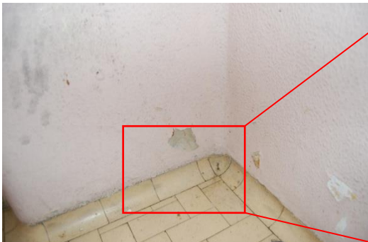
Figura 94. Desgaste natural da camada superficial, RC Nascente Inferior – Corredor 36 [Fonte: Autora, Data: 19-05-2016]
