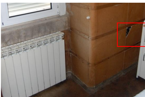
Figura 64. Destacamento do revestimento em cortiça, no 1º Andar [Fonte: Autora, Data: 25-05-2016]
