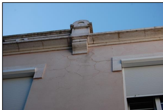
Figura 1. Fissuração em rendilhado, na fachada principal [Fonte: Autora, Data: 18-05-2016]
