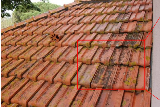
Figura 128. Colonização Biológica na cobertura, Fachada Lateral Poente [Fonte: Autora, Data: 25-06-2016]
