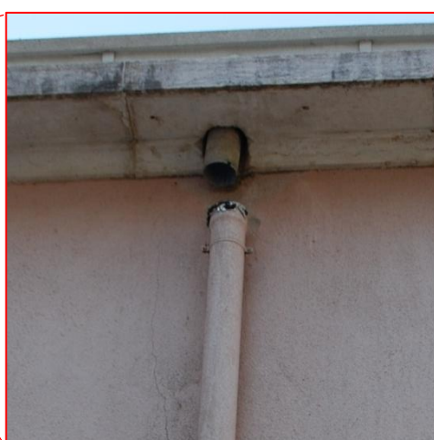
Figura 206. Inexistência do funil que liga o bocal ao tubo de queda [Fonte: Autora, Data: 03-02-2017]
