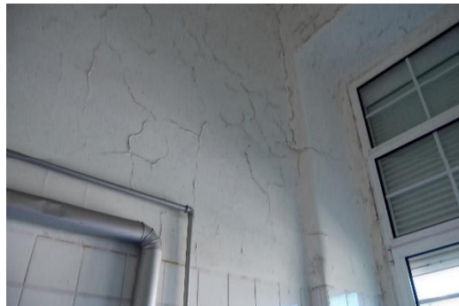
Figura 22. Fissuração no revestimento interior na I.S. [Fonte: Autora]
