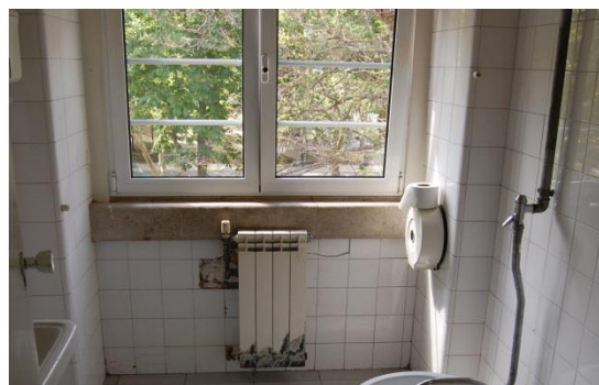
Figura 181. Aparecimento de manchas verdes escuras no peitoril de pedra, Piso 1 [Fonte: Autora, Data: 30-05-2016]
