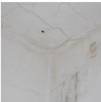
Figura 103. Fissuras na ligação teto-parede [Fonte: Autora, Data: 25-05-2016]
