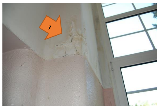
Figura 46. Aparecimento de cripto-eflorescências, junto do vão de uma janela, no RC [Fonte: Autora, Data: 19-05-2016]
