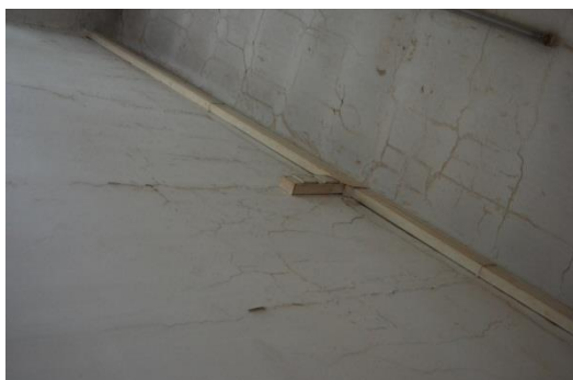
Figura 114. Alteração da superfície por manchas castanhas no Corredor n° 8, no Piso 1 [Fonte: Autora, Data: 25-05-2016]
