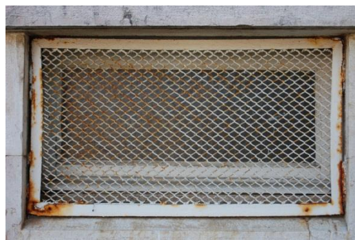
Figura 191. Aparecimento de manchas acastanhadas (ferrugem) nas grades duma janela da cave, na fachada lateral poente [Fonte: Autora, Data: 18-05-2016]
