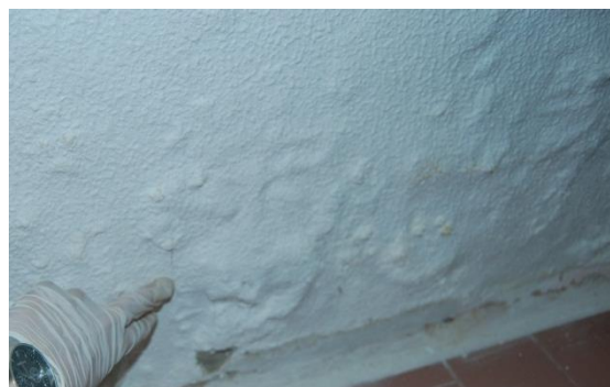
Figura 77. Aparecimento de cripto florescências na base do revestimento das paredes enterradas [Fonte: Autora, Data: 23-06-2016]
