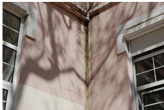
Figura 18. Colonização Biológica no revestimento aplicado na Fachada Principal [Fonte: Autora, Data: 18-05-2016]
