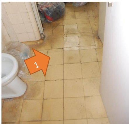
Figura 90. Empolamento do elemento cerâmico, no 1º Andar [Fonte: Autora, Data: 25-05-2016]
