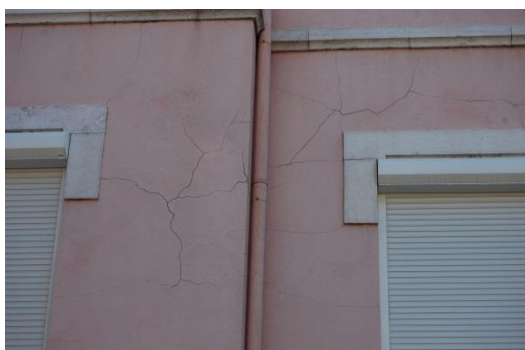
Figura 5. Fissuras com orientação irregular, junto dos tubos de queda, na fachada poente [Fonte: Autora, Data: 18-05-2016]
