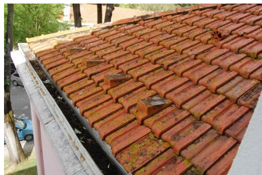
Figura 202. Obstrução do tubo de queda, devido à acumulação de detritos no algeroz [Fonte: Autora, Data: 25-05-2016]
