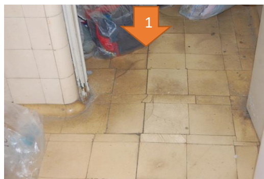
Figura 89. Empolamento do revestimento do pavimento, numa I.S. (nº28) no 1º Andar [Fonte: Autora, Data:25-05-2016]
