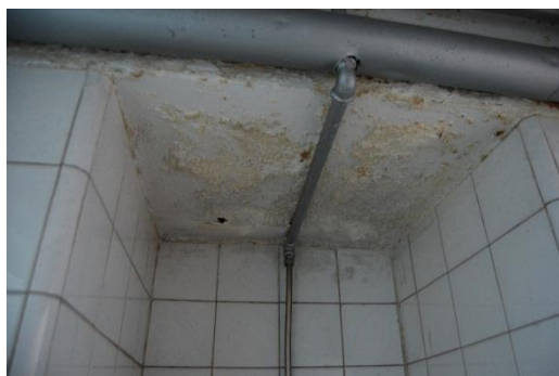
Figura 115. Aparecimento de cripto florescências no teto de uma I.S. por onde passa a canalização, no Piso 0 [Fonte: Autora, Data: 19-05-2016]
