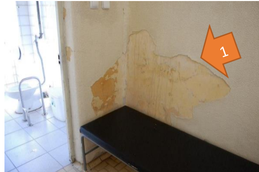
Figura 57. Destacamento do revestimento das paredes interiores junto a uma instalação sanitária [Fonte: Autora, Data: 25-05-2016]
