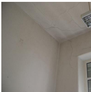
Figura 100. Fissuras lineares imediatamente acima da verga [Fonte: Autora, Data: 25-05-2016]
