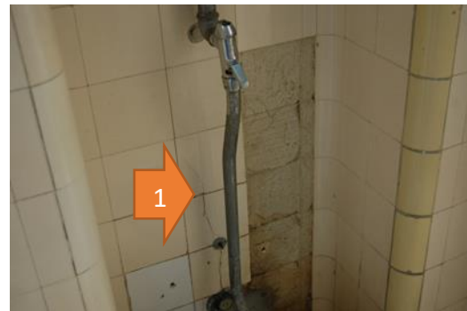
Figura 72. Fissuração do revestimento cerâmico numa I.S. no Piso 1 [Fonte: Autora, Data: 25-05-2016]
