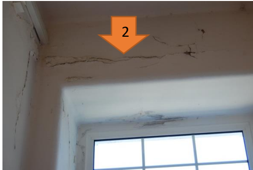
Figura 47. Aparecimento de cripto-eflorescências junto do vão da janela [Fonte: Autora, Data: 19-05-2016]
