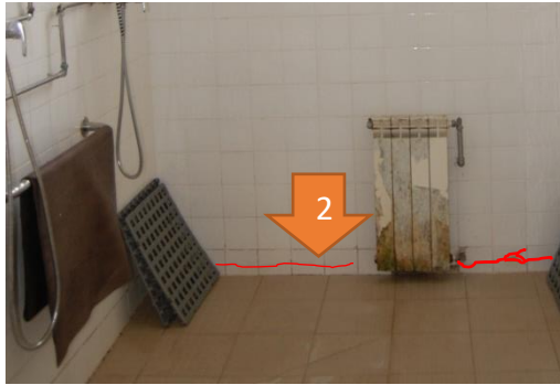
Figura 73. Fissuração na base do revestimento cerâmico da parede interior da I.S. nº2, no Piso 1 [Fonte: Autora, Data: 25-05-2016]
