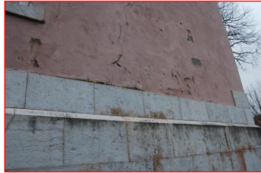
Figura 29. Deposição de sais no interior da pintura [Fonte: Autora, Data: 3-2-2017]
