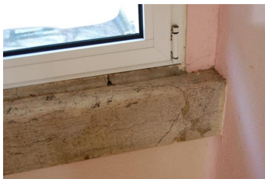
Figura 184. Fissura no peitoril [Fonte: Autora, Data: 19-05-2016]
