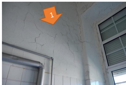
Figura 34. Fissuração aleatória numa parede de I.S. no R/C [Fonte: Autora, Data: 19-05-2016]
