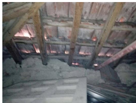
Figura 134. Estrutura de madeira degradada devido a infiltrações [Fonte: Autora, Data: 25-06-2016]
