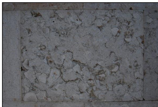
Figura 155. Alveolização do revestimento de pedra. [Fonte: Autora, Data:01-09-2016]
