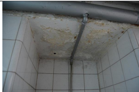
Figura 200. Rotura na tubagem, com aparecimento de cripto-florescências e eflorescências no revestimento dum I.S. no Piso 0 [Fonte: Autora, Data: 19-05-2016]
