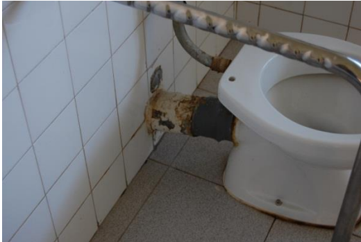
Figura 197. Corrosão dos elementos metálicos do Sifão [Fonte: Autora, Data: 19-05-2016]
