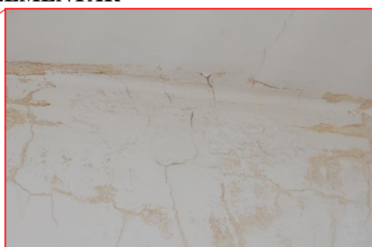
Figura 113. Pormenorização da Patologia [Fonte: Autora, Data: 30-05-2016]
