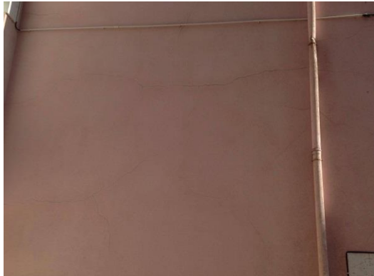
Figura 2. Fissuras horizontais junto dos tubos de queda, na fachada lateral poente [Fonte: Autora, Data: 01-09-2016]
