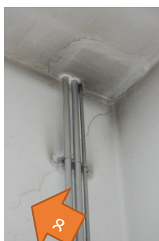
Figura 41. Fendilhação do reboco no piso 1 [Fonte: Autora, Data: 25-05-2017]
