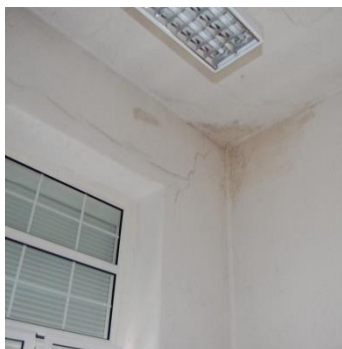
Figura 101. Fissuras lineares, na parte superior da abertura das [Fonte: Autora, Data: 25-05-2016]
