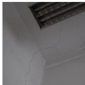
Figura 108. Fissuração junto à instalação elétrica, quarto nº 32, RC [Fonte: Autora, Data: 19-05-2016]
