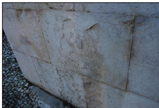
Figura 154. Descamação do revestimento de pedra [Fonte: Autora, Data:18-05-2016]
