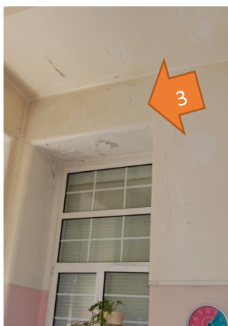
Figura 36. Fissura vertical na ligação teto parede junto ao vão da janela, no piso 0, Copa nº 19 [Fonte: Autora, Data: 19-05-2016]
