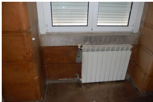
Figura 25. Manchas escuras no peitoril interior, sobre o radiador de aquecimento central [Fonte: Autora]
