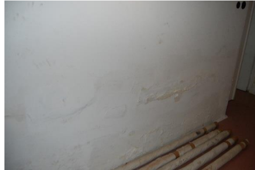
Figura 79. Empolamentos e destacamento do revestimento na base da parede enterrada [Fonte: Autora, Data: 26-06-2016]
