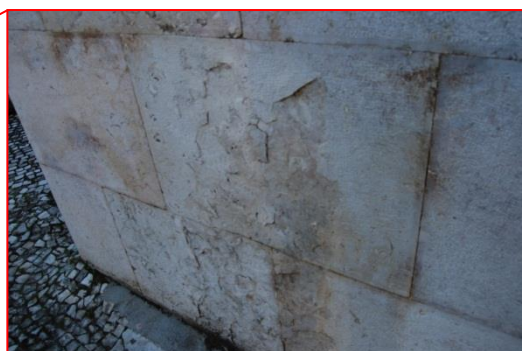
Figura 157. Descamação do revestimento de pedra [Fonte: Autora, Data:18-05-2016]
