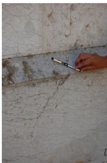
Figura 137. Aparecimento de fissuras sobre revestimento exterior [Fonte: Autora, Data: 01-09-2016]
