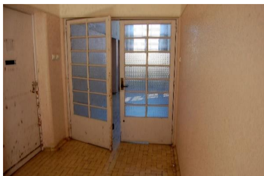
Figura 27. Destacamento da pintura das portas interiores [Fonte: Autora]
