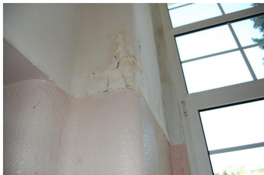
Figura 16. Aparecimento de cripto florescências na parede interior em tinta esmalte [Fonte: Autora]
