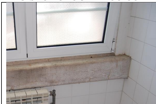
Figura 182. Manchas esbranquiçadas [Fonte: Autora, Data: 19-05-2016]
