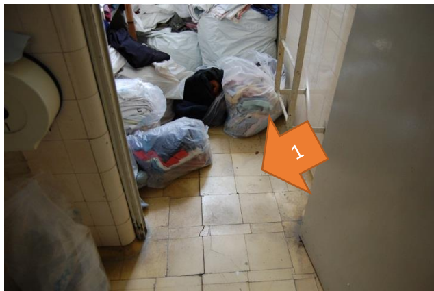
Figura 91. Pormenorização da mesma patologia localizada numa instalação sanitária que funciona como arrumação de roupa suja, com acesso à cobertura, no 1º Andar [Fonte: Autora, Data: 25-05-2016]
