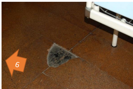
Figura 87. Esmagamento do bordo do ladrilho com consequente destacamento do mesmo, no quarto nº33, 1ºAndar [Fonte: Autora, Data: 30-05-2015]
