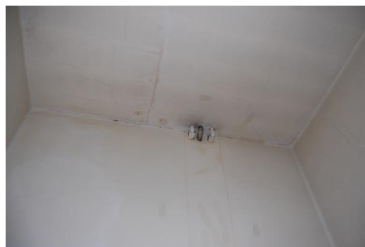
Figura 99. Fissuração do teto, junto à canalização do 1º Andar [Fonte: Autora, Data: 25-05-2016]
