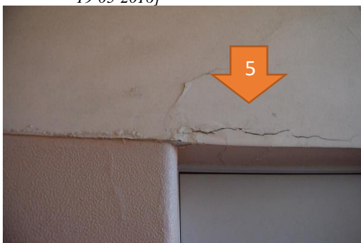
Figura 38. Fendilhação no reboco, no vão de uma porta, localizada no Piso 0 [Fonte: Autora, Data: 19-05-2016]
