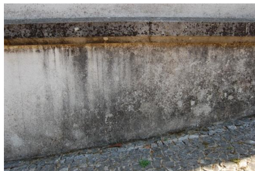
Figura 148. Deposição de líquenes na platibanda com capeamento em pedra de lioz [Fonte: Autora, Data:01-09-2016]
