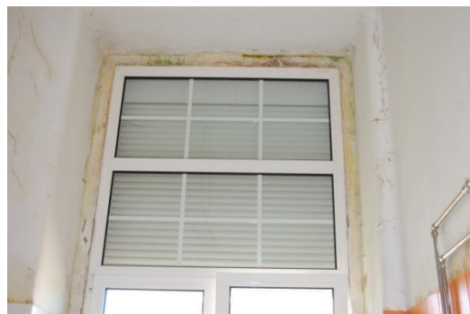
Figura 68. Colonização Biológica, numa I.S. no Piso 0 [Fonte: Autora, Data: 19-05-2016]
