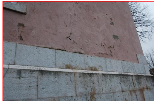
Figura 13. Deposição de sais no interior da pintura [Fonte: Autora, Data: 3-2-2017]
