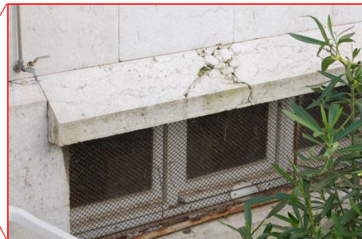
Figura 145. Pormenorização da patologia sobre a verga do vão das janelas da cave [Fonte: Autora, Data:31-05-2016]
