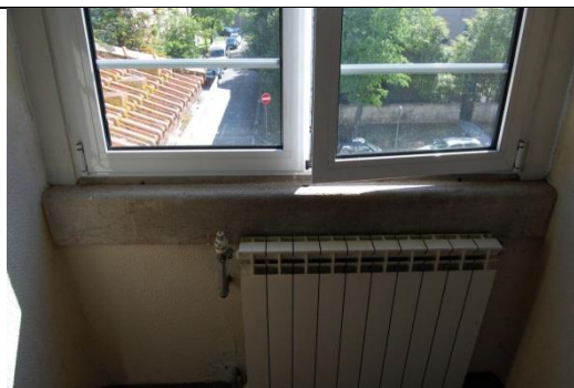
Figura 180. Tonalidades de manchas de humidades, no peitoril, no quarto nº 33, Piso 1 [Fonte: Autora, Data: 20-05-2016]
