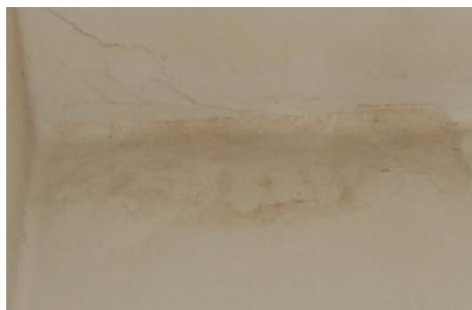
Figura 117. Aparecimento de cripto florescências no teto da I.S. n°1, no Piso 1 [Fonte: Autora, Data: 25-05-2016]
