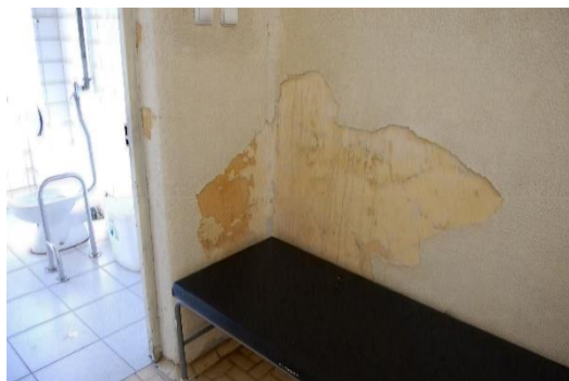
Figura 14. Destacamento do revestimento interior [Fonte: Autora]
