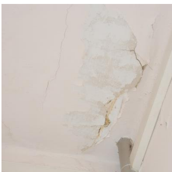
Figura 106. Fissuração linear no teto, no piso superior está localizada uma instalação sanitária [Fonte: Autora, Data: 19-05-2016]
