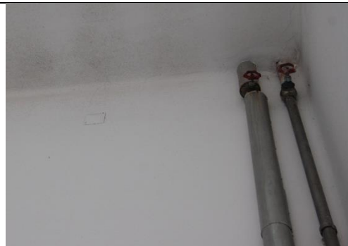
Figura 201. Veios de água, que escorre pela tubagem identificado pontos de rotura na mesma [Fonte: Autora, Data: 25-05-2016]
