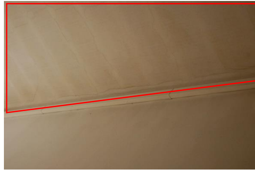
Figura 125. Manchas escuras no corredor nº 34 [Fonte: Autora, Data: 25-05-2016]
