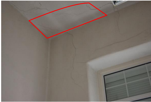
Figura 124. Manchas escuras no teto, do Piso 1, [Fonte: Autora, Data: 25-05-2016]
