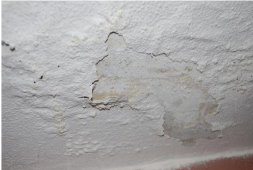
Figura 78. Destacamento do revestimento na base da parede enterrada [Fonte: Autora, Data: 23-06-2016]
