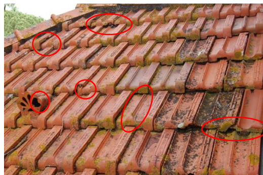
Figura 131. Telhas partidas e sobreposição inadequada das mesmas [Fonte: Autora, Data: 25-06-2016]
