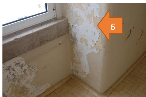
Figura 63. Destacamento do revestimento em no corredor 34, 1ºAndar [Fonte: Autora, Data: 25-05-2016]
