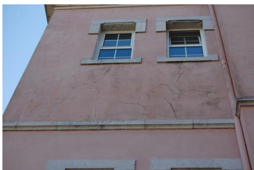
Figura 4. Fissuras em rendilhado, em particular sob peitoris de pedra [Fonte: Autora, Data: 18-05-2016]
