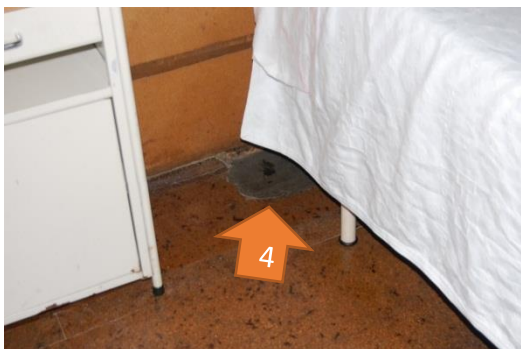
Figura 85. Destacamento das peças em cortiça no quarto nº30, 1ºAndar [Fonte: Autora, Data: 25-05-2016]
