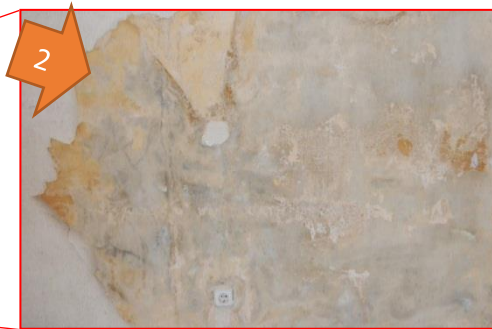
Figura 59. Pormenorização da patologia na figura 2 [Fonte: Autora, Data: 30-05-2016]
