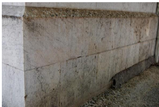
Figura 7. Deposição de guanos nos elementos de cantaria [Fonte: Autora]
