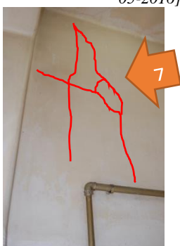
Figura 40. Fissuração do reboco, localizado no Piso 1 [Fonte: Autora, Data: 30-05-2016]
