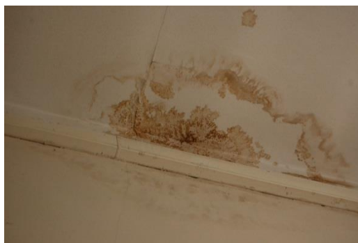
Figura 111. Alteração da superfície por recristalização de sais (manchas castanhas), no Piso 1 [Fonte: Autora, Data: 25-05-2016]
