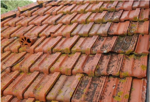
Figura 132. Telhas partidas [Fonte: Autora, Data: 25-06-2016]
