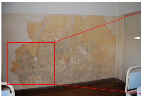
Figura 58. Destacamento do revestimento em praticamente toda a parede interior do quarto nº40, 1ºAndar [Fonte: Autora, Data: 30-05-2016]
