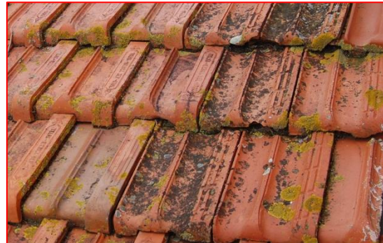
Figura 129. Pormenorização da Patologia [Fonte: Autora, Data: 25-06-2016]
