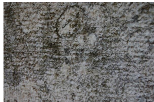
Figura 149. Deposição de líquenes no revestimento de pedra de lioz [Fonte: Autora, Data:01-09-2016]
