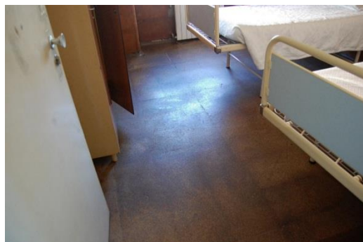
Figura 93. Desgaste superficial do pavimento em cortiça e alteração de cor, Quarto n° 27, 1º Andar [Fonte: Autora, Data: 20-05-2016]
