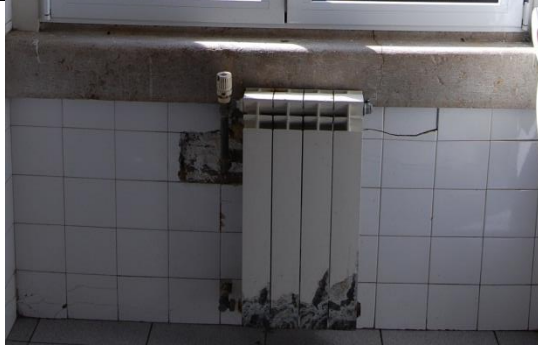
Figura 185. Fissuração do peitoril, junto ao radiador [Fonte: Autora, Data: 20-05-2016]
