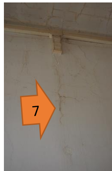
Figura 52. Eflorescências na parede do corredor, no Piso 1 [Fonte: Autora, Data: 25-05-2016]
