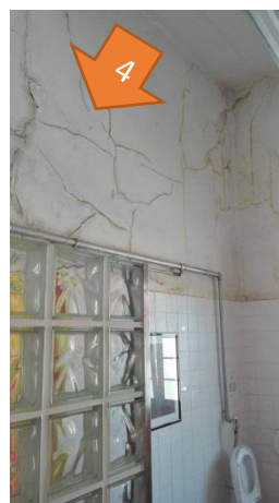
Figura 37. Fissuras aleatórias numa parede divisória duma I.S. no piso 0 [Fonte: Autora, Data: 23-06-2016]
