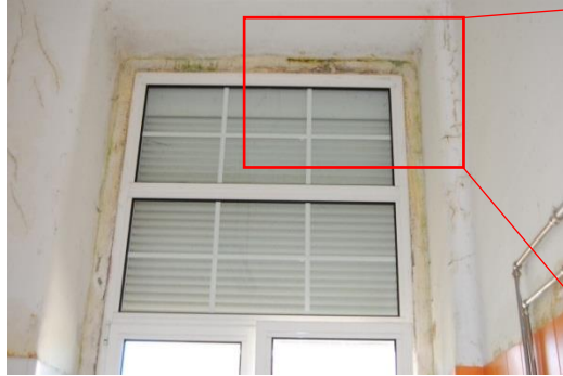
Figura 69. Colonização Biológica, numa I.S. no Piso 0 [Fonte: Autora, Data: 19-05-2016]
