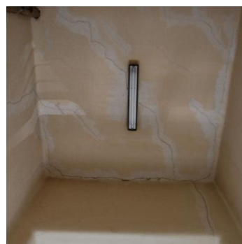
Figura 102. Fissuras no Quarto 43, 1ª [Fonte: Autora, Data: 20-05-2016]
