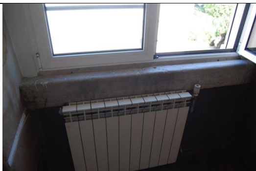
Figura 179. Manchas de tonalidade mais escura, no peitoril, sobre o radiador, Piso 1 [Fonte: Autora, Data: 20-05-2016]
