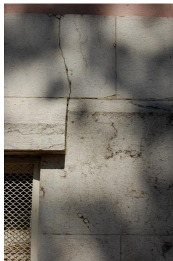
Figura 138. Aparecimento de fissuras sobre o vão da janela da cave [Fonte: Autora, Data: 01-09-2016]
