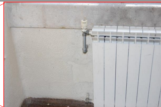
Figura 178. Pormenorização da Patologia [Fonte: Autora, Data: 30-05-05-2016]
