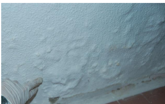
Figura 29. Humidades por ascensão nas paredes enterradas [Fonte: Autora]
