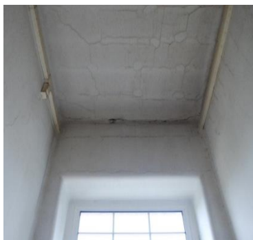
Figura 104. Fissuras em rendilhado, na ligação teto-parede [Fonte: Autora, Data: 25-05-2016]
