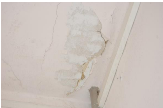
Figura 120. Destacamento do (acabamento) com fissuração no reboco, no andar superior, fica localizada uma I.S. [Fonte: Autora, Data: 19-05-2016]
