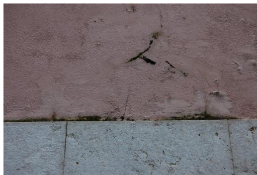
Figura 22. Vegetação no revestimento, localizada na fachada posterior, sob o vão da janela [Fonte: Autora, Data: 3-2-2017]
