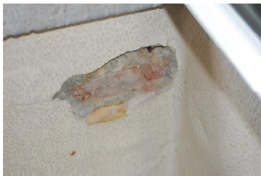
Figura 15. Destacamento do reboco, com alvenaria mista de tijolo à vista [Fonte: Autora]
