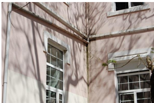
Figura 19. Aparecimento de manchas esverdeadas no revestimento aplicado na Fachada Principal [Fonte: Autora, Data:18-05-2016]
