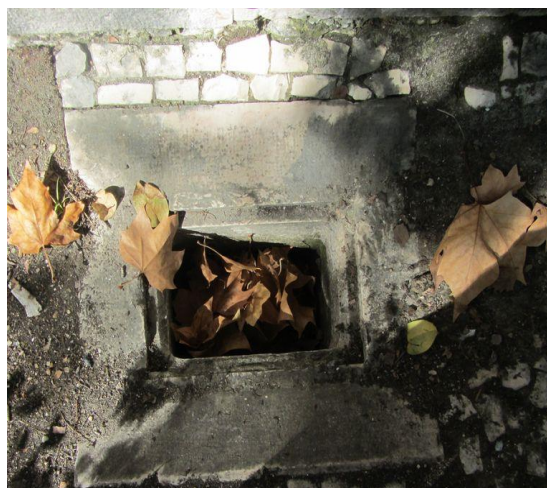
Figura 96-Caixa de visita sem grelha e com deposição de folhas que poderão causar entupimentos na rede de esgotos, situada na fachada de tardoz. Fonte: Autor, outubro 2017.
