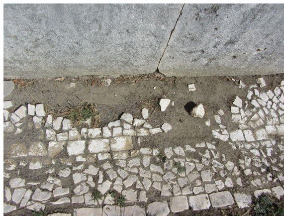
Figura 90- Ausência de elementos de calçada no canal de drenagem, na fachada lateral direita. Fonte: Autor, outubro 2017.
