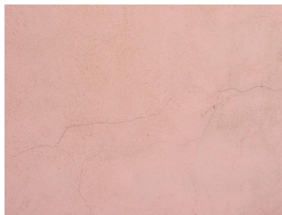
Figura 61- Fissuração na parede de fachada lateral direita. Fonte: Autor, outubro 2017.
