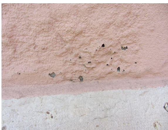
Figura 55- Empolamento dos materiais de revestimento devido a eflorescência/criptoflorescência. Fonte: Autor, outubro 2017.
