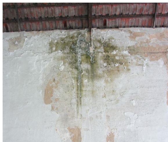
Figura 99-Pormenor de criptoflorescências com degradação do reboco e colonização biológica. Fonte: Autor, outubro 2017.
