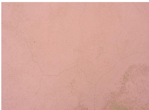
Figura 60- Fissuração na parede de fachada principal. Fonte: Autor, outubro 2017.
