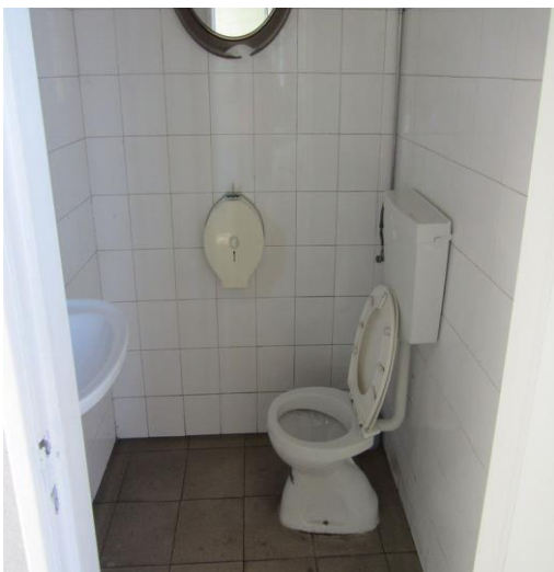
Figura 31- Abastecimento ao tanque do autoclismo pelo exterior da parede. Fonte: Autor, setembro 2017.
