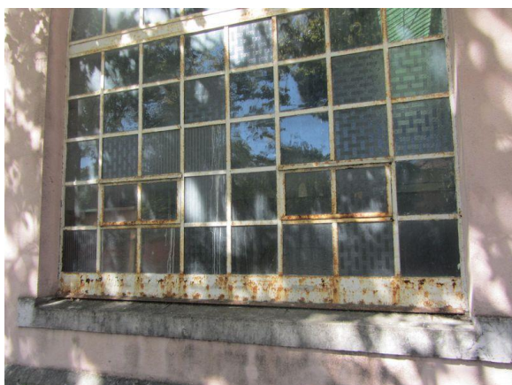
Figura 75—Vão de janela na fachada tardoz corroída. Fonte: Autor, outubro 2017.
