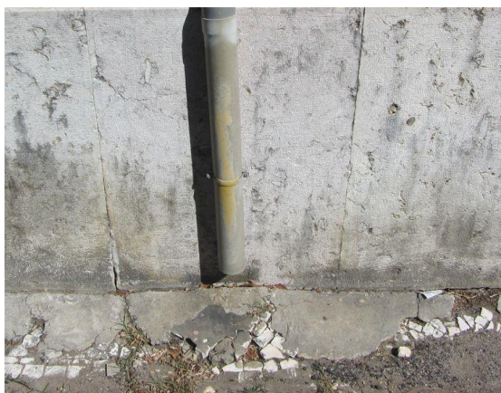
Figura 89- Revestimento de argamassa cimentícia já degradada por baixo do tubo de queda. Fonte: Autor, outubro 2017.
