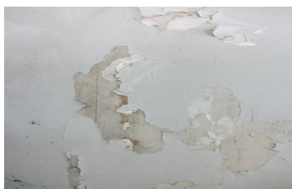
Figura 102-Destacamento de tinta, no paramento interior do lado esquerdo. Fonte: Autor, outubro 2017.
