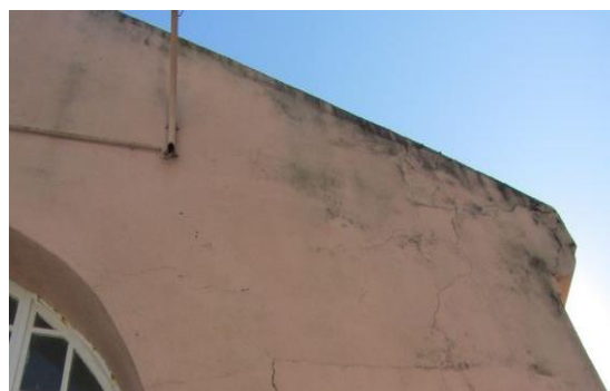
Figura 57- Mancha de humidade na parte superior da fachada principal. Fonte: Autor, outubro 2017.
