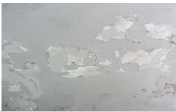
Figura 103-Destacamento de tinta, no paramento interior do lado direito. Fonte: Autor, outubro 2017.
