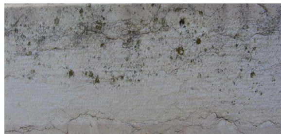
Figura 74-- Fissuras presentes no peitoril de um vão de janela. Fonte: Autor, outubro 2017.
