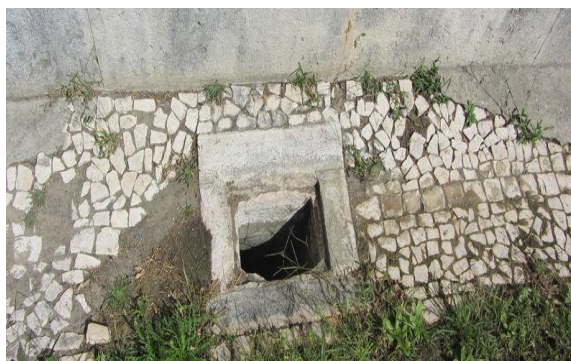
Figura 91— Presença de vegetação nos locais onde faltam elementos da calçada e entre juntas já degradadas, na fachada lateral direita. Fonte: Autor, outubro 2017.
