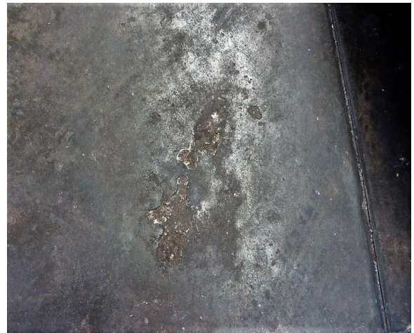
Figura 111-Pormenor do degaste provocado por cargas excessivas. Fonte: Autor, outubro 2017.
