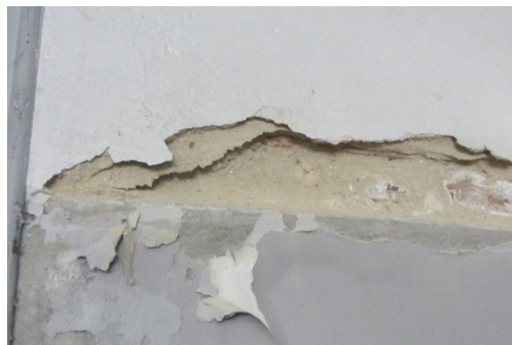
Figura 100-Destacamento do reboco, no paramento interior da arrecadação. Fonte: Autor, outubro 2017
