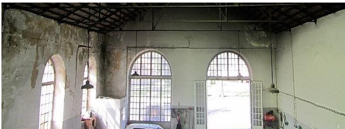
Figura 97-Vista geral das criptoflorescências presentes na parte superior dos paramentos, em estando avançado com degradação do reboco e colonização biológica em certas zonas. Fonte: Autor, outubro 2017.
