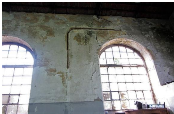
Figura 109-Oxidação dos tubos que protegem os fios das instalações elétricas, que com a expansão do metal devido à corrosão fez soltar o reboco que cobria essa zona, situado na parede sudeste. Fonte: Autor, outubro 2017.
