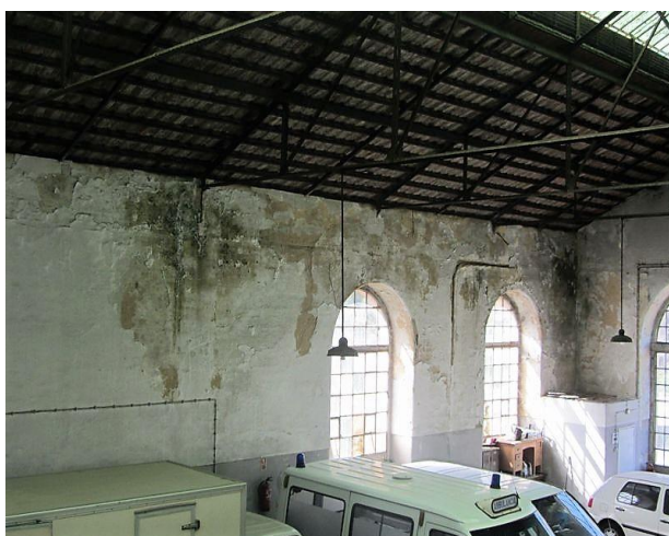
Figura 98-Criptoflorescências na zona mais afetada do edifício. Fonte: Autor, outubro 2017.
