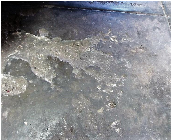
Figura 110-Degaste do pavimento com destruição da camada superficial da betonilha. Fonte: Autor, outubro 2017.
