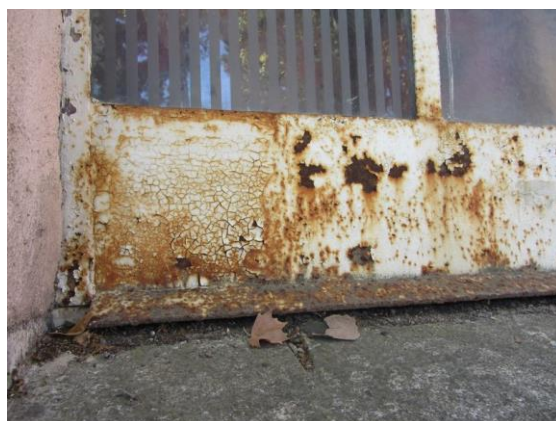
Figura 77-Vão de janela apresentando corrosão muito desenvolvida, tendo já em variados locais danificado por completo o revestimento de tinta. Fonte: Autor, outubro 2017.
