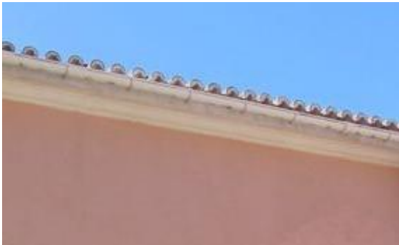
Figura 36- Pormenor do beirado do edifício 31-A. Fonte: Autor, setembro 2017.
