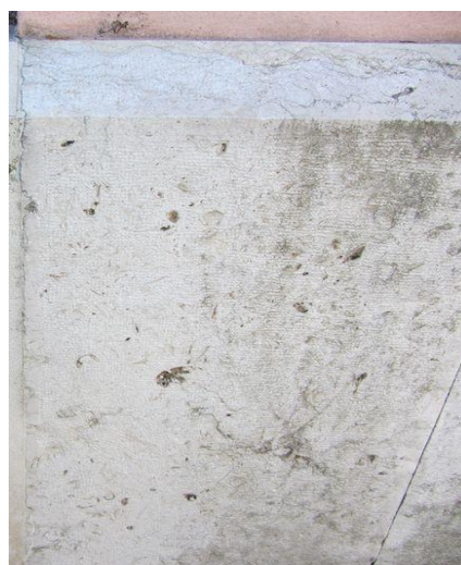
Figura 66-Alveolização presente na fachada lateral direita. Fonte: Autor, outubro 2017
