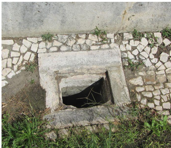
Figura 95-Caixa de visita sem grelha, situada na fachada lateral direita. Fonte: Autor, outubro 2017.
