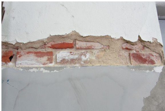
Figura 101-Destacamento do reboco, no paramento interior da arrecadação em frente da entrada. Fonte: Autor, outubro 2017.
