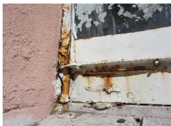
Figura 76—Vão de janela corroído na fachada lateral direita, apresentando uma elevada degradação e descolamento do paramento. Fonte: Autor, outubro 2017.
