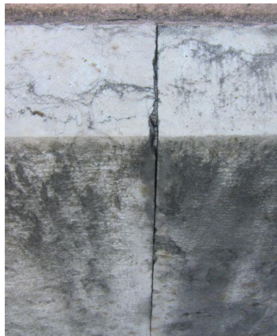
Figura 72-Ausência parcial e total de material de preenchimento de juntas, na fachada principal. Fonte: Autor, outubro 2017.
