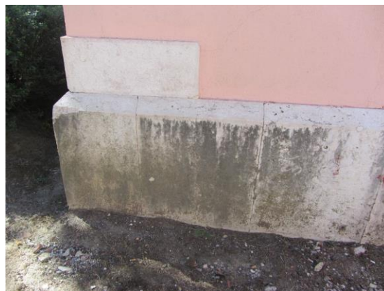
Figura 70-Crostas negras no soco da fachada lateral esquerda. Fonte: Autor, outubro 2017.
