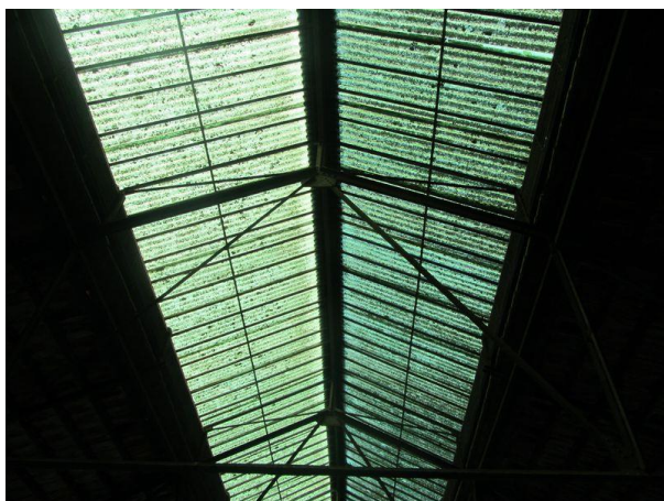
Figura 84- Chapas acrílicas da cobertura apresentando mudança de cor e detritos - interior. Fonte: Autor, outubro 2017.
