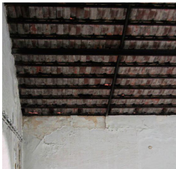
Figura 87-Vista interior da cobertura, realçando alguns pontos de entrada de luz entre as telhas, podendo ser local de infiltrações de águas pluviais, tomando como referência as humidades presentes no paramento adjacente. Fonte: Autor, outubro 2017.
