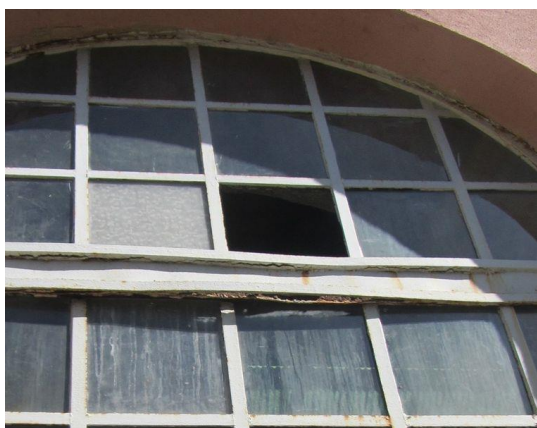
Figura 79-Perda de vidro no vão de janela situado na fachada lateral direita. Fonte: Autor, outubro 2017.
