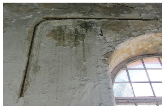
Figura 108-Pormenor do tubo oxidado. Fonte: Autor, outubro 2017.
