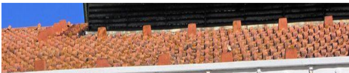
Figura 86-Vista exterior da cobertura, com as telhas manchadas de tom verde. Fonte: Autor, outubro 2017
