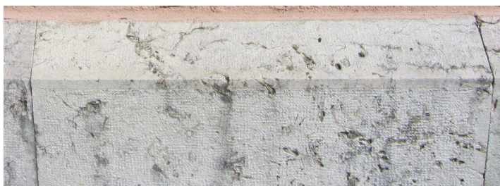
Figura 68-Pormenor de alveolização na fachada no soco da fachada principal. Fonte: Autor, outubro 2017.
