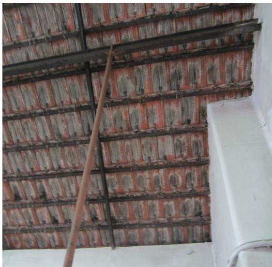
Figura 88-Vista interior da cobertura, notando-se o facto de todas as telhas apresentarem manchas escuras de humidade. Fonte: Autor, outubro 2017.
