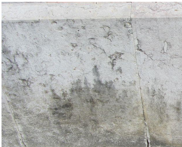
Figura 73-Fissuras no soco da fachada. As fissuras não apresentam largura superior a 0,5mm. Fonte: Autor, outubro 2017.
