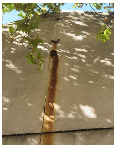
Figura 59-Mancha ferrosa na fachada tardoz. Fonte: Autor, outubro 2017.
