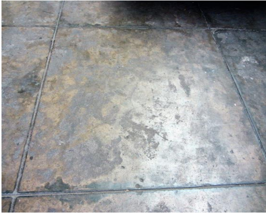
Figura 44- Betonilha, queimada e esquarterada. Fonte: Autor, setembro 2017.
