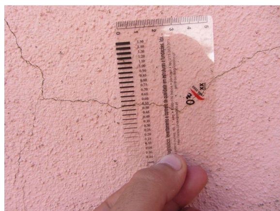
Figura 63-Medidor de fissuras - Fissura com 0,55mm de largura. Fonte: Autor, outubro 2017.
