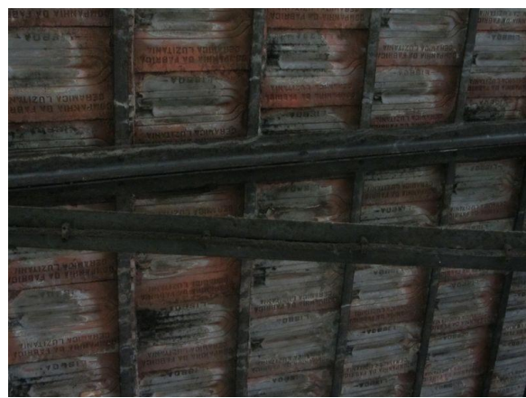
Figura 82-Pormenor de corrosão da estrutura. Fonte: Autor, outubro 2017.
