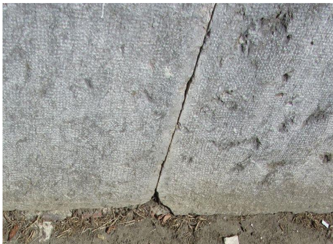
Figura 71- - Ausência total de material de preenchimento de juntas, localizada na fachada lateral direita. Fonte: Autor, outubro 2017.
