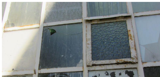
Figura 80-Quebra de vidro no vão de janela situado na fachada lateral direita. Fonte: Autor, outubro 2017.
