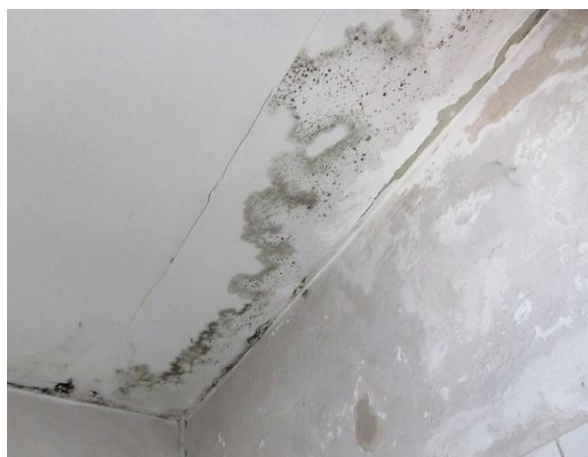
Figura 107-Humidades no teto da instalação sanitária, que também estão a afetar os paramentos adjacentes. Fonte: Autor, outubro 2017.
