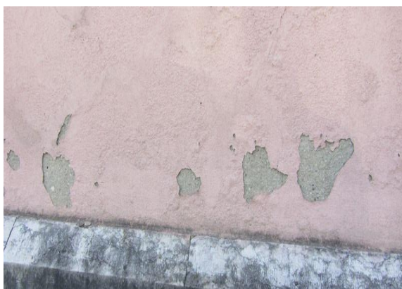
Figura 64- Destacamento de tinta. Fonte: Autor, outubro 2017.
