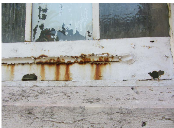
Figura 78-Vão de janela com corrosão avançado apresentando perda de material. Fonte: Autor, outubro 2017.
