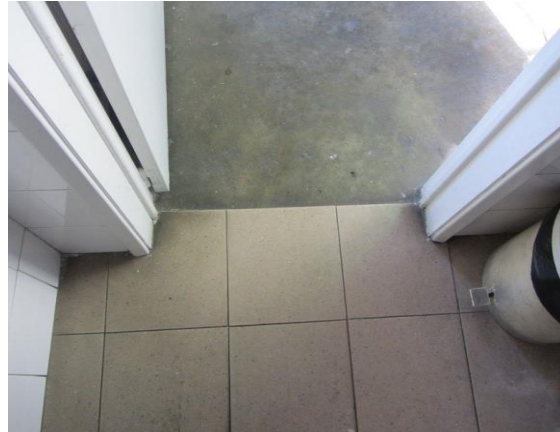
Figura 45- O pavimento da instalação sanitária foi revestido com ladrilho cerâmico, de cor cinza claro com dimensões de 0,4x0,4m. Fonte: Autor, setembro 2017.
