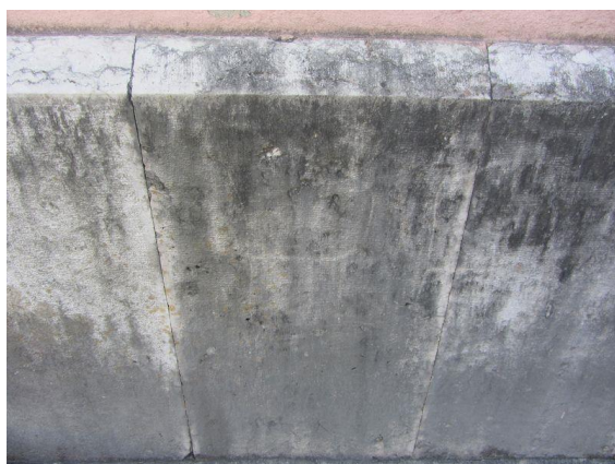
Figura 69-Crostas negras no soco da fachada principal. Fonte: Autor, outubro 2017.
