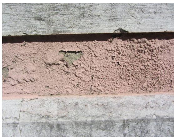
Figura 56- Empolamento e início de desagregação dos materiais de revestimento devido a eflorescência/criptoflorescência. Fonte: Autor, outubro 2017.
