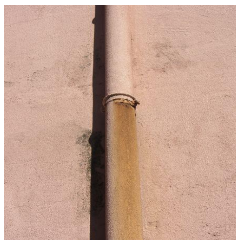
Figura 94- Rotura de tubo de queda, localizado na fachada lateral direita. Fonte: Autor, outubro 2017.
