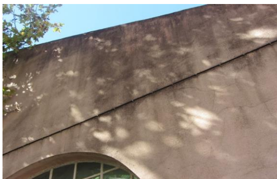
Figura 58- Mancha de humidade na parte superior da fachada de tardoz. Fonte: Autor, outubro 2017.
