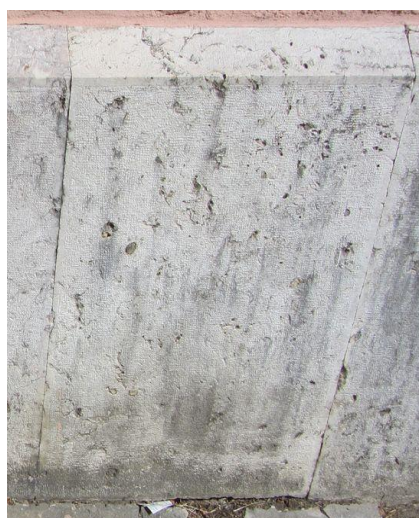
Figura 67- Alveolização no soco da fachada principal. Fonte: Autor, outubro 2017.
