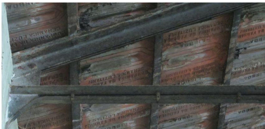
Figura 83—Pormenor da estrutura apresentando sinais de corrosão. Fonte: Autor, outubro 2017.
