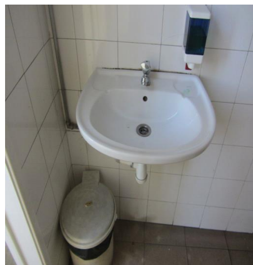
Figura 32- Abastecimento à torneira do lavatório pelo exterior da parede. Fonte: Autor, setembro 2017.
