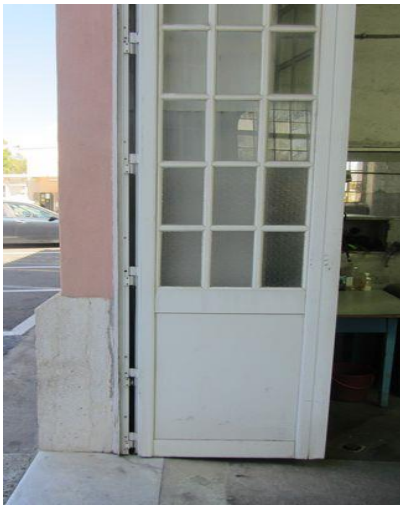
Figura 48- Porta de entrada em alumínio. Fonte: Autor, setembro 2017.
