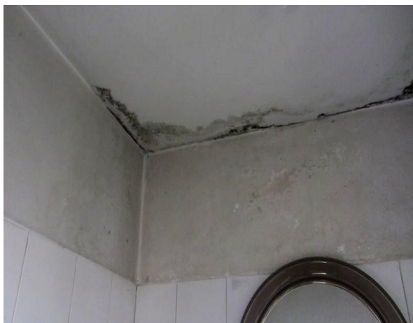
Figura 106-Humidades presentes no teto da instalação sanitária. Fonte: Autor, outubro 2017.
