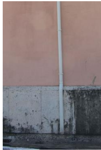
Figura 49- Tubo de queda recente. Fonte: Autor, setembro 2017.
