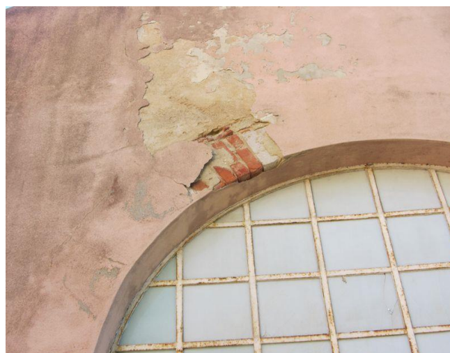
Figura 29- Degradação de arco com tijolo maciço em evidência. Fonte: Autor, setembro 2017.
