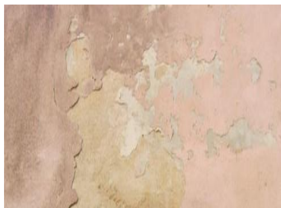
Figura 65-Destacamento de tinta e reboco. Fonte: Autor, outubro 2017.
