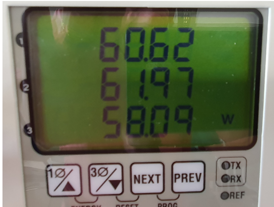
Fig. E.10 – Leitura de potência activa
