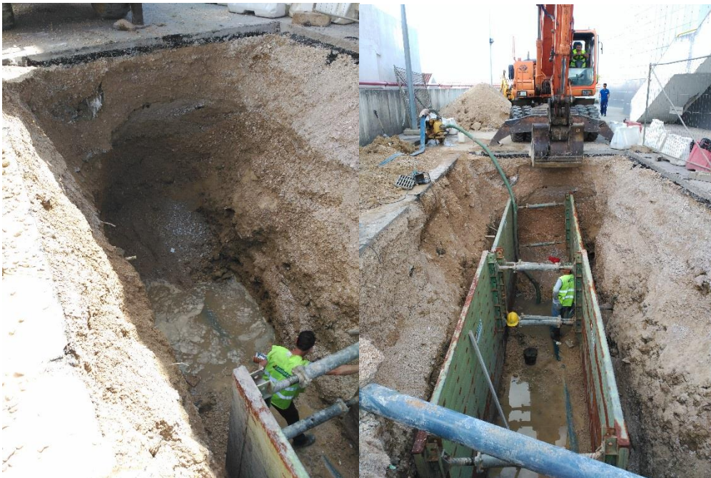
Figura 32 - Dano efetuado no coletor de águas residuais
