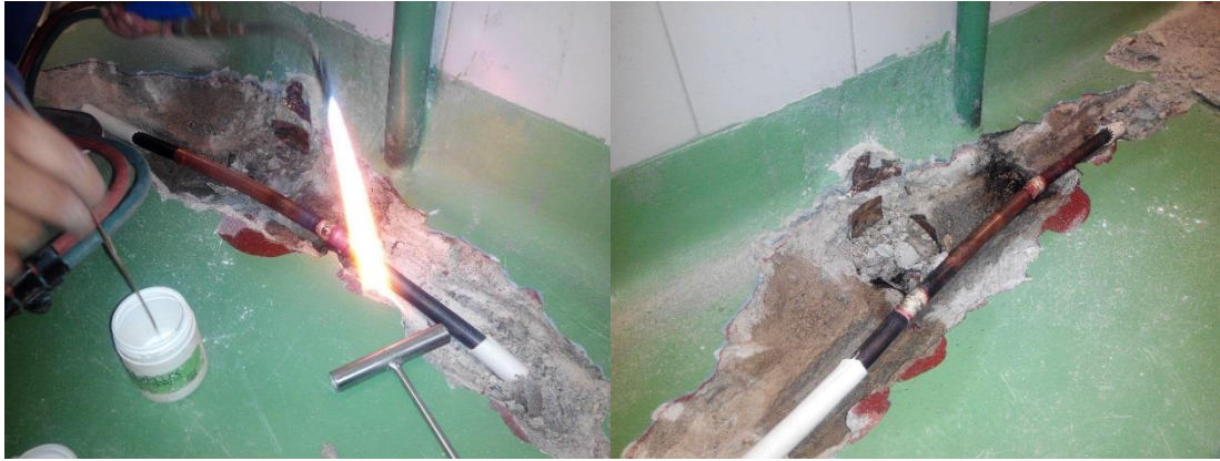
Figura 11 - Correção efetuada na tubagem de gás
