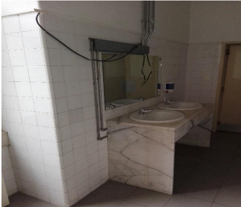
Figura 7 – Instalação sanitário do Edifício 21B
