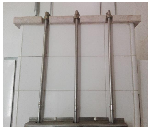
Figura 14 – Redes de abastecimento de água em aço galvanizado
