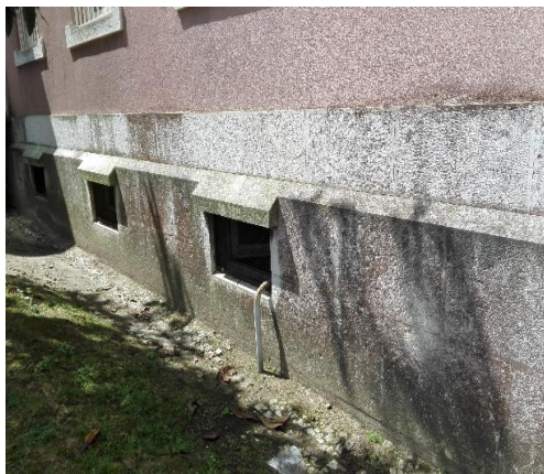
Figura 81 – Colonização biológica, manchas negras e sujidade na pedra de Lioz
