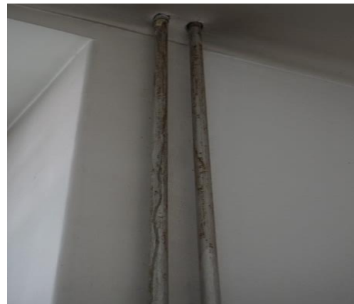
Figura 53 - Oxidação das Redes de abastecimento de água
