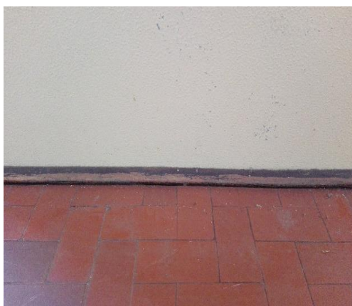
Figura 67 – Envelhecimento dos rodapés em madeira
