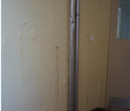
Figura 36 – Empolamento da Pintura
