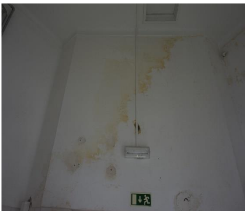
Figura 34 – Manchas de humidade na parede
