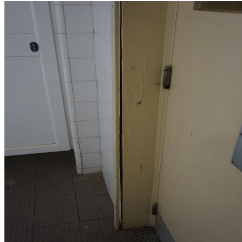
Figura 63 – Destacamento do aro da porta de madeira
