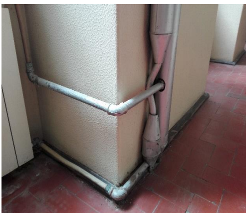
Figura 13 – Redes de abastecimento de água em aço galvanizado
