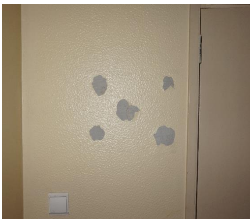
Figura 47 – Descasque da pintura na parede
