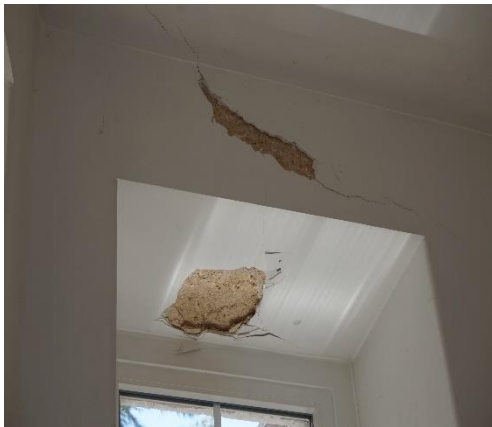
Figura 18 – Fissura no revestimento de estuque
