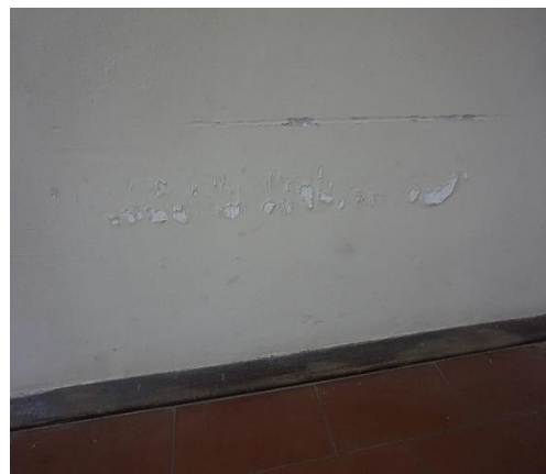
Figura 48 – Descasque da pintura na parede
