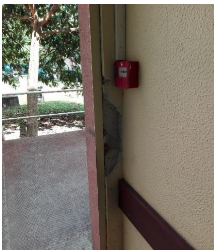
Figura 25 – Destacamento do Reboco na periferia da porta
