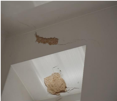
Figura 20 – Fissura no revestimento de estuque
