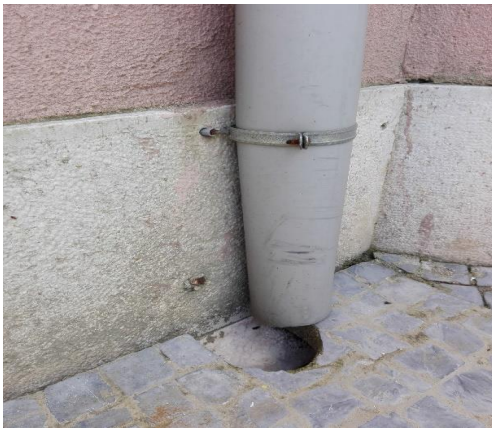
Figura 90 – Sinais de colisão do tubo de queda
