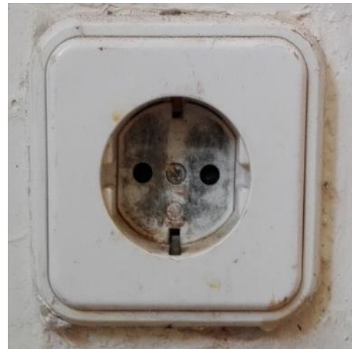
Figura 71 – Curto circuito da tomada elétrica
