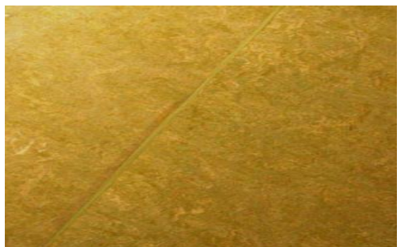
Figura 105 – Resultado final da junta termosoldada [Gabriel, 2011]
