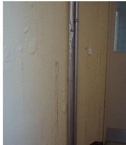
Figura 58 – Deformação das redes de abastecimento de água quente
