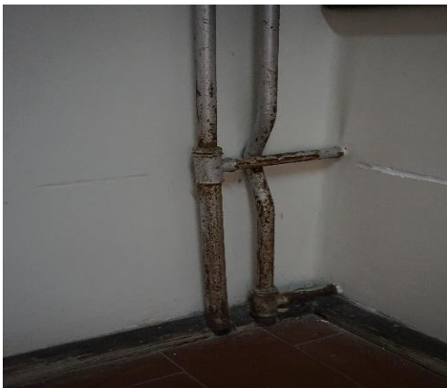
Figura 52 – Oxidação das Redes de abastecimento de água
