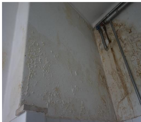
Figura 35 – Eflorescências e Criptoflorescências na parede
