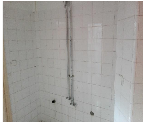
Figura 8 – Instalação sanitário do Edifício 21B
