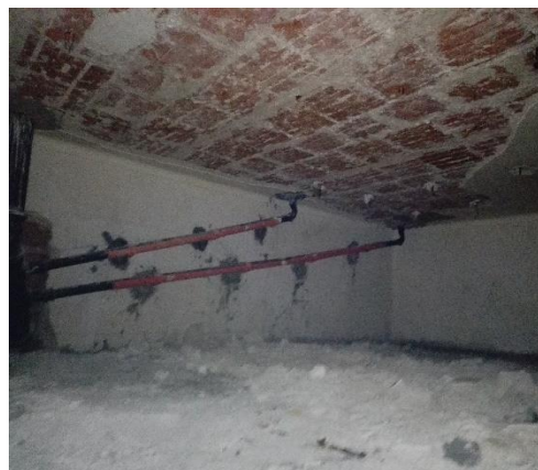
Figura 40 – Destacamento do Revestimento da Laje aligeirada
