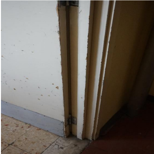
Figura 64 – Deterioração da porta de madeira
