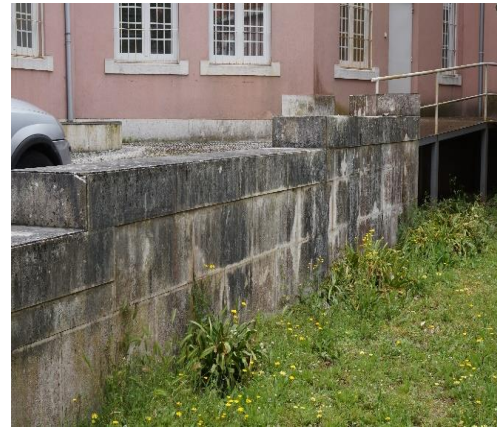
Figura 85 - Colonização biológica, manchas negras e sujidade na pedra de calcário
