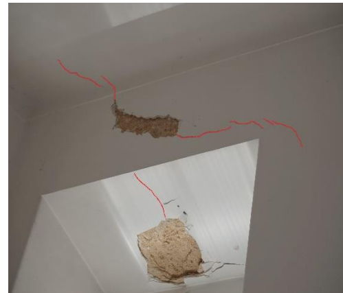
Figura 21 – Fissura no revestimento de estuque
