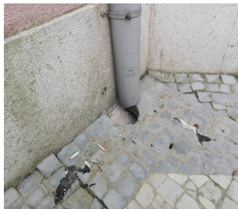
Figura 89 – Posicionamento deficiente do tubo de queda
