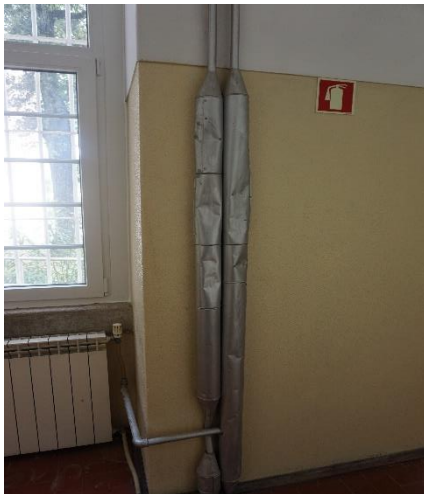
Figura 57 – Deformação das redes de abastecimento de água quente
