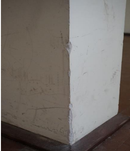
Figura 27 – Destacamento do revestimento na empena da parede
