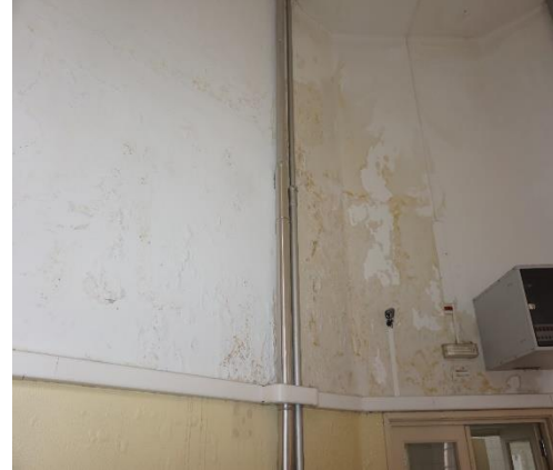
Figura 37 – Manchas de humidade na parede
