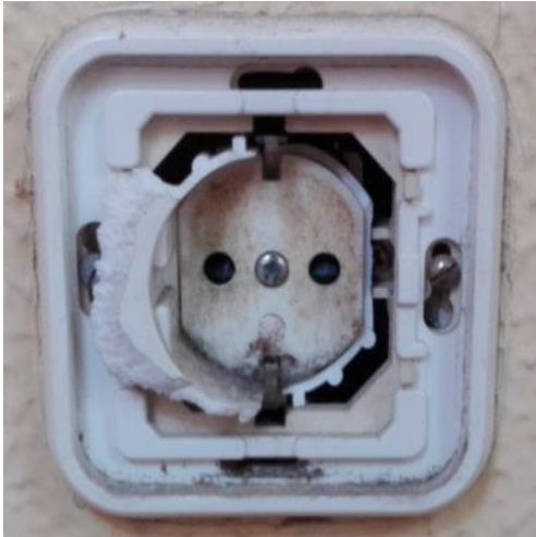
Figura 72 – Sinais de colisão no espelho da tomada elétrica
