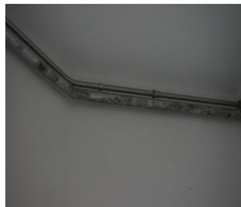
Figura 55 - Oxidação das Redes de abastecimento de água
