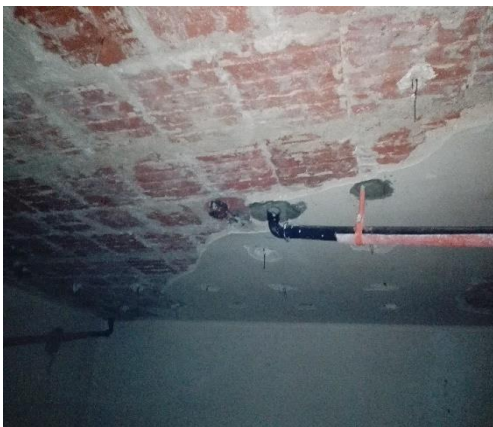
Figura 39 – Destacamento do Revestimento da Laje aligeirada
