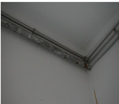
Figura 54 - Oxidação das Redes de abastecimento de água
