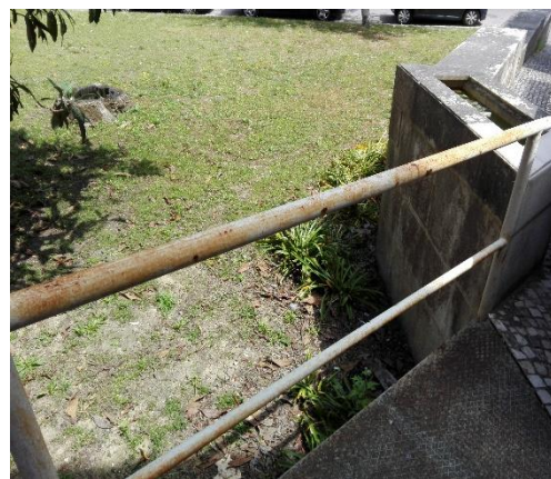
Figura 79 - Oxidação do corrimão
