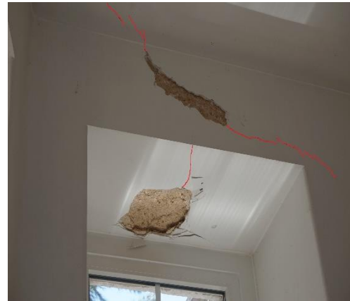
Figura 19 – Fissura no revestimento de estuque
