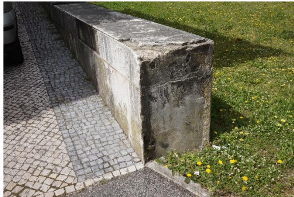
Figura 86 – Colonização biológica, manchas negras, destacamento e sujidade na pedra de calcário
