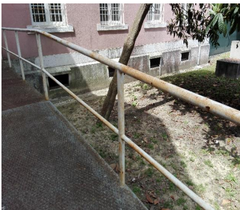
Figura 78 – Oxidação do corrimão
