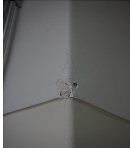
Figura 28 – Destacamento do revestimento na empena da parede
