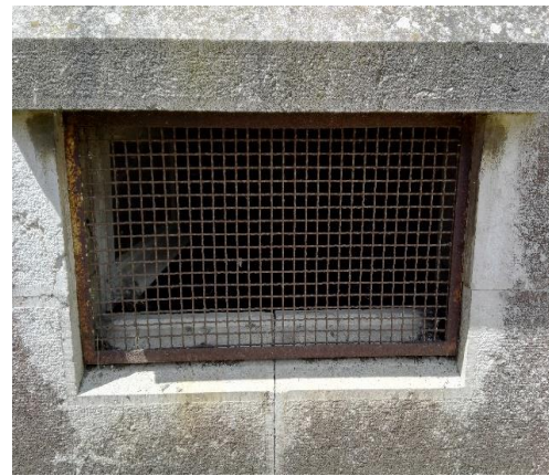
Figura 76 – Oxidação do gradeamento da janela da cave
