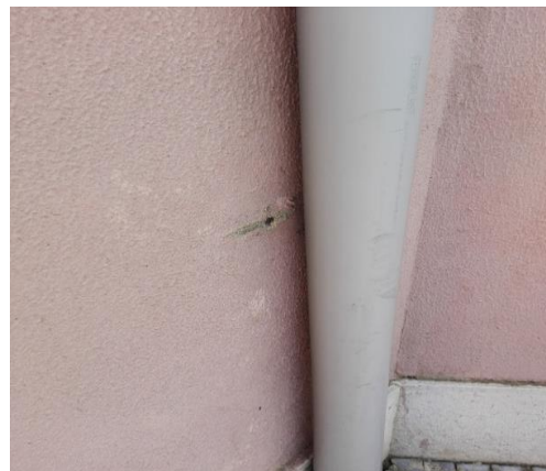
Figura 91 – Sinais de colisão do tubo de queda
