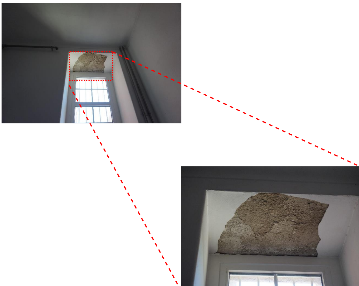
Figura 23 – Destacamento do revestimento de estuque numa instalação sanitária
