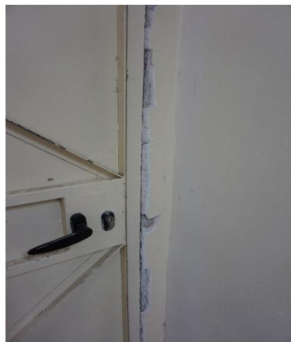
Figura 26 – Destacamento do Reboco na periferia da porta
