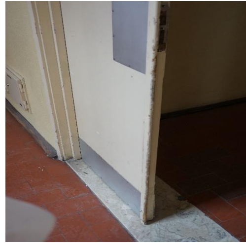
Figura 65 – Deterioração da porta de madeira
