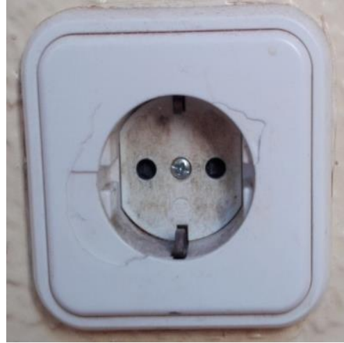
Figura 73 - Sinais de colisão no espelho da tomada elétrica
