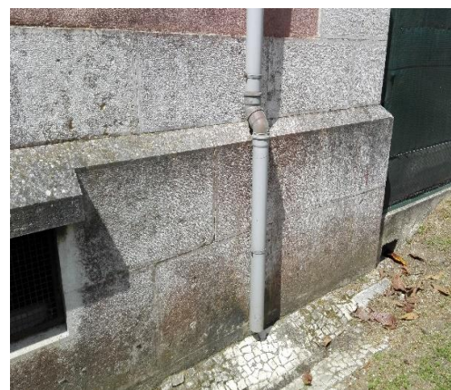
Figura 82 – Colonização biológica, manchas negras e sujidade na pedra de Lioz
