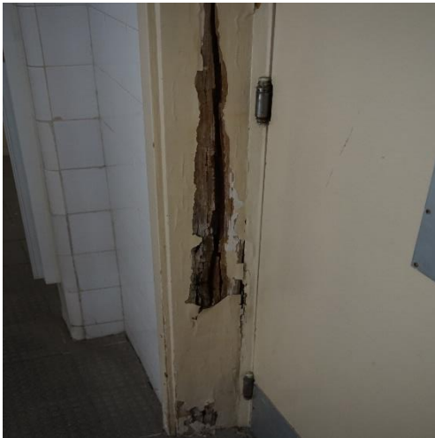
Figura 62 – Apodrecimento do aro da porta de madeira
