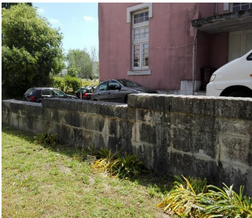
Figura 84 – Colonização biológica, manchas negras e sujidade na pedra de calcário
