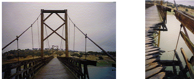
Figura 1. Ponte antiga, em madeira, onde se evidencia a parte queimada do tabuleiro.
