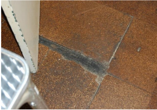
Figura 3.20 - Destacamento da cortiça [JC,NQ].
