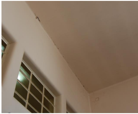
Figura 3.27 - Fendas no teto do hall nº 13 [JC, NQ].
