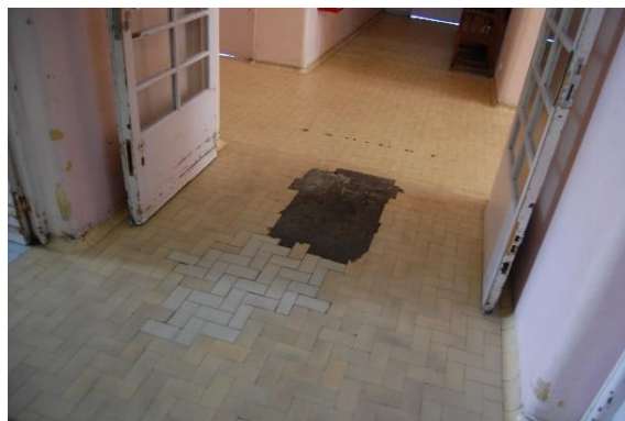
Figura 3.19 - Pavimento degradado [JC, NQ].
