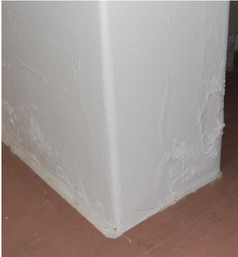
Figura 3.36 - Criptoflorescências nas paredes da cave [JC, NQ].
