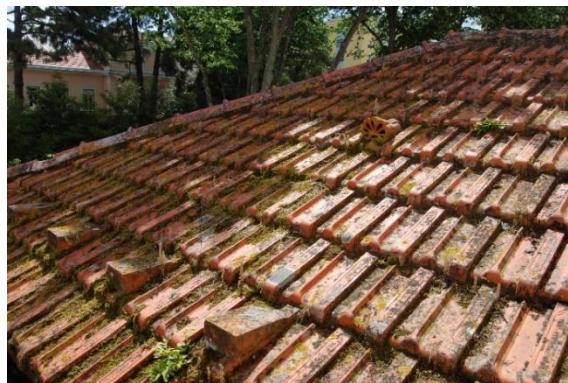
Figura 3.18 - Colonização biológica sobre a cobertura [JC, NQ].
