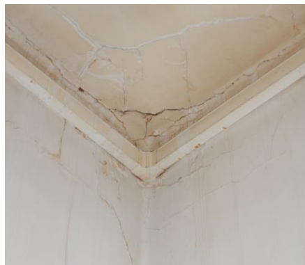
Figura 3.40 - Fendas na Ala Central do Piso 1 [JC, NQ].
