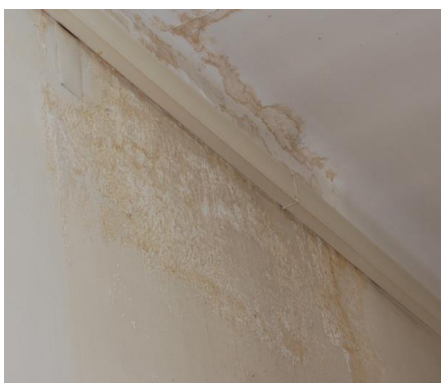
Figura 3.41 - Eflorescências na Ala Direita do Piso 1 [JC, NQ].
