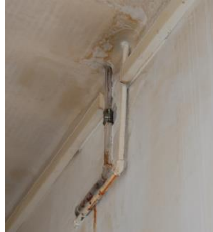
Figura 3.45 - Manchas de humidade devido à canalização [JC, NQ].
