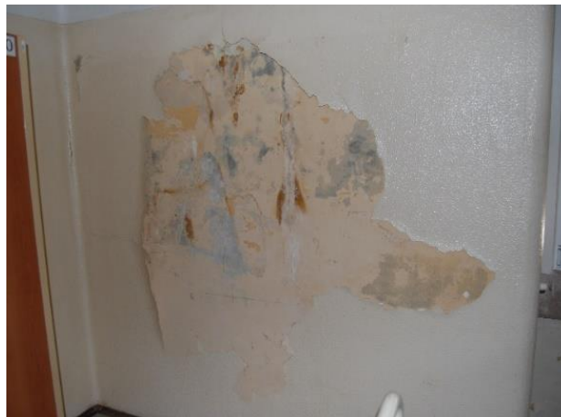
Figura 3.46 - Destacamento do revestimento devido a infiltrações pela fachada [JC, NQ].
