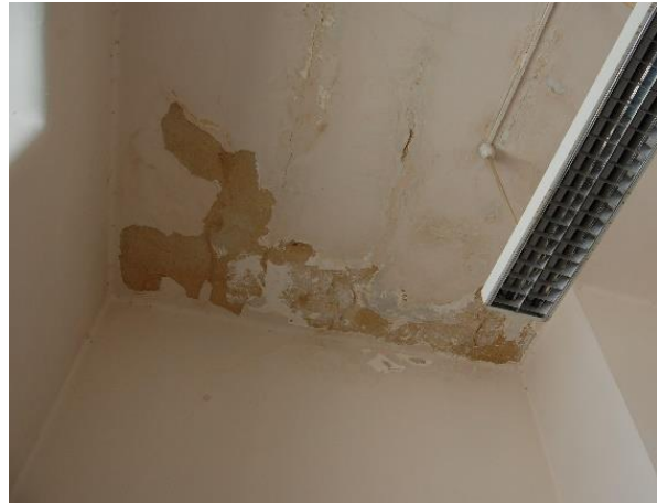
Figura 3.39 - Destacamento da pintura devido a infiltrações pela cobertura [JC, NQ].
