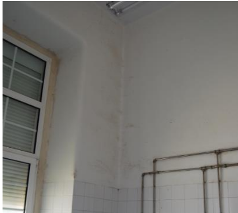
Figura 3.43 - Humidade de condensação na casa de banho [JC, NQ].
