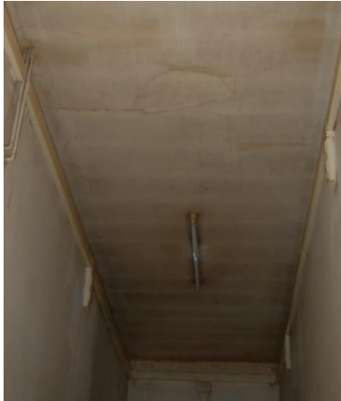
Figura 3.38 - Humidade na Ala Central do Piso 1 [JC, NQ].
