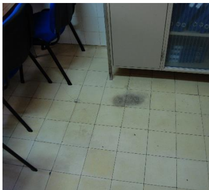
Figura 3.23 – Manchas escuras sobre o revestimento [JC, NQ].
