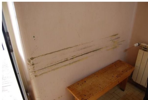
Figura 3.32 - Abrasão provocada pela régua de proteção [JC, NQ].
