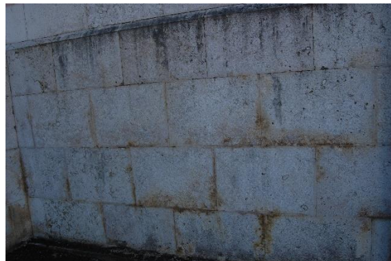
Figura 3.12 - Eflorescências salinas nas placas de pedra [JC, NQ].
