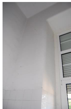
Figura 3.26 - Fissuras na instalação sanitária nº 7 [JC, NQ].
