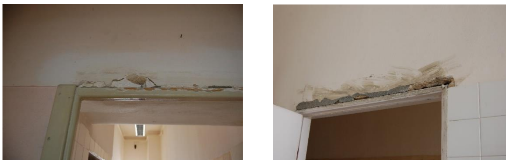
Figura 3.34 - Destacamento da argamassa [JC, NQ].
