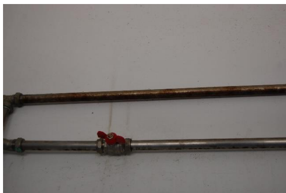
Figura 3.54 - Canalização oxidada [JC, NQ].
