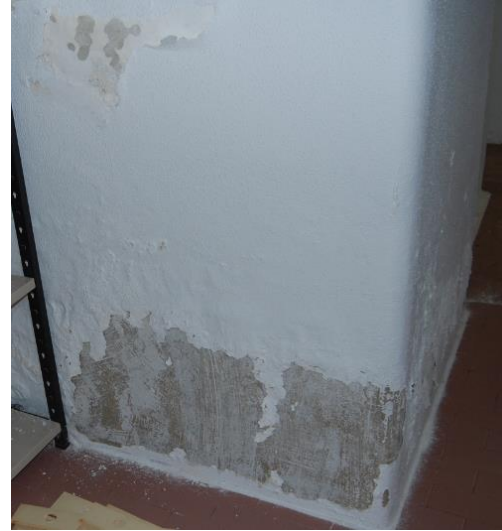
Figura 3.37 – Destacamento da pintura [JC, NQ].
