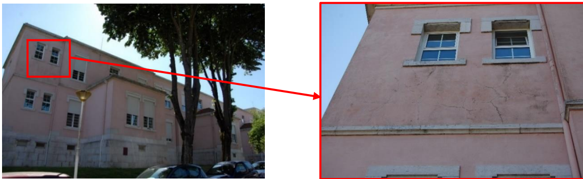
Figura 3.9 – Fendas no reboco [JC,NQ].
