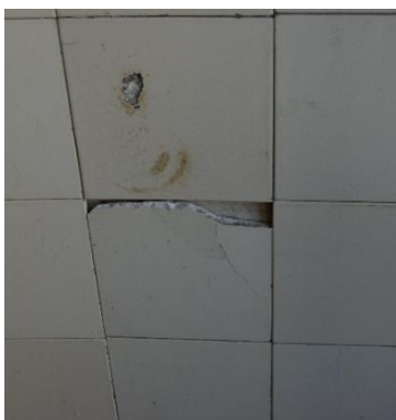
Figura 3.49 - Fratura dos azulejos na Circulação da Copa [JC, NQ].
