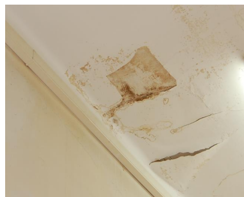
Figura 3.42 - Destacamento do revestimento do teto na Ala Direita do Piso 1 [JC, NQ].
