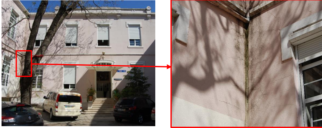
Figura 3.17 - Formação de musgos junto ao tubo de queda [JC, NQ].
