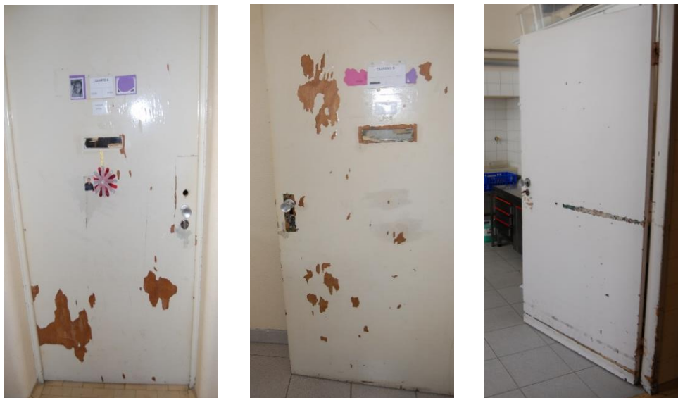
Figura 3.52 - Degradação das portas [JC, NQ].
