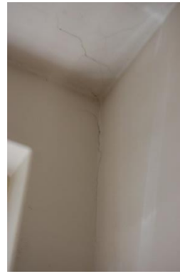
Figura 3.28 - Fendas no teto e parede do gabinete nº 23 [JC, NQ].
