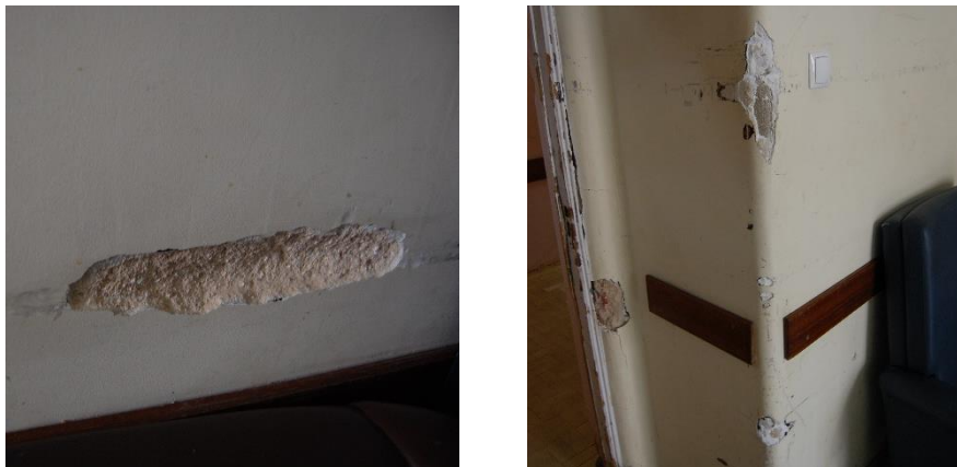
Figura 3.33 - Destacamentos do reboco [JC, NQ].
