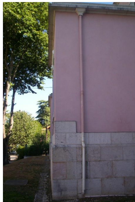
Figura 3.56 - Tubos de queda [JC, NQ].
