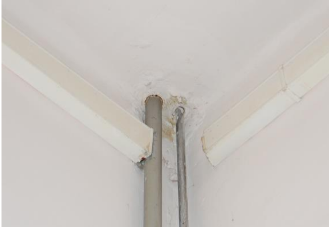
Figura 3.44 - Criptoflorescências devido à rotura da canalização [JC, NQ].
