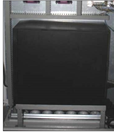
FIGURA 181 - UNIDADE DE RESERVA DE ENERGIA ELÉTRICA
