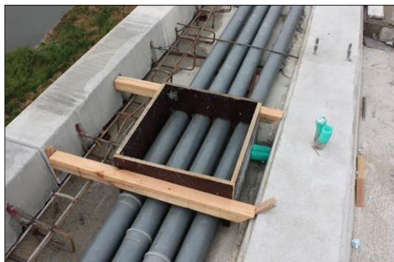
FIGURA 170 - TUBAGEM E CAIXA TÉCNICA
