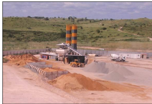
FIGURA 196 - CENTRAL DE BETÃO
