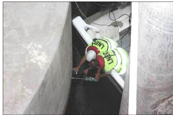
FIGURA 183 - SONAR AUTOMÁTICO PARA REGISTO DE EROSÕES LOCALIZADAS, COLOCADO NO MACIÇO DE ENCABEÇAMENTO DO PILAR P8
