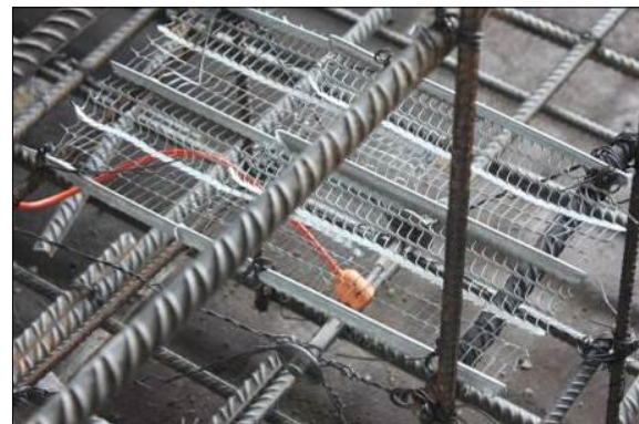
FIGURA 179 - EXTENSÓMETRO DO INTERIOR DO BETÃO
