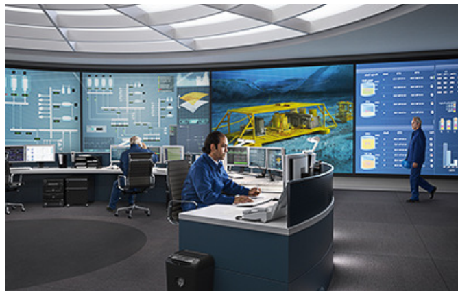
Figura 4.1 Exemplo de sala de controlo com painéis HMI e estações de controlo MTU (Siemens)
