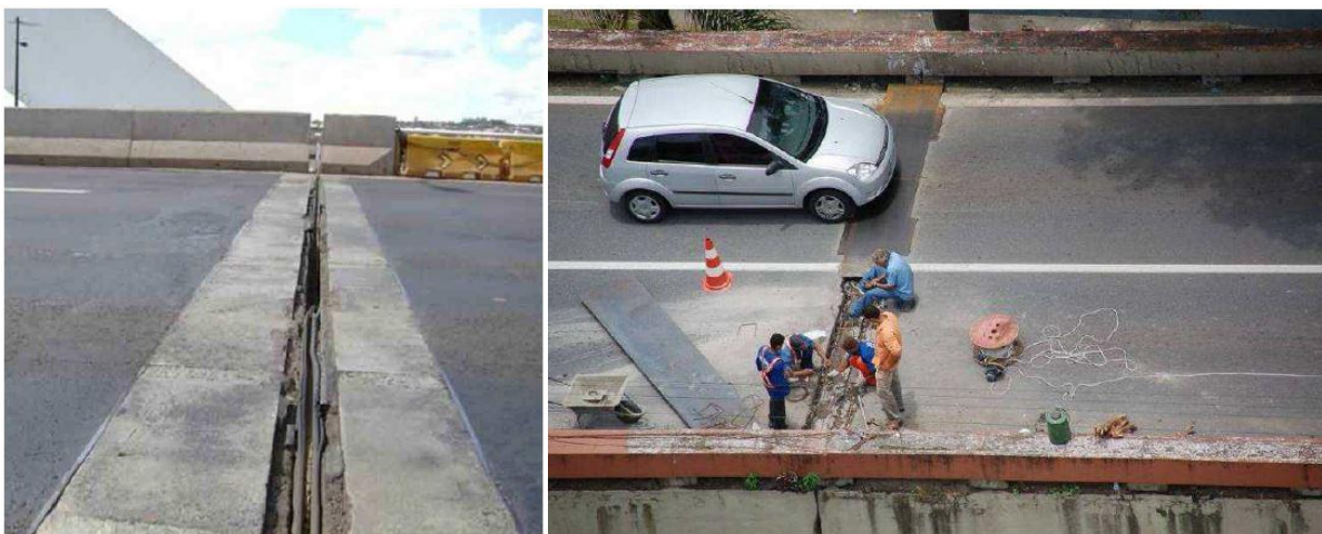
Figura 2- a) Junta de dilatação degradada [13]; b) Substituição de uma junta de dilatação [13]
