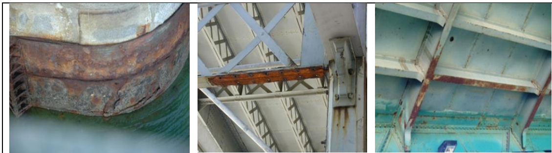
Figura 73 – Exemplos de Corrosão Uniforme [47].
