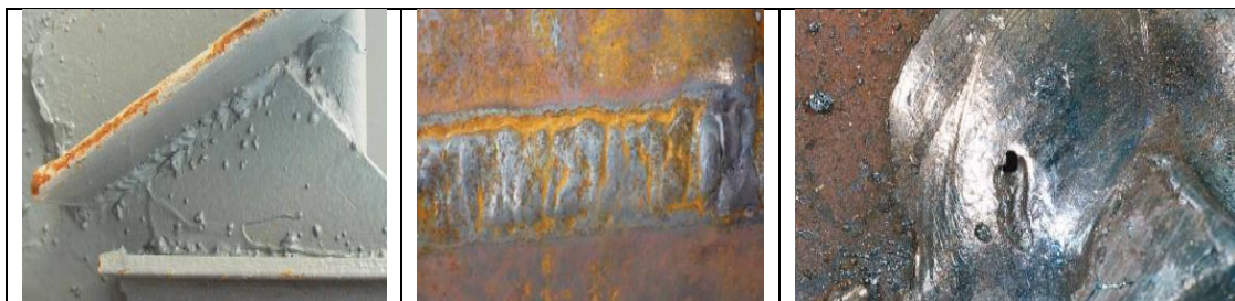
Figura 72 – Defeitos de soldadura detectados.
