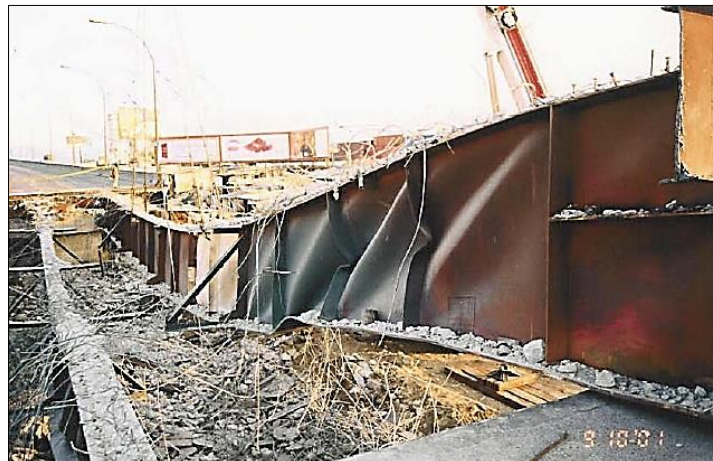
Figura 77 – Incêndio sobre a Ponte Rodoviária no Rio de Janeiro.
