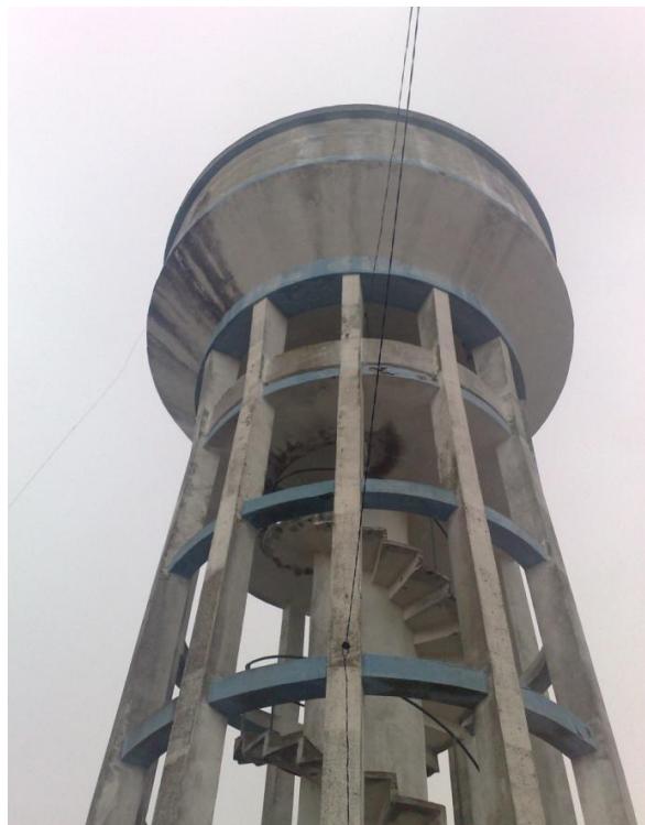
Figura A 15 - Reservatório elevado do sistema de abastecimento de Póvoa da Isenta – Arquivo da A.S.
