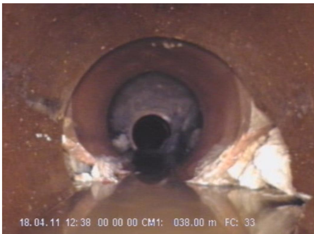
Figura 3.14 - Colector danificado sob a Rua Doutor Virgílio Arruda, Santarém – Arquivo Pessoal
