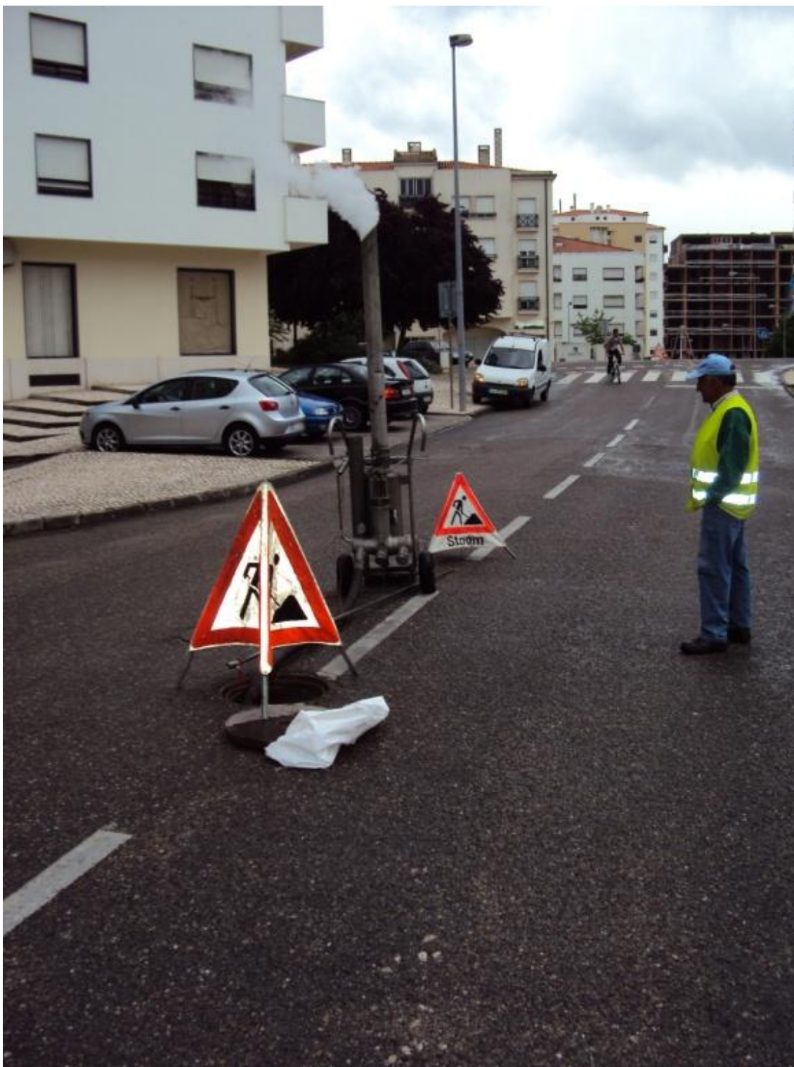
Figura E 10 - Extremidade final do colector. Equipamento de vapor de água – Arquivo Pessoal
