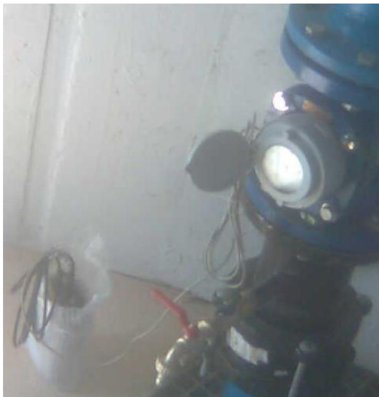
Figura 3.6 - Datalogger ligado à conduta de abastecimento – Arquivo Pessoal
