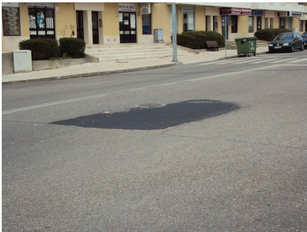
Figura 3.13 - Abatimento do pavimento betuminoso da Avenida Madre Andaluz, Santarém – Arquivo Pessoal
