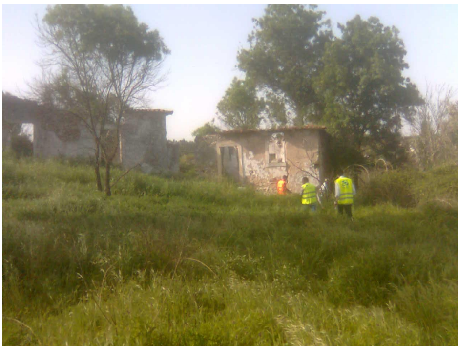
Figura 3.5 - Acompanhamento da piquetagem da directriz do emissário de Amiais de Cima – Arquivo Pessoal
