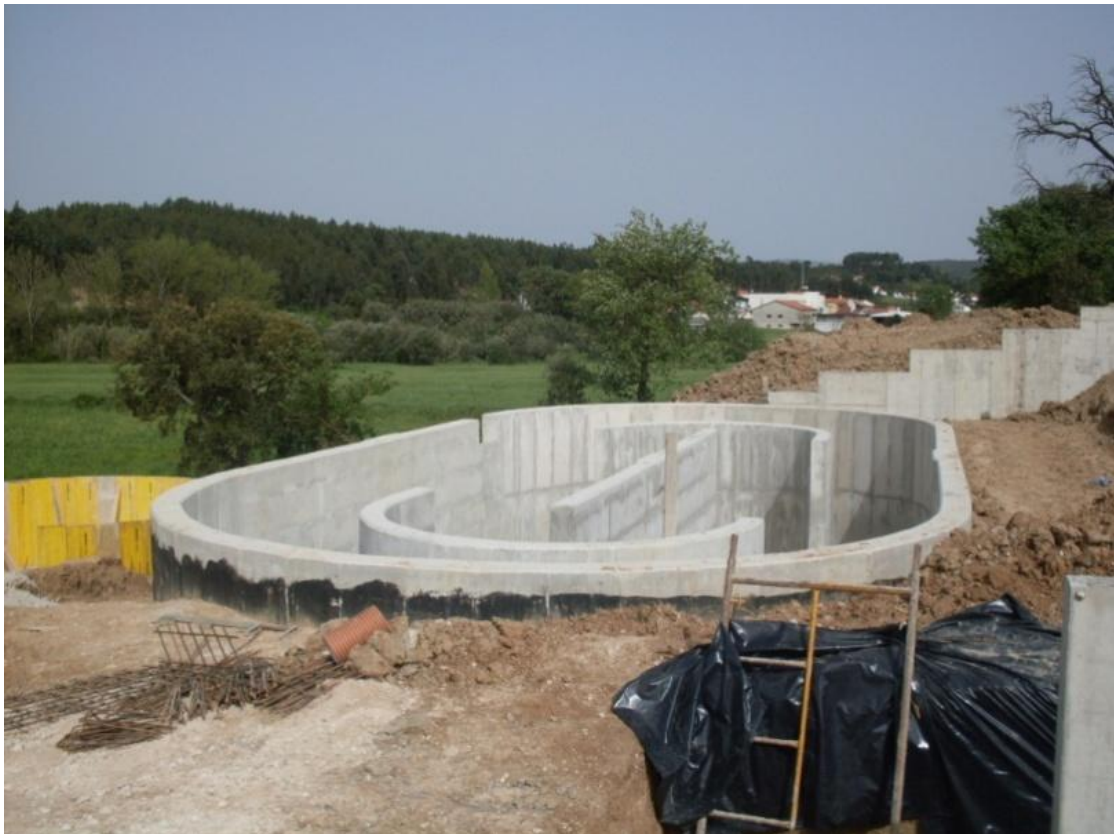
Figura 3.4 - Vala de oxidação – Arquivo Pessoal
