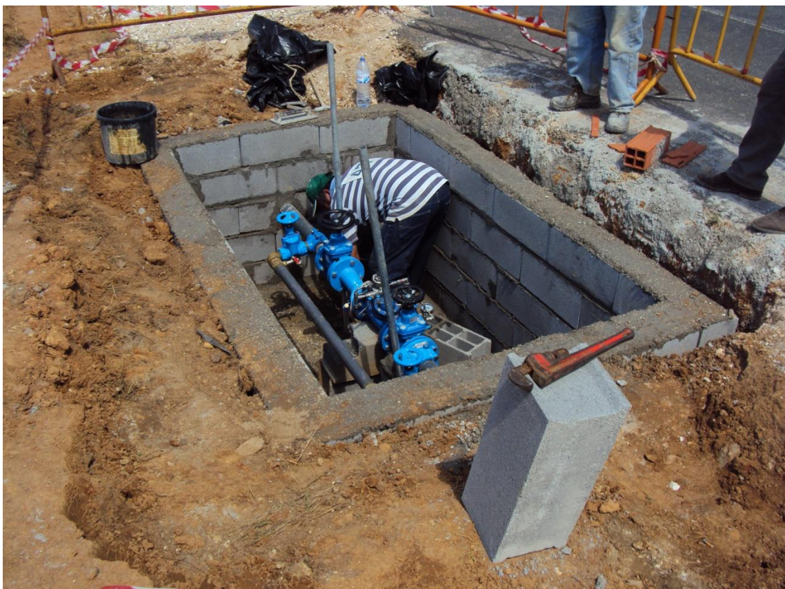
Figura D 4 - Vista geral da instalação da VRP (Casais da Charneca) – Arquivo Pessoal
