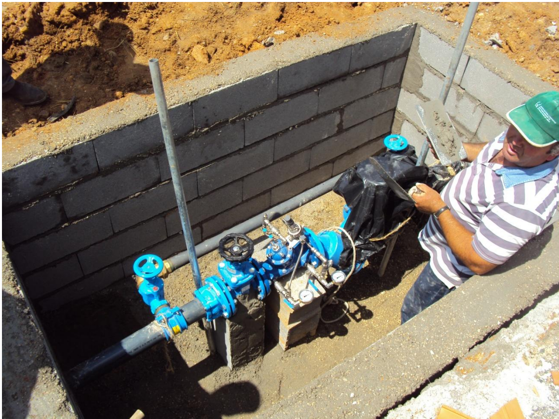
Figura D 3 - Construção da caixa envolvente da VRP (Casais da Charneca) – Arquivo Pessoal
