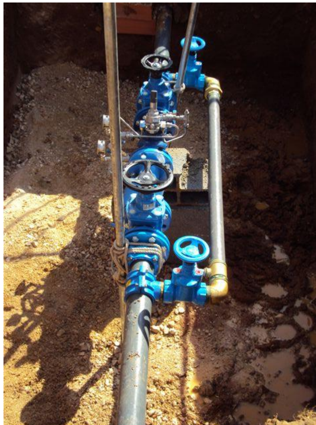
Figura D 2 – VRP instalada, vista longitudinal (Casais da Charneca) – Arquivo Pessoal
