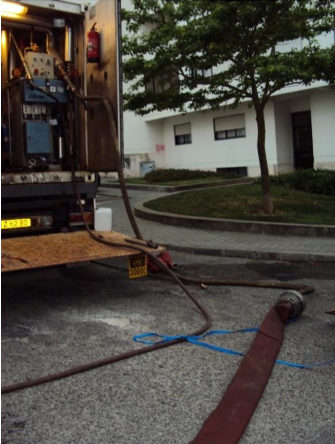
Figura E 11 - Mangueira de vapor de água ligada à mangeira de inversão especial – Arquivo Pessoal
