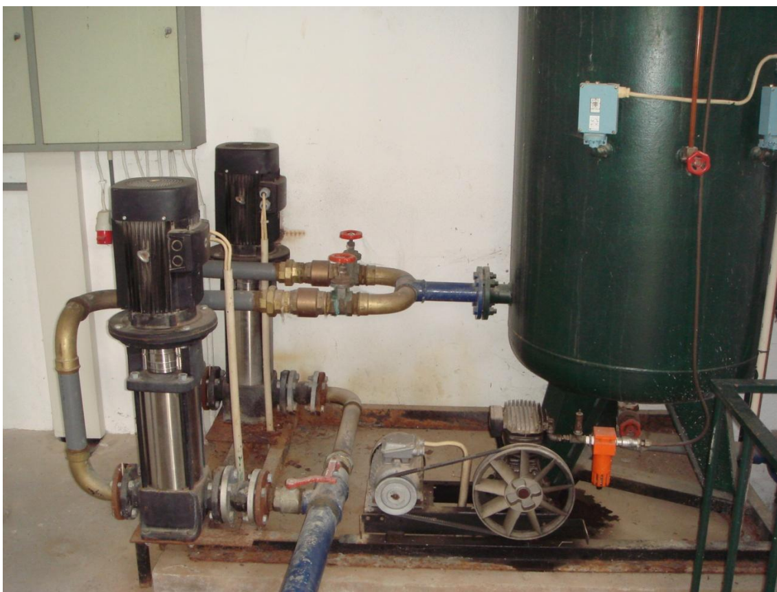
Figura A 17 - Equipamentos do sistema de abastecimento de Romeira – Arquivo da A.S.
