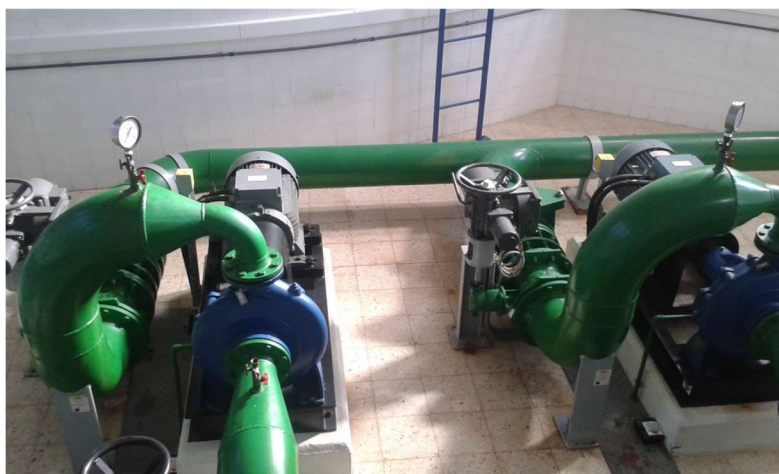
Figura 118 – Sala dos grupos elevatórios da estação elevatória de Madeiras (abril de 2016)
