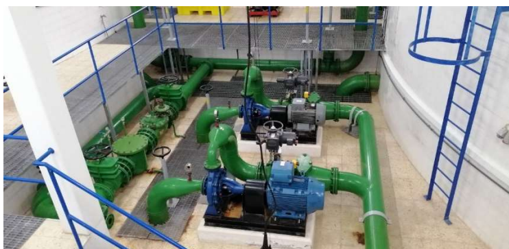
Figura 122 – Sala dos grupos elevatórios da estação elevatória de Madeiras (julho de 2016)
