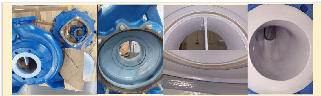
Figura 81 – INSP_05-1 com imagens do revestimento da voluta da bomba
