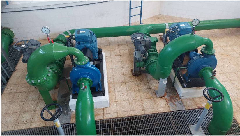
Figura 123 – Sala dos grupos elevatórios da estação elevatória de Madeiras (agosto de 2023)
