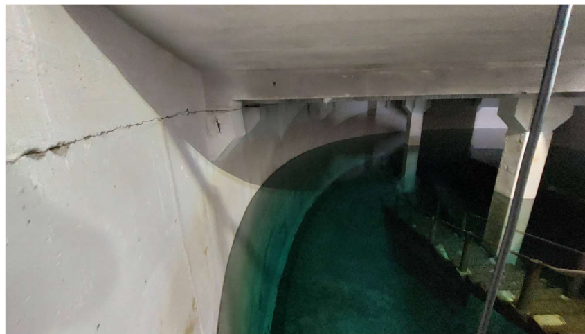
Figura 116 – Reservatório de Curvaceiras com fissura visível em todo o perímetro
