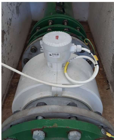
Figura 68 – Elemento primário do medidor de caudal após colocação em serviço
