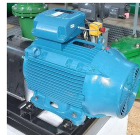
Figura 73 – Motor WEG instalado na EE Madeiras Grupo 2
