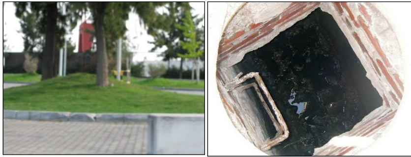
Figura 2.4.18 – Vista geral do parque de estacionamento localizado entre a discoteca “K” e os estaleiros “Naval Rocha” (à esquerda) e, do colector pluvial de secção 900 mm x1350 mm (à direita).
