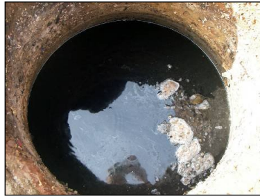
Figura 2.4.6 - Caixa inicial do colector pluvial que se desenvolve ao longo da Rua da Cintura do Porto de Lisboa
