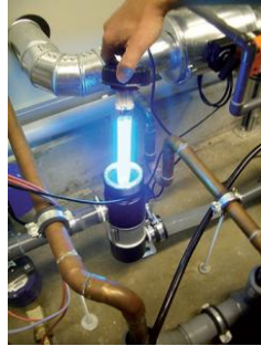
Figura 30 - Tratamento de desinfecção U.V
