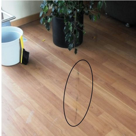
Fig. 67 - Exemplo de manchas em revestimento vinílico de pavimentos
