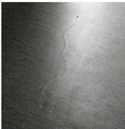
Fig. 71 - Anomalia superficial por fendilhação do suporte
