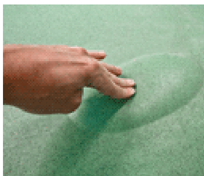
Fig. 68 - Exemplo de um revestimento vinílico com empolamento (AQC, 2011)
