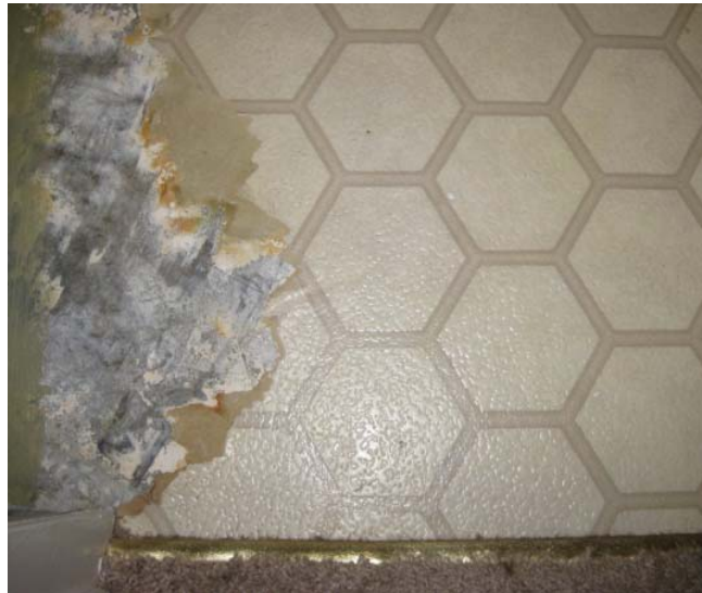
Fig. 73 - Exemplo de descamação em revestimentos vinílicos (Diychatroom.com, 2011)
