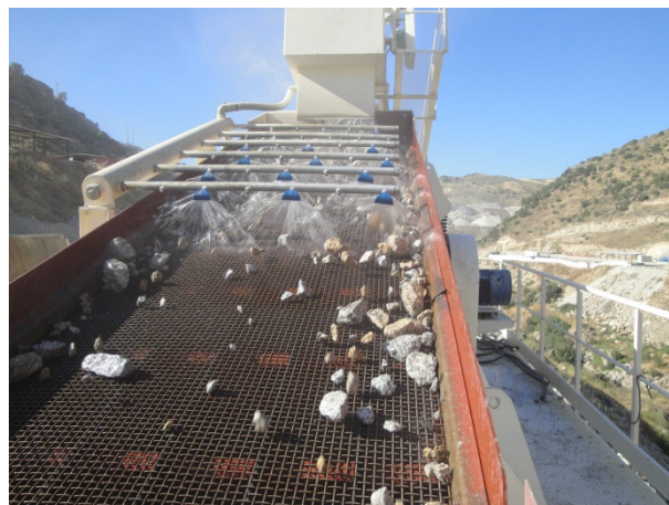
Figura 84 – Sistema de lavagem de agregados.
