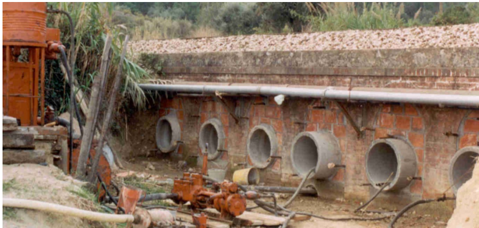
Figura 8 – Reparação de arcos de alvenaria junto à estação ferroviária de Santarém (Fonte: Teixeira Duarte).
