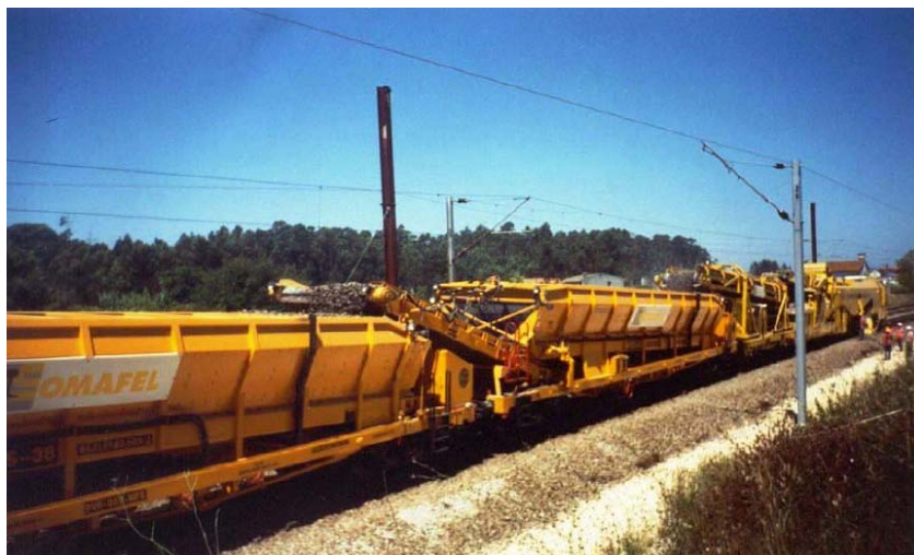
Figura 78 – Equipamento de desguarnecimento mecânico da via e respetivos vagões para armazenagem temporária de balastro.
