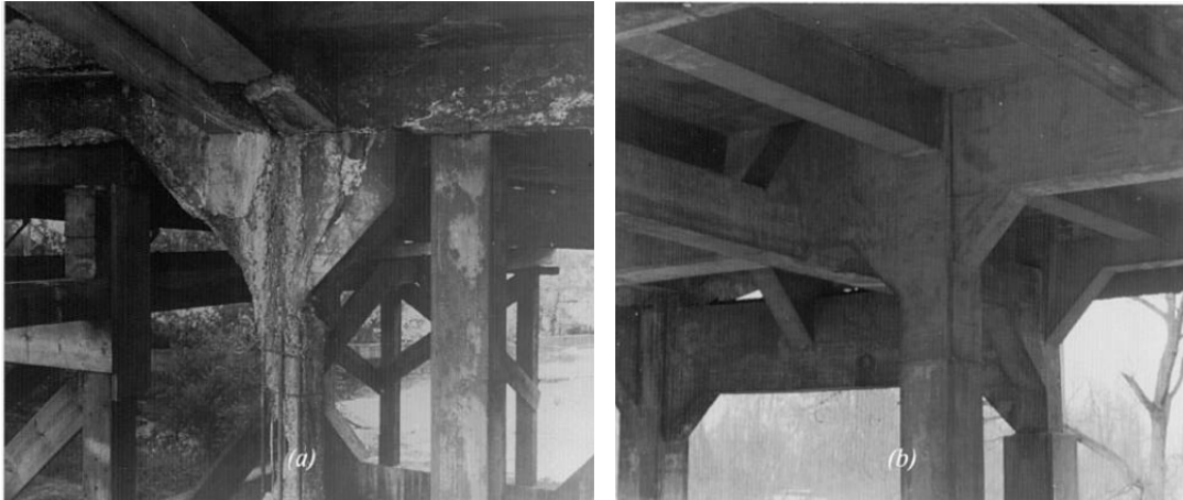
Figuras 21 e 22 – Pilares e vigas na West 6th Street Viaduct, Erie, Pennsylvania antes da reparação (a) e 26 anos após reparação (b) com betão com pré-colocação de agregados (Fonte: ACI 304.1 R-92, 1997).
