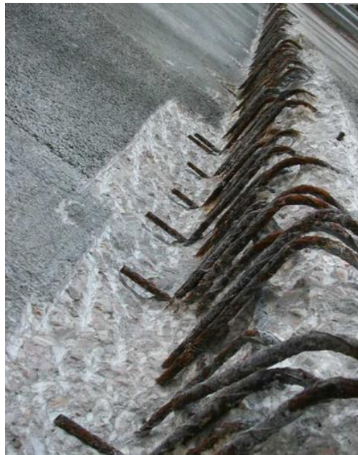
Figura 44 – Zona degradada. (stap.pt)
