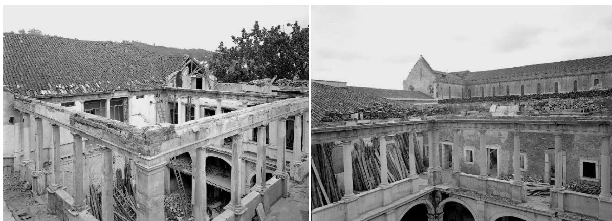
Figura 50 – Alterações com soluções deficientes – Alterações com soluções mal aplicadas (fotos do arquivo da DGPC).
