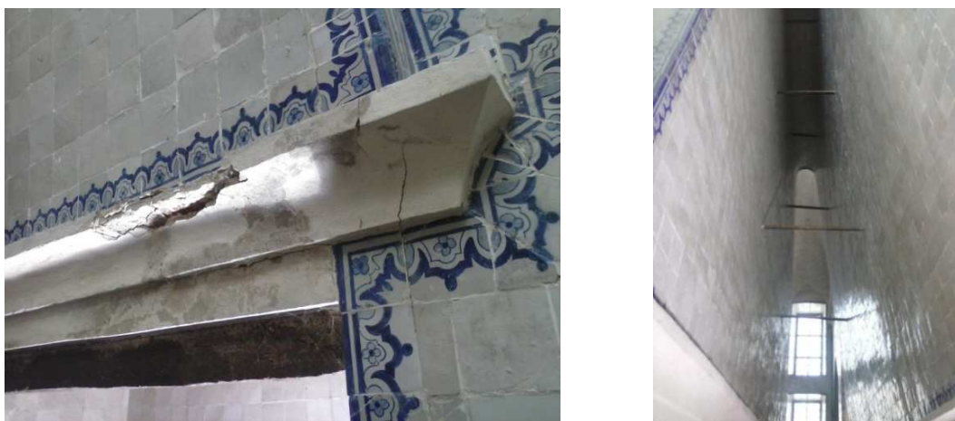
Figura 28 – Elementos metálicos com corrosão nas argamassas e na pedra.
