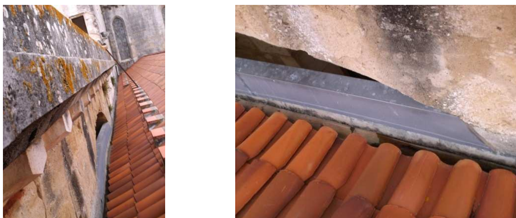
Figura 55 – Alterações inadequadas, mas também com fraca drenagem e pouca pendente da caleira.
