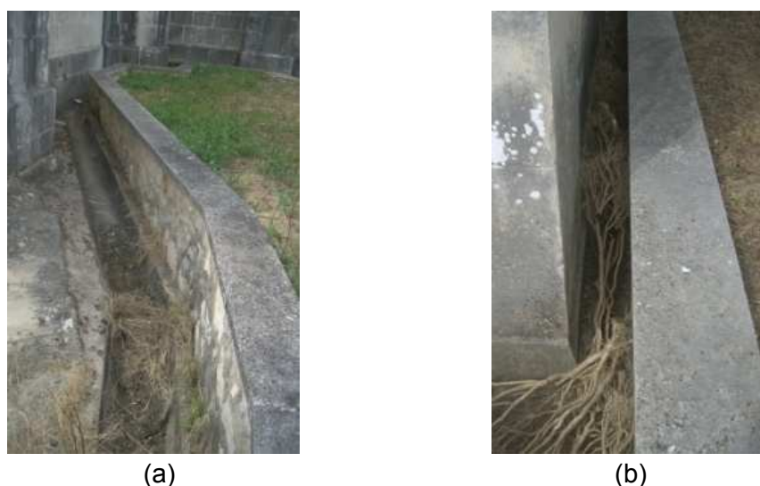
Figura 40 – Drenagem periférica do lado Sul da Igreja.
