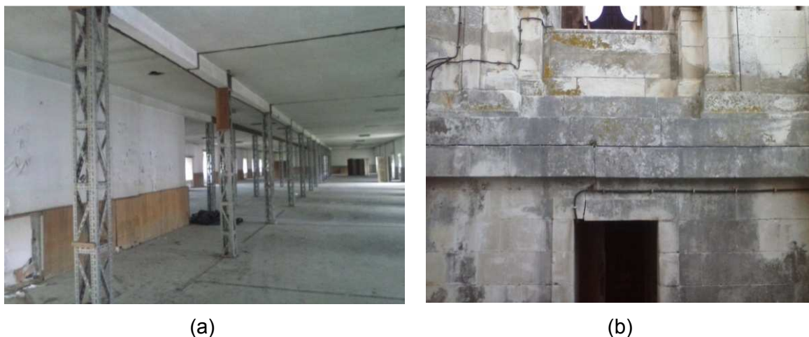
Figura 64 – (a) Compartimento interno do Claustro do Cardeal e (b) fractura de uma verga da porta de entrada numa das torres sineiras.
