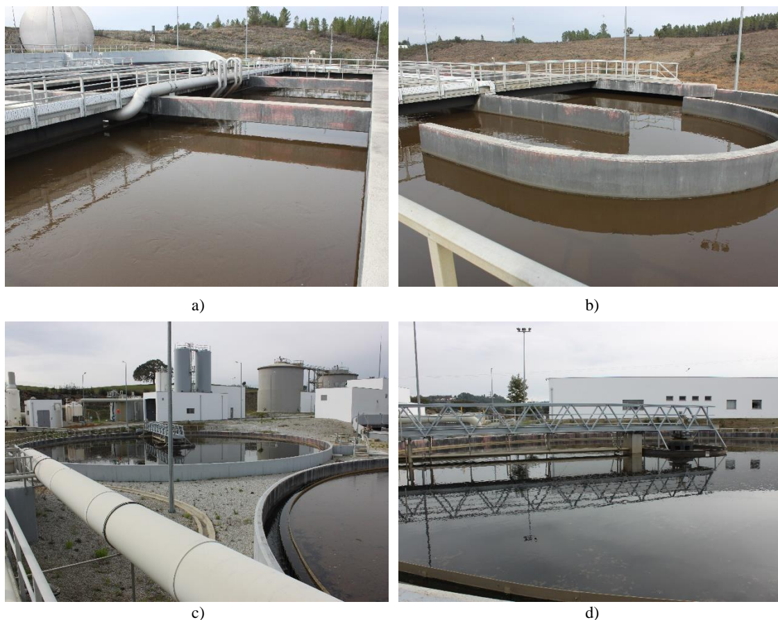
Figura 16. Tratamento Secundário ETAR de Castelo Branco: a) vala de oxidação - vista lateral, b) vala de oxidação - vista frontal, c) decantadores e d) ponte raspadora
