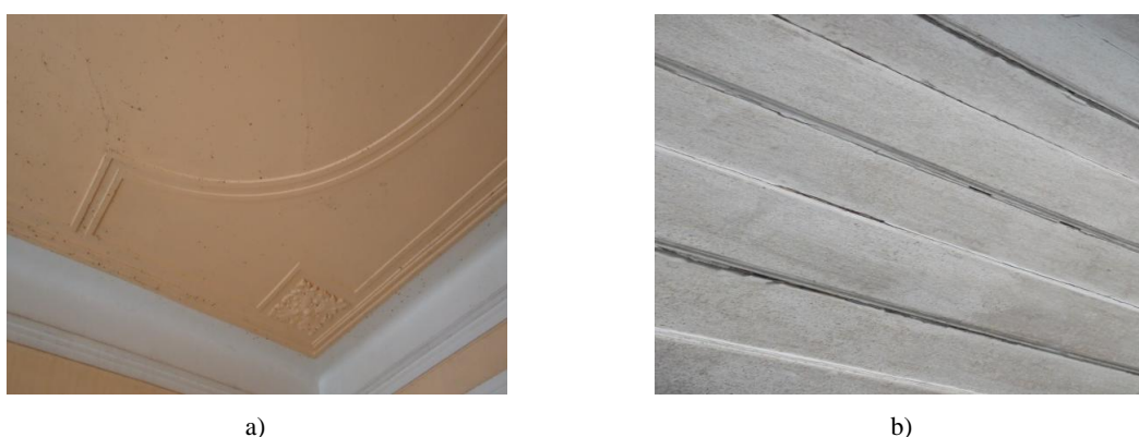
Figura 3.9 – Tecto característico das fracções: a) Acabamento em estuque; b) Acabamento em pranchas de madeira
