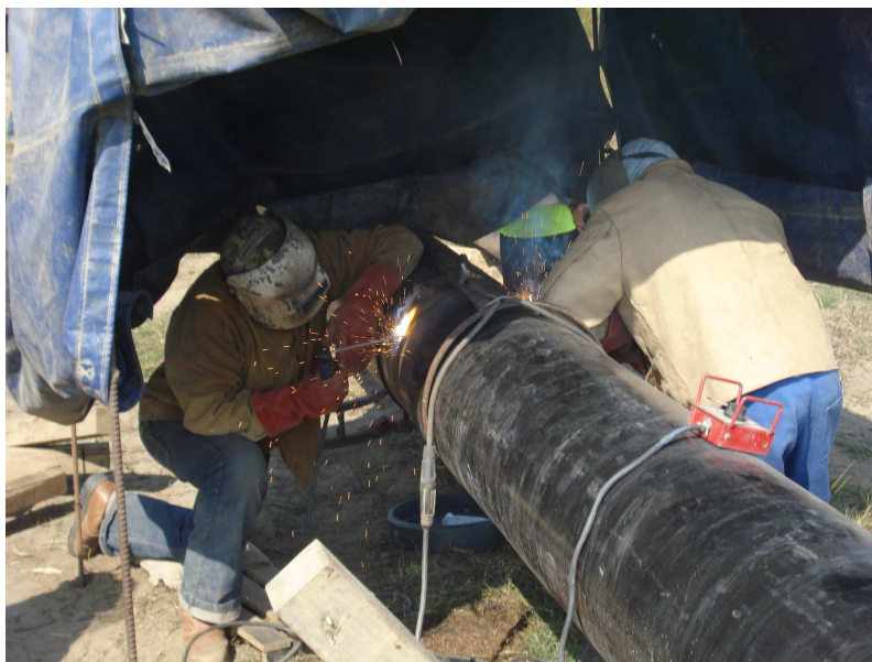
Figura 27 – Execução de soldadura em obra por eléctrodo revestido em tubo com 500mm 65 de diâmetro
