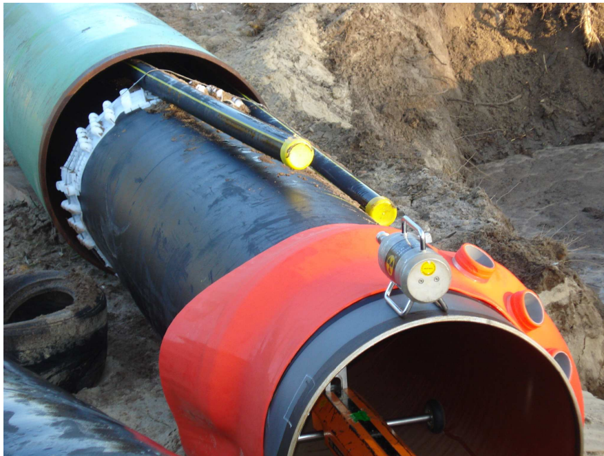
Figura 24 – Colocação de tubagem com espaçador e cabodutos de fibra óptica, em manga de atravessamento
