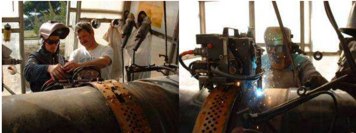
Figura 26 – Equipamento de soldadura no interior de cada cabine
