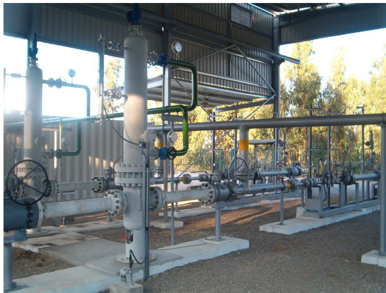
Figura 41 – Vista geral de uma estação de gás “GRMS”
