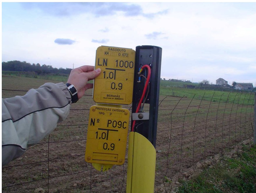
Figura 44 – Instalação de uma Tomada de Potencial para sinalização do Gasoduto e recolha do potencial de Protecção Catódica
