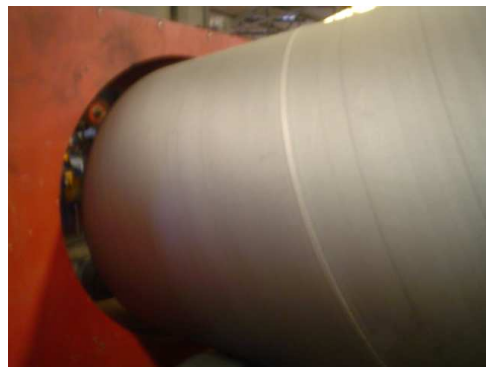
Figura 12 - Preparação da superfície, com inserção do tubo em máquina para limpeza por jacto de areia
