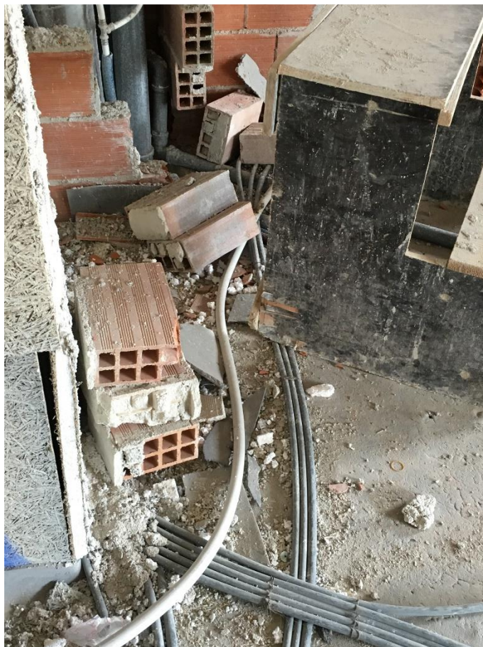
Figura 2-44 – Entulho e materiais sobre tubagens
