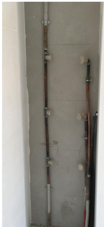
Figura 2-16 – Coluna de distribuição de gás
