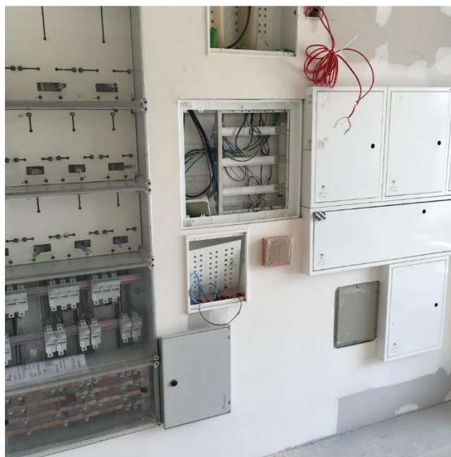
Figura 2-17 Quadro de serviços comuns principal
