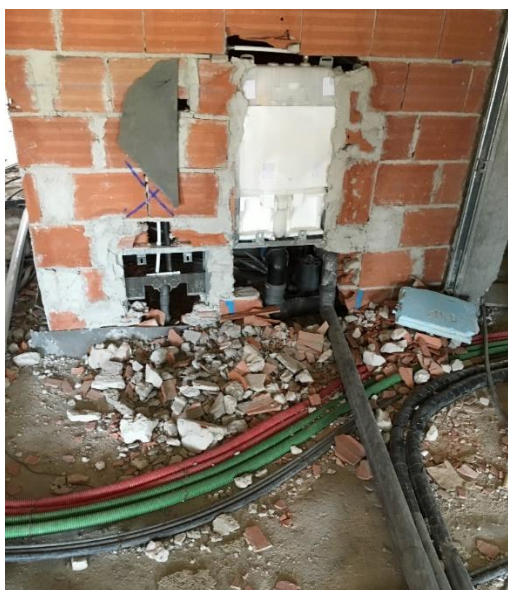
Figura 2-43 – Entulho dos roços por cima das tubagens
