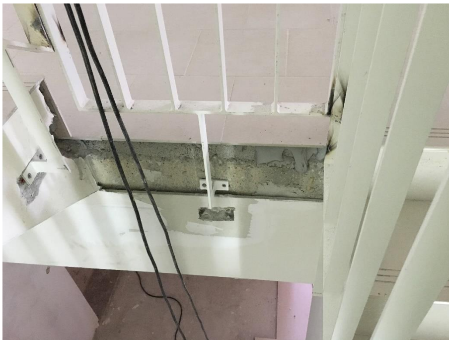
Figura 2-24 – Pormenor da fixação remendada da guarda
