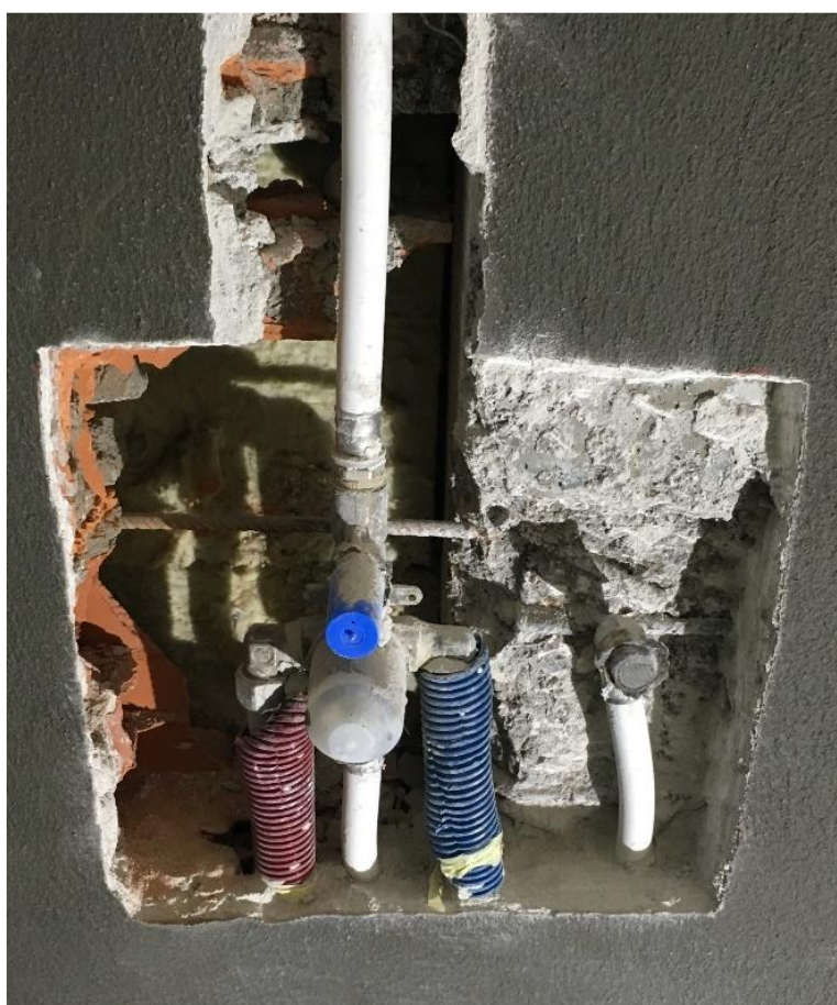
Figura 2-81 – Aspeto de uma zona onde o encastrável foi removido da parede
