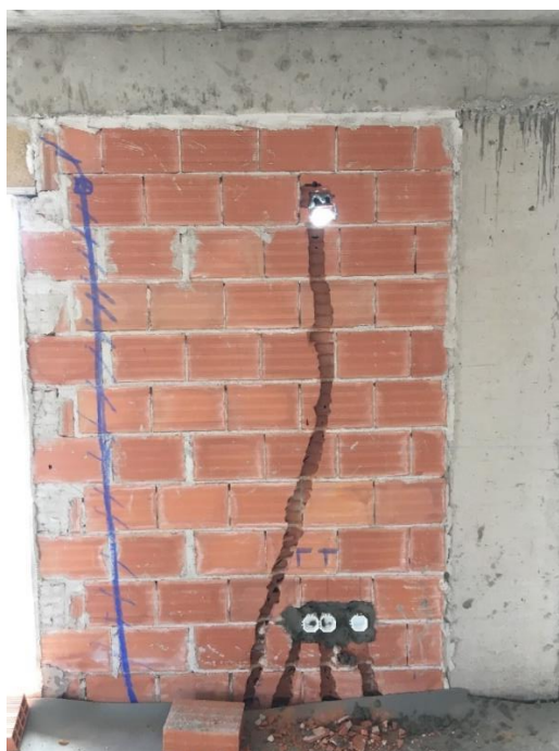
Figura 2-37 – Roços abertos incorretamente
