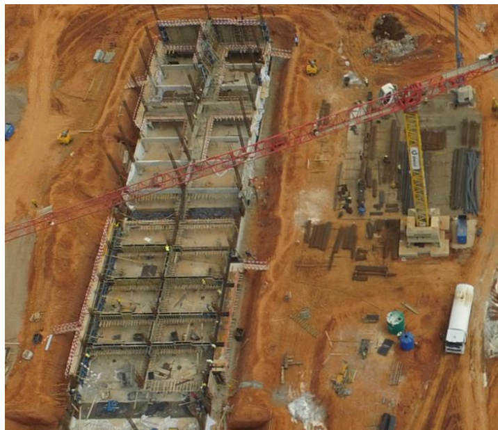
Figura 4.41 – Pormenor da armação e cofragem das paredes e pilares ao nível 0,30 → 4,80m para o bloco A da torre de arrefecimento #1 da CCC do Soyo.
