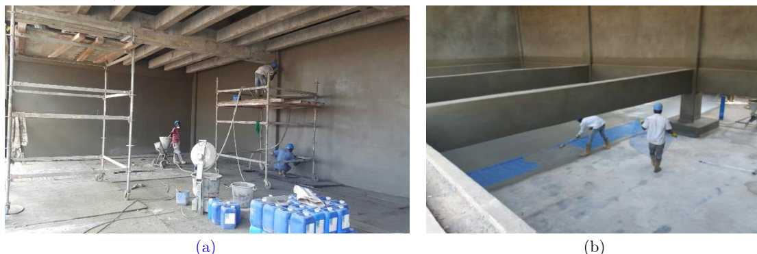
Figura 4.63 – (a) Aplicação da 2ª camada em paredes em uma das Torres da CCC do Soyo; (b) Aplicação da 2ª camada sobre a rede em pavimento numa das Torres da CCC do Soyo.
