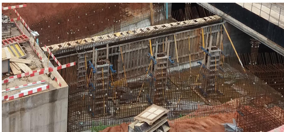
Figura 4.53 – Armação e cofragem dos pilares-guia do Troço-D da Culvert da CCC do Soyo.
