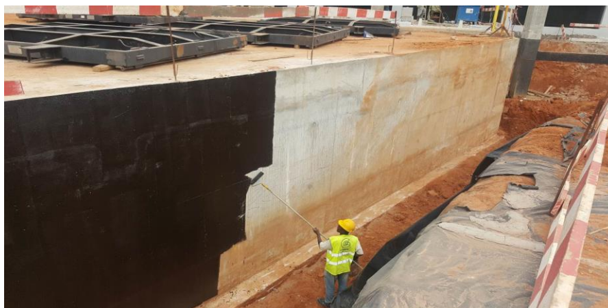
Figura 4.56 – Impermeabilização da parede exterior do Troço-B da Culvert da CCC do Soyo.
