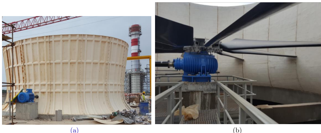
Figura 4.30 – (a) Imagem de um dos motores no exterior de uma das torres de arrefecimento da CCC do Soyo; (b) Imagem do interior de uma das torres de arrefecimento da CCC do Soyo.
