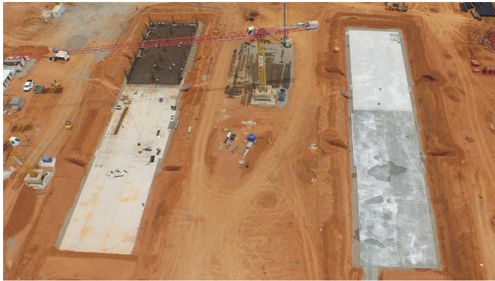
Figura 4.39 – Colocação de armadura para a laje do fundo para o bloco A da torre de arrefecimento #1 da CCC do Soyo.
