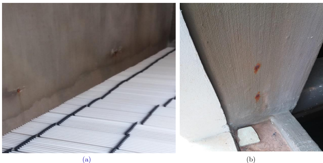
Figura 5.3 – (a) Dois pontos com pontas de armadura à vista numa parede à cota 11,30m da CCC do Soyo; (b) Dois pontos com pontas de estribo à vista num pilar à cota 0m da CCC do Soyo.
