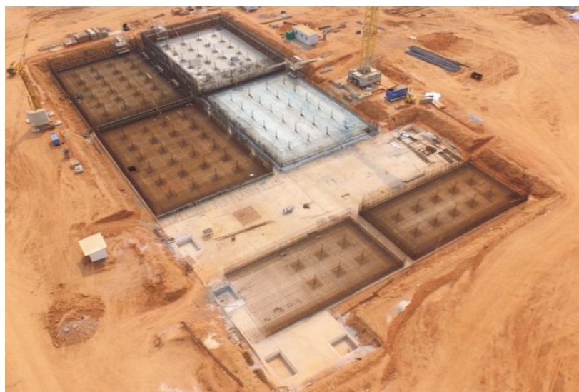
Figura 4.27 – Betonagem e cura para os tanques de água da CCC do Soyo.
