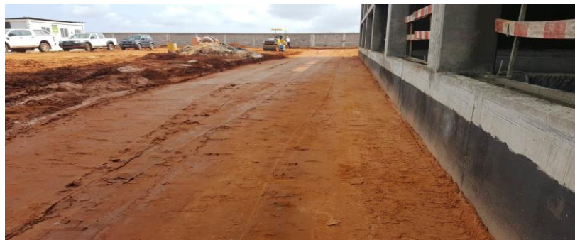
Figura 4.45 – Pormenor da compactação da penúltima camada de aterro para o bloco A da torre de arrefecimento #1 da CCC do Soyo.
