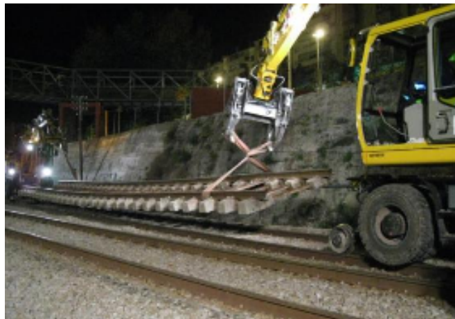
Figura 3-2 - Tramo de via levantado [35]
