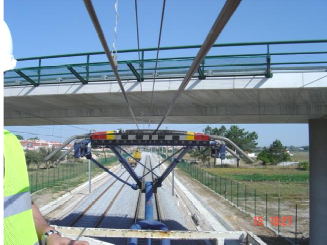
Figura 3-27 - verificação do desalinhamento [35]
