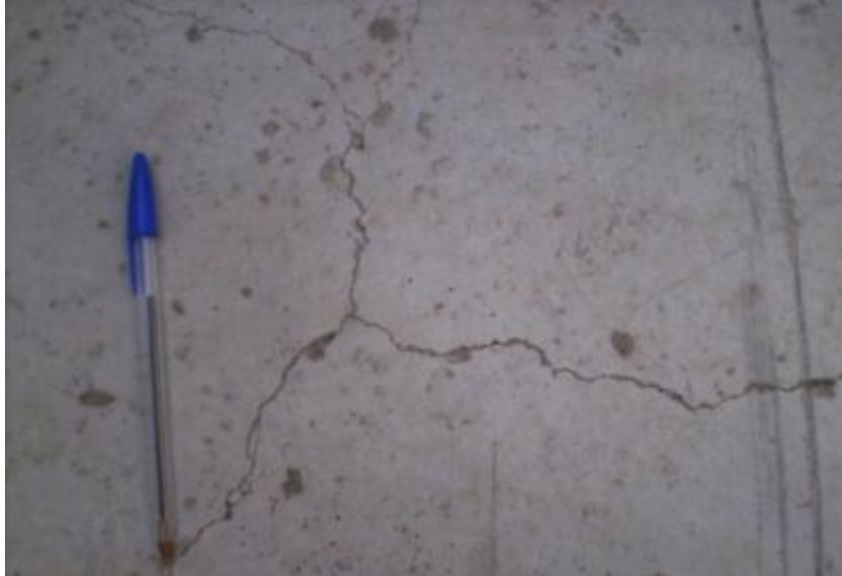
Figura 6.1. - Exemplo de fissuração no betão
