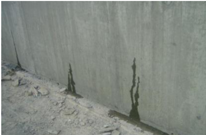
Figura 6.2. - Pormenor das escorrências provocadas pela fissuração no betão
