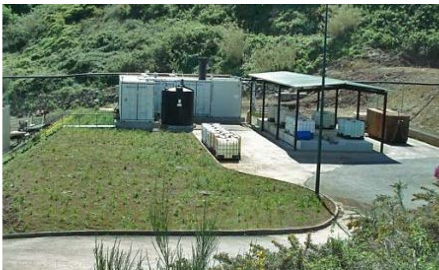
FIGURA 2.14 – ETAR – INSTALAÇÃO DE OSMOSE INVERSA, (VALOR AMBIENTE, (2013)).
