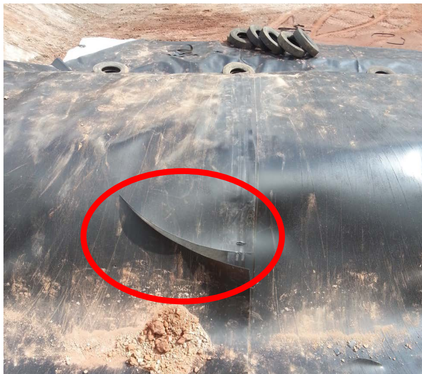
FIGURA 4.19 – DANO DETECTADO NA GEOMENBRANA, (ARQUIVO PESSOAL).
