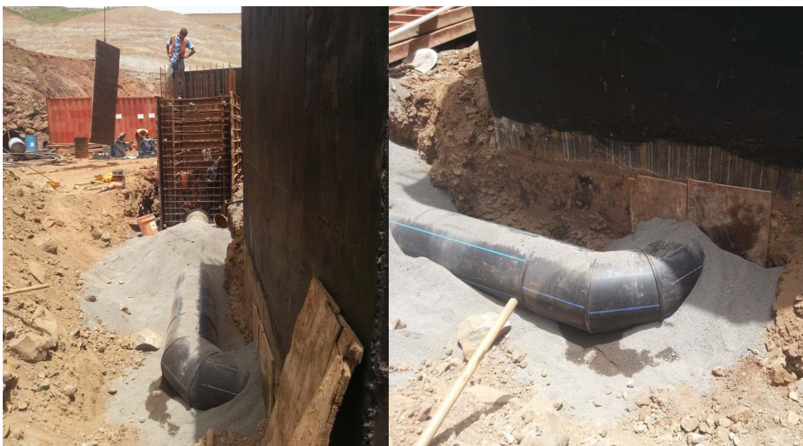
FIGURA 3.12 – LIGAÇÃO DO COLETOR DE DRENAGEM DE LIXIVIADOS AO POÇO DE DESCARGA, (ARQUIVO PESSOAL).
