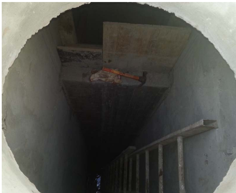
FIGURA 4.27 – CÂMARA DE VISITA DAS ÁGUAS PLUVIAIS (MURO DE DIVISÃO), (ARQUIVO PESSOAL).
