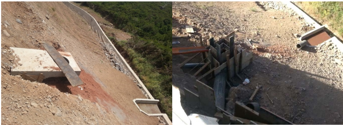
FIGURA 3.14 – LIGAÇÃO DA DESCARGA DE SUPERFÍCIE DO POÇO LIXIVIADOS À CAIXA DE VISITA DE ÁGUA PLUVIAIS, (ARQUIVO PESSOAL).
