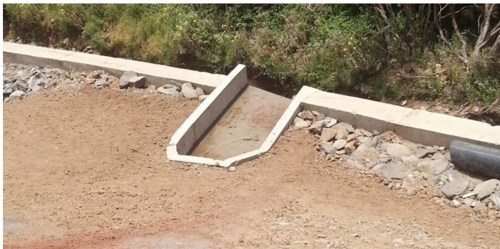
FIGURA 3.8 – BOCA DE LOBO PARA DISPERSÃO NO MEIO NATURAL, (ARQUIVO PESSOAL).
