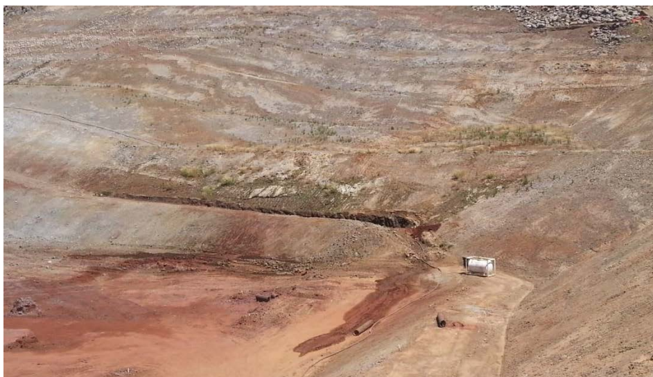
FIGURA 4.24 – TALUDES DA BASE DA CÉLULA A1 COM MAIOR INCIDÊNCIA DE NASCENTE EFLUENTES, (ARQUIVO PESSOAL).
