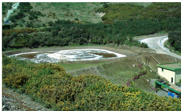
FIGURA 2.13 – ETAR/ETAL - LAGOA DE AREJAMENTO, (VALOR AMBIENTE, (2013)).
