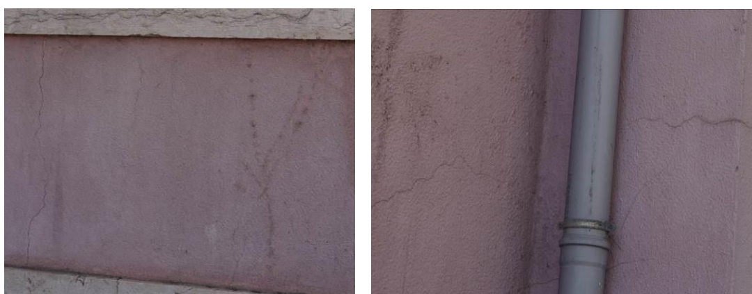
Figura 12: ALD_FIS_11 e ALD_FIS_12 (Fonte: Autor, 2016)
